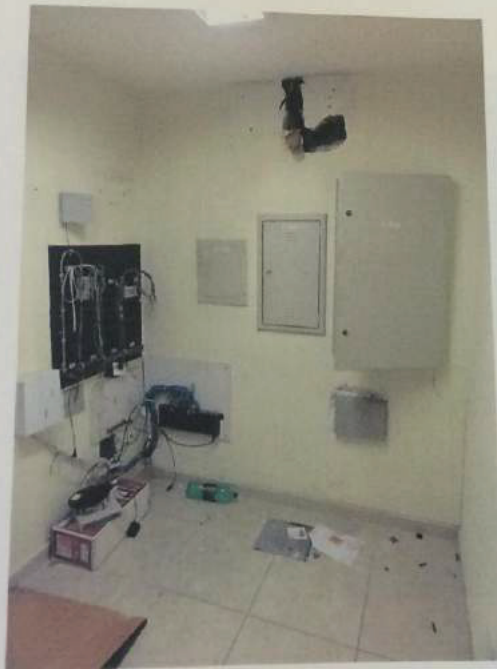
VISTA DA SALA DO SERVIDOR.
