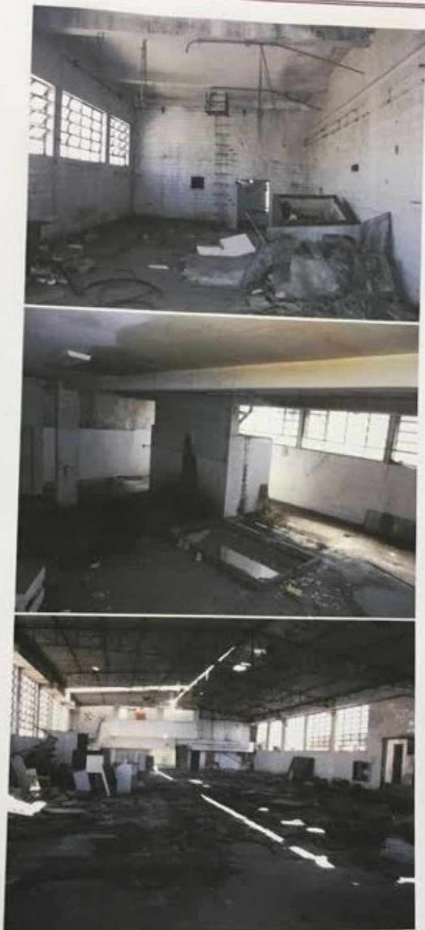
Fotos 15/17 – Vistas internas do imóvel, notando-se suas inúmeras patologias decorrentes da falta de manutenção.
