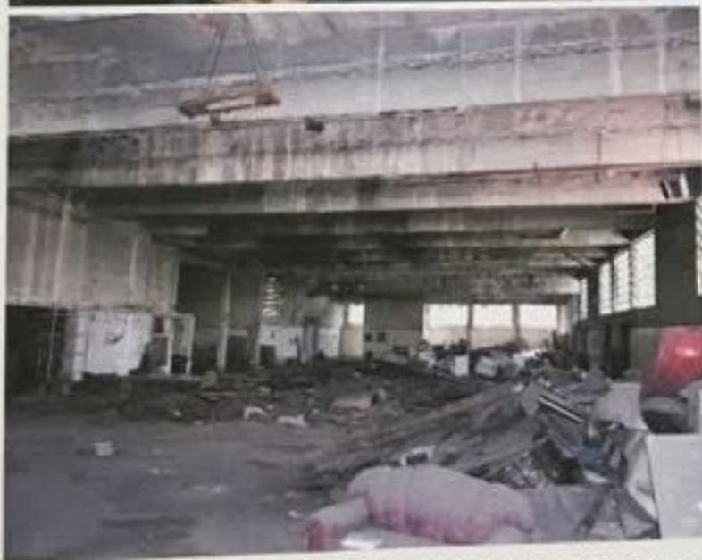
Fotos 12/14 - Outras vistas do imóvel, notando-se seu péssimo estado de conservação (edificação necessitando de reparos importantes a edificação sem valor).
