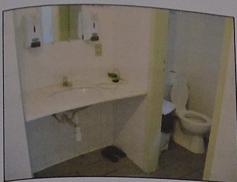
Foto 22: Banheiro do vestiário 02
