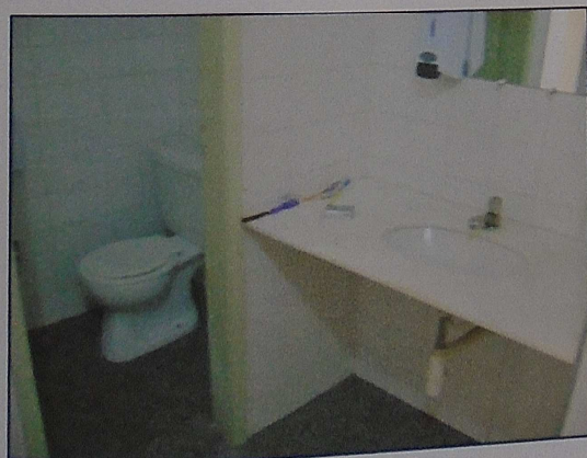
Foto 20: Banheiro do vestiário 01
