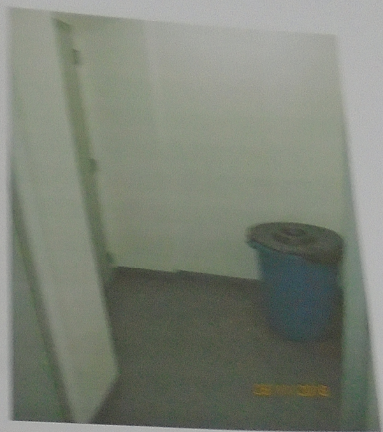
Foto 11) Vista da antecâmara de acesso a escada de uso comum, no 10º andar do edifício. Observar acabamento e portas corta-fogo.
