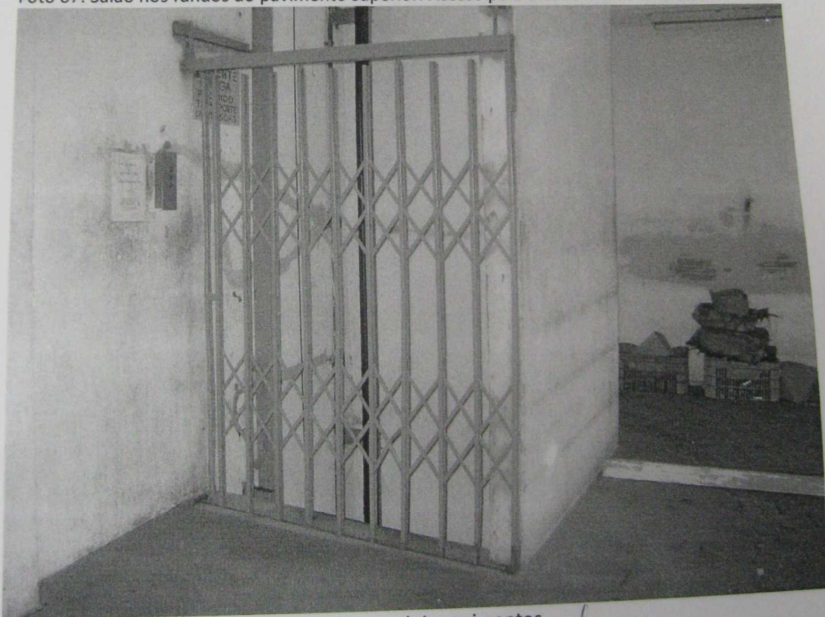
Foto 08: Elevador monta-cargas que liga os dois pavimentos.
