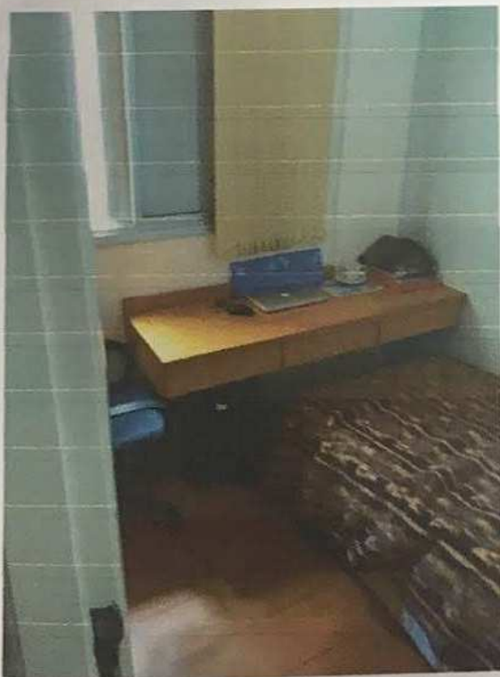
Foto 21) Vista do dormitório supra. Observar acabamento de piso e paredes e caixilho "de correr" em alumínio anodizado natural.
