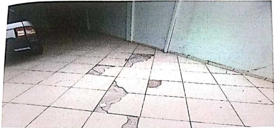
Foto 04 – Detalhe piso danificado garagem
