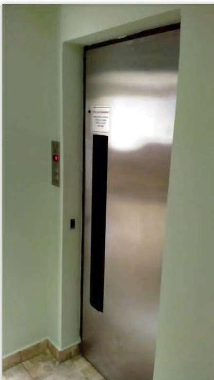
Foto 13 - Vista do elevador social na área comum do Edifício.
