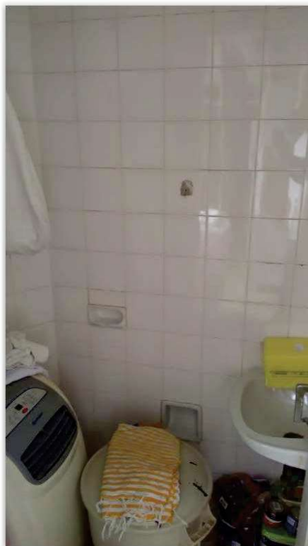
Foto 23 - Vista do banheiro de empregados do imóvel penhorado.
