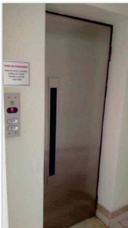
Foto 14 - Vista do elevador de serviços na área comum do Edifício.
