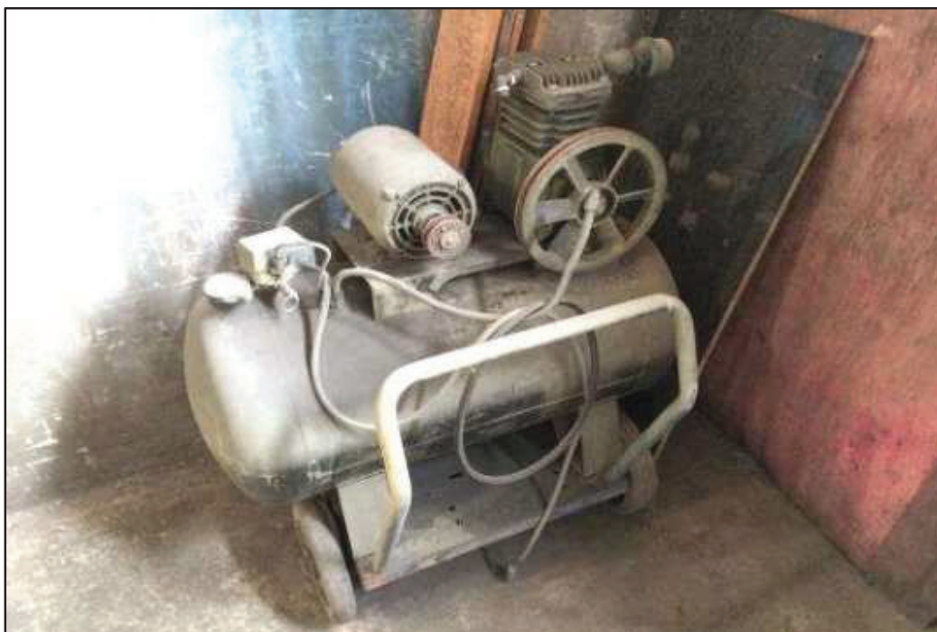
ITEM 1,009 - VISTA DO COMPRESSOR DE AR DIRETO MARCA: SCHULZ TIPO: TUFÃO
