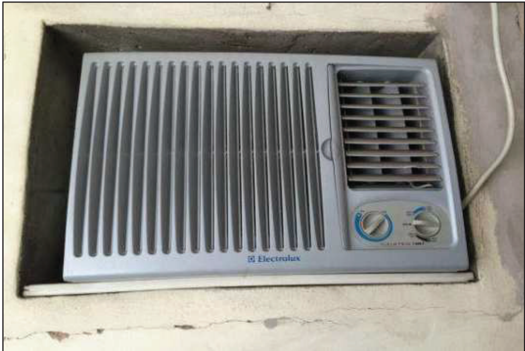
ITEM 2,023 - VISTA DO CONDICIONADOR DE AR MARCA: ELETROLUX MODELO: 7500 F VOLT: 220V
