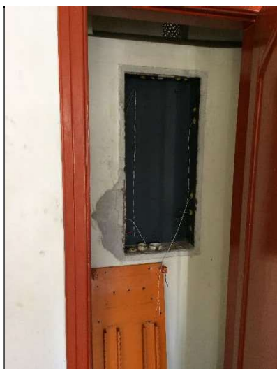
Quadro de elétrica desativado
