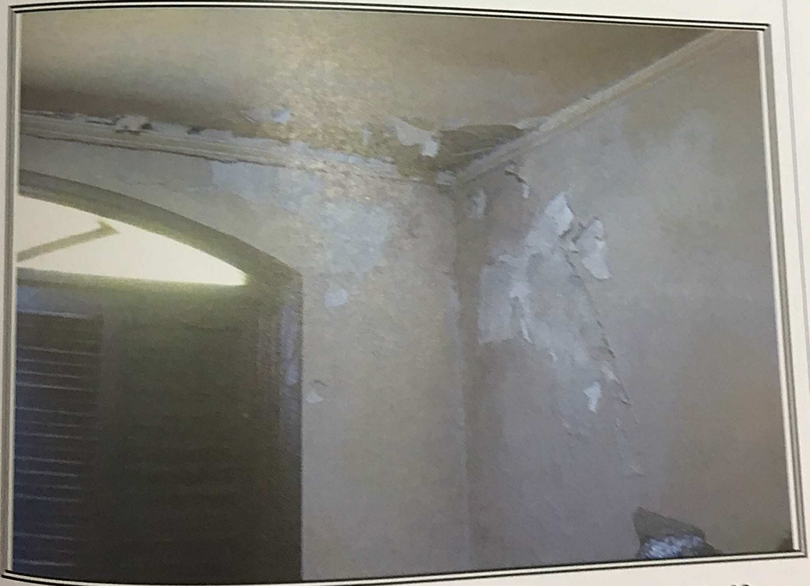
Foto n° 11: Detalhe de infiltração de água pluvial no dormitório 02, oriunda, possivelmente, do telhado do imóvel
