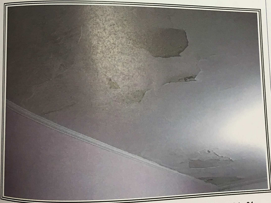
Foto nº 09: Detalhe de infiltração de água pluvial no dormitório 01, oriunda, possivelmente, do telhado do imóvel
