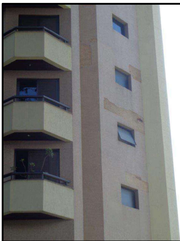
Foto 3: Parte danificada da fachada
