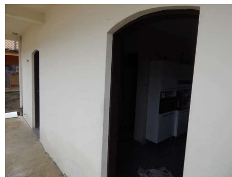
39 - DSCN2250.JPG Casa 2 - Entrada da cozinha.
