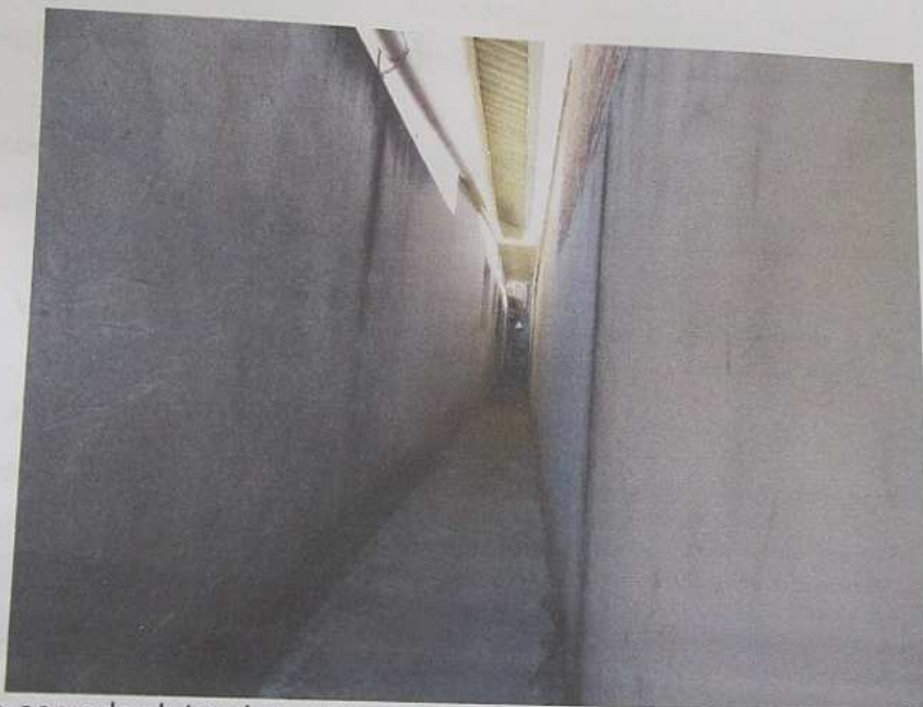
Vista do corredor lateral que fornece acesso para a edificação que fica nos fundos do nº 108.
