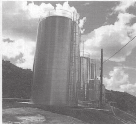
Reservatórios em aço inox e filtro
