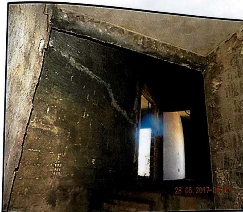
Vistas internas do imóvel com infiltrações, corrosão e trincas
