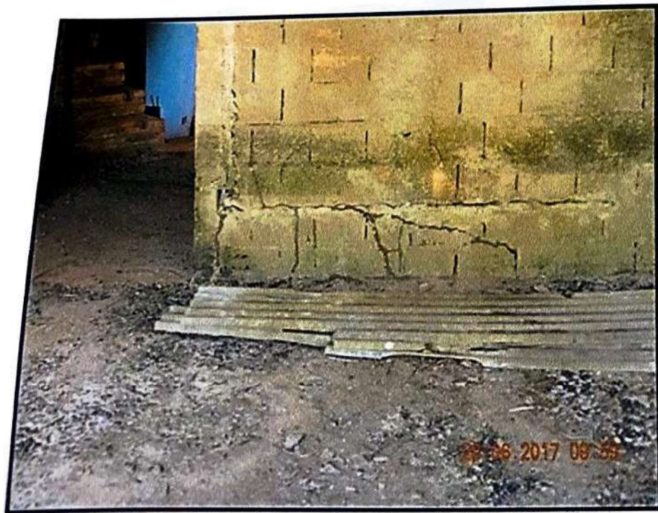
Vista do subsolo com trincas, etapas inacabadas e infiltrações
