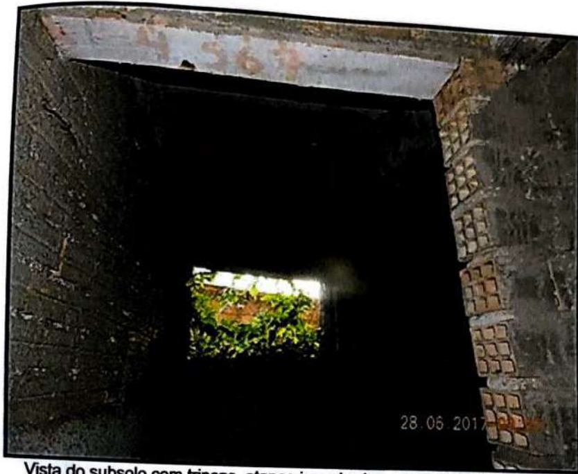
Vista do subsolo com trincas, etapas inacabadas, corrosão e infiltrações
