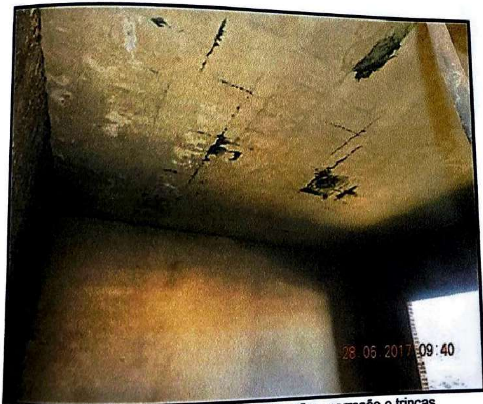
Vistas internas do imóvel com infiltrações, corrosão e trincas
