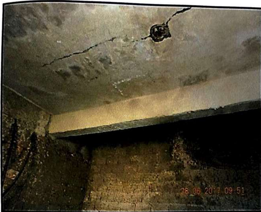
Vista do subsolo com trincas, etapas inacabadas e infiltrações
