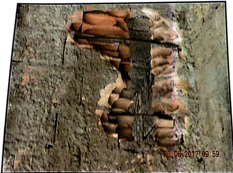
Vista do subsolo com etapas inacabadas e desconformidades
