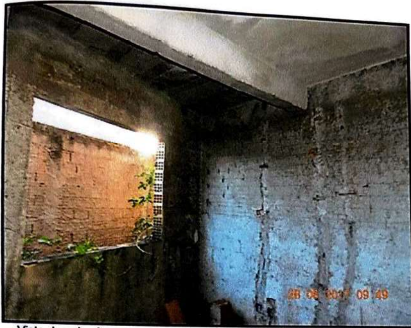
Vista do subsolo com trincas, etapas inacabadas, corrosão e infiltrações
