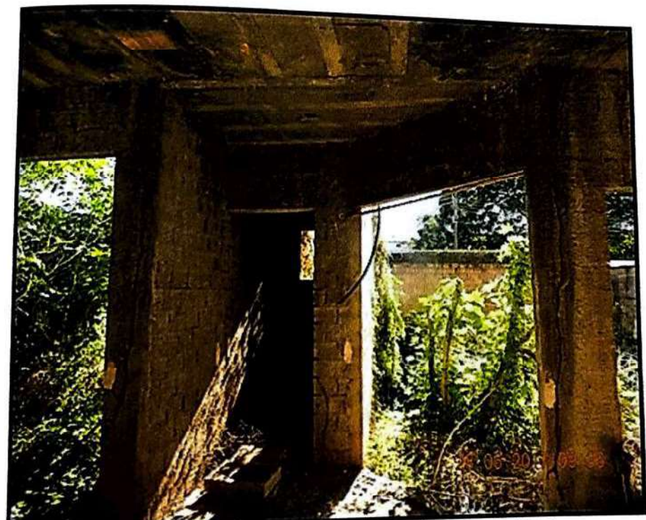
Vistas internas do imóvel com infiltrações e rachaduras
