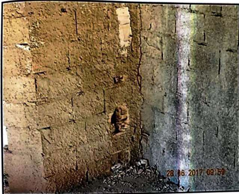
Vista do subsolo com trincas, etapas inacabadas e trioncas
