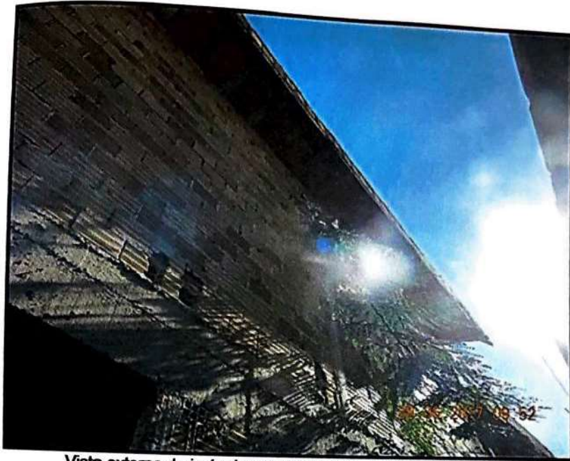
Vista externa do imóvel com etapas inacabadas e infiltrações
