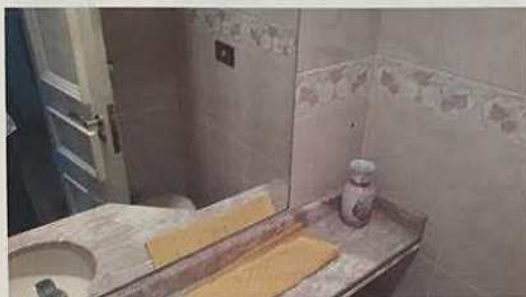
FOTO N° 03 Vista parcial Lavabo
