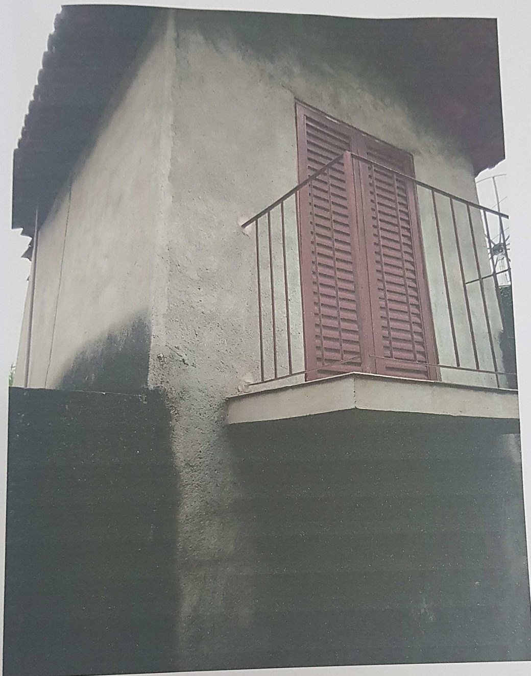
Foto 10: Vista do pavimento superior da casa existente na porção frontal do imóvel ora avaliando.
