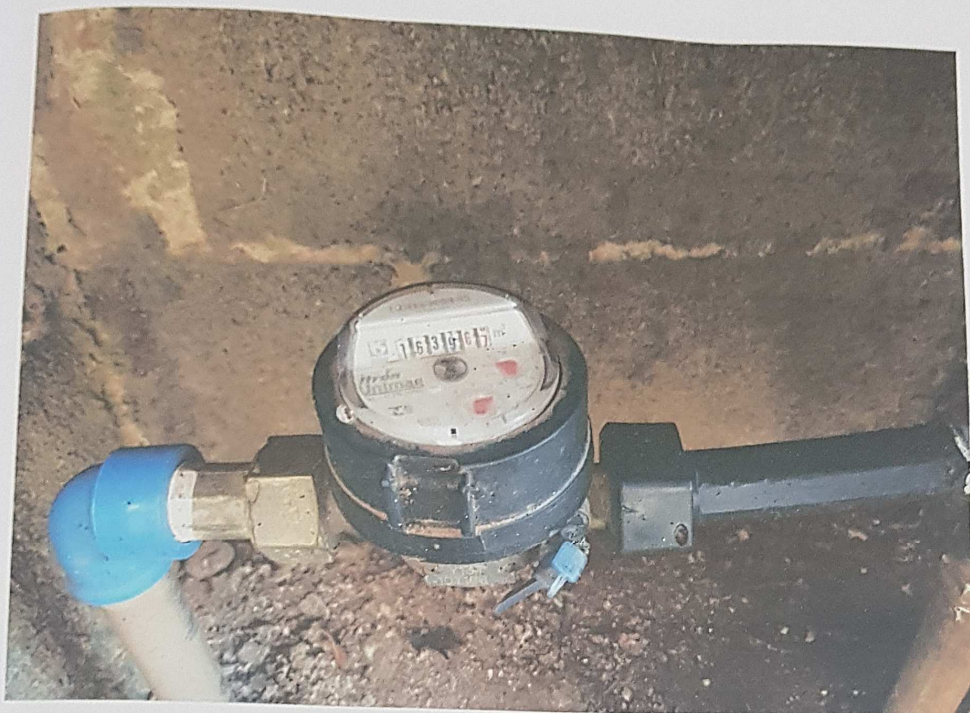
Foto 5: Medidor de água do imóvel ora avaliando.
