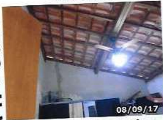
Vista parcial de telhado sem forro cômodo do fundo
