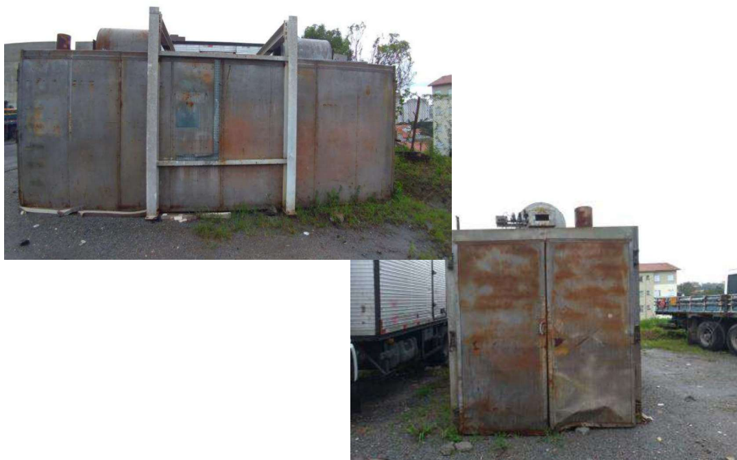
FOTO 19 – Cabine de Pintura – Vista lateral e frontal
