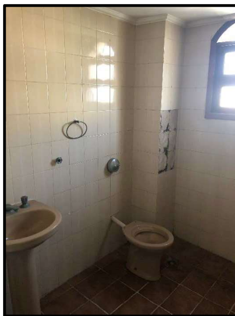
Foto 9 – “EDIFÍCIO FENÍCIA” – Apartamento 68 – Banheiro 1
