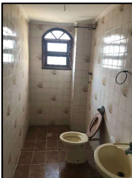
Foto 11 – “EDIFÍCIO FENÍCIA” – Apartamento 68 – Banheiro 2 (Suíte)
