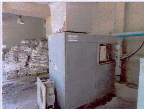
Compressor de ar.
