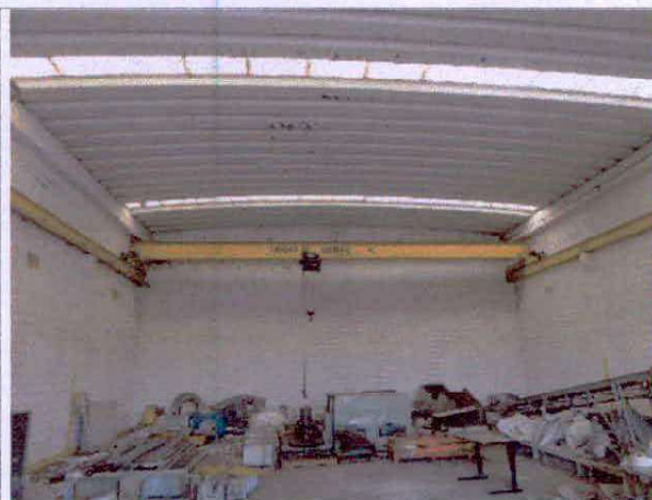
Ponte rolante 4 ton.
