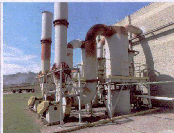
Sistema lavador de gases.
