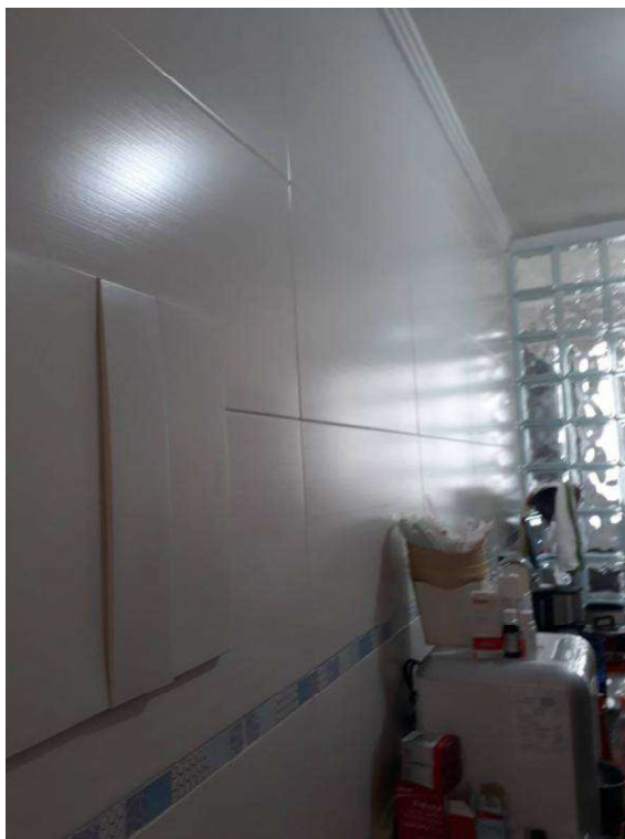
Detalhe da parede em porcelanato com detalhes em azul e caixa de disjuntores
