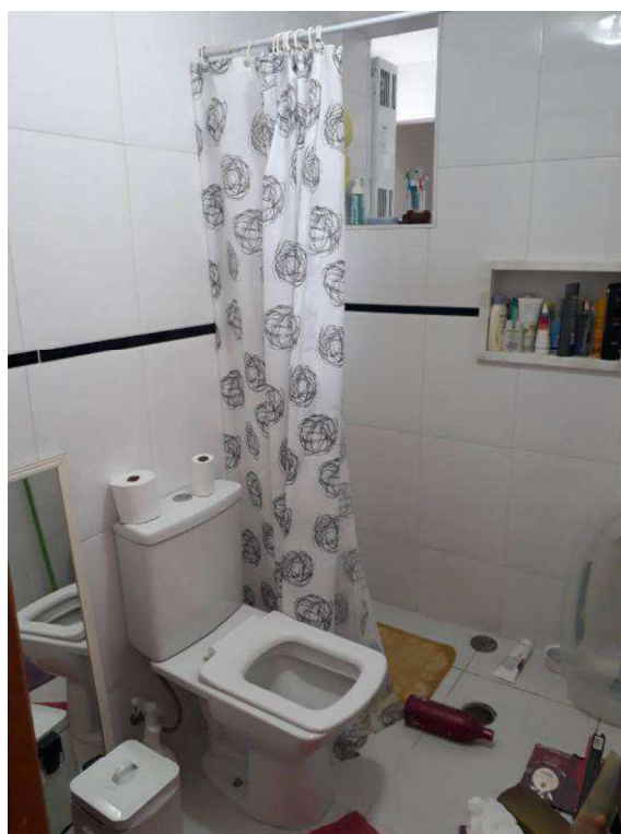
Vista do lavabo com pisos e paredes em porcelanato sem anomalias e novos, o banheiro encontra-se inacabado sem pia lavatória e sem janela (lavanderia/banheiro)
