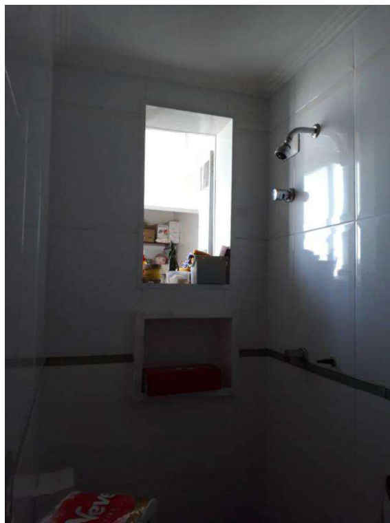
Banheiro suíte com revestimento novo, sem janela entre lavanderia/banheiro, chuveiro encontra-se sem o registro e foi informado que não é utilizado pela proprietária
