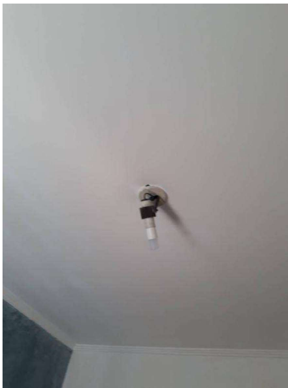
Paredes e teto do segundo dormitório seguem o padrão do resto do apartamento com falta de acabamento e necessidade de pintura.
