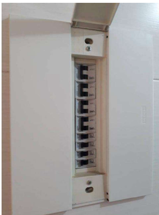
Caixa de disjuntores nova – realizada durante reforma da proprietária
