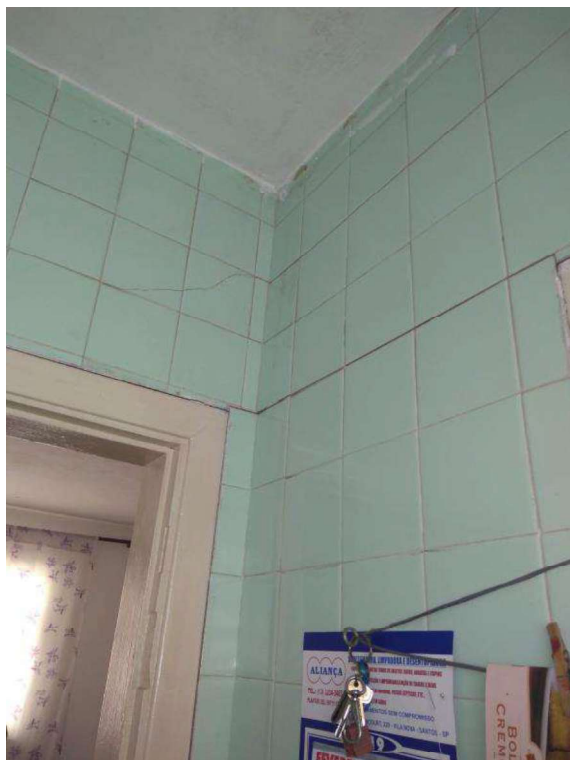
FOTO Nº 12 - Vista das trincas no revestimento cerâmico da cozinha.
