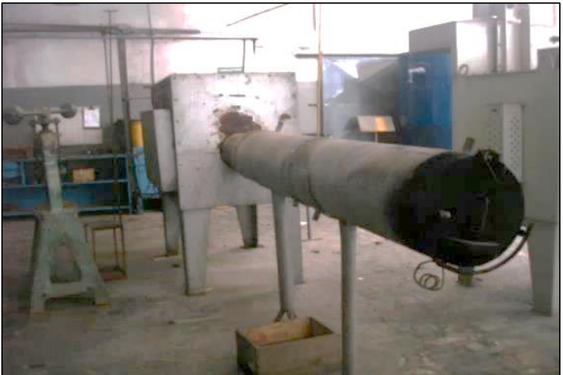
ITEM 1,002 - VISTA DO FORNO PARA SINTERIZAÇÃO
