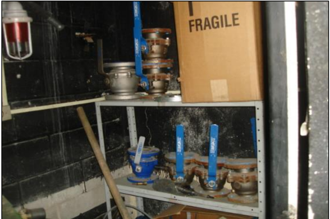
ITEM 5,347 - VISTA DA VÁLVULA ESFÉRICA
