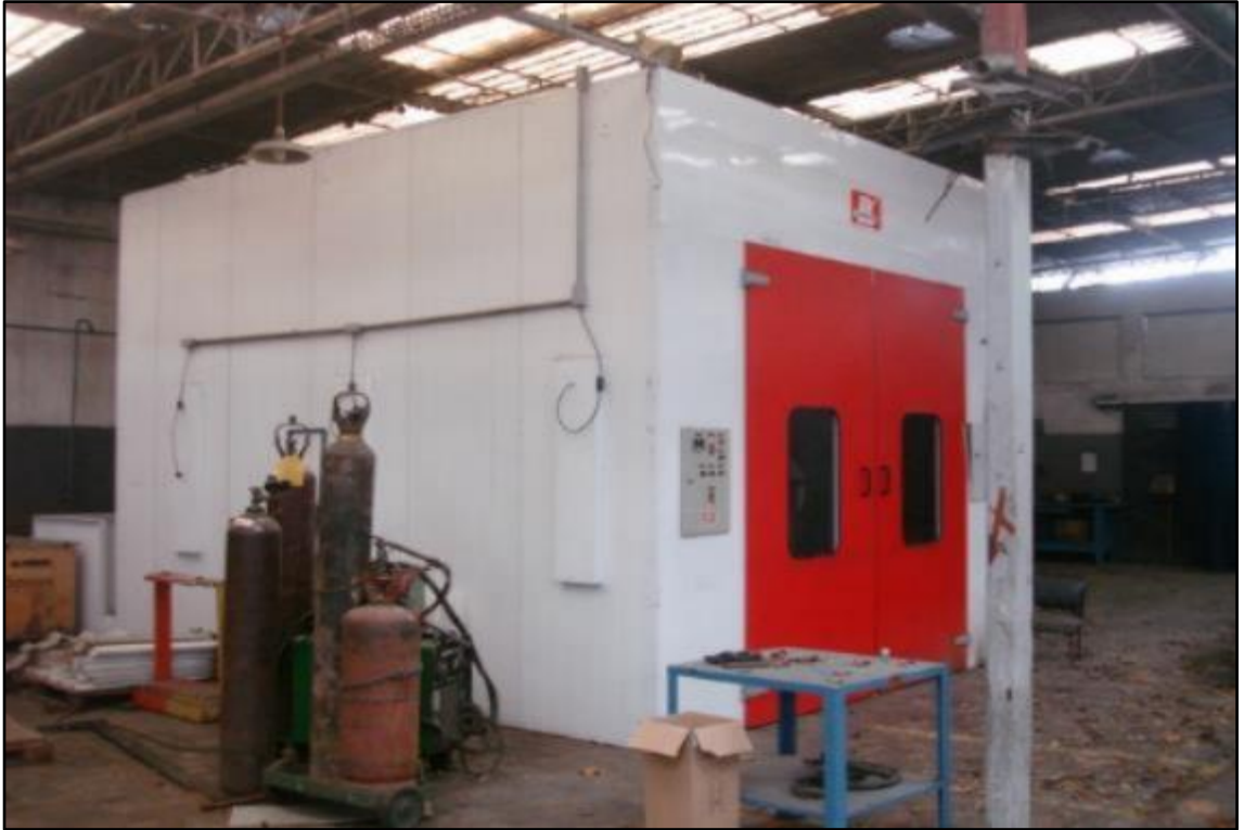
ITEM 1,003 - VISTA DO CABINE DE PINTURA COM EXAUSTOR MARCA: COMPATIQ
