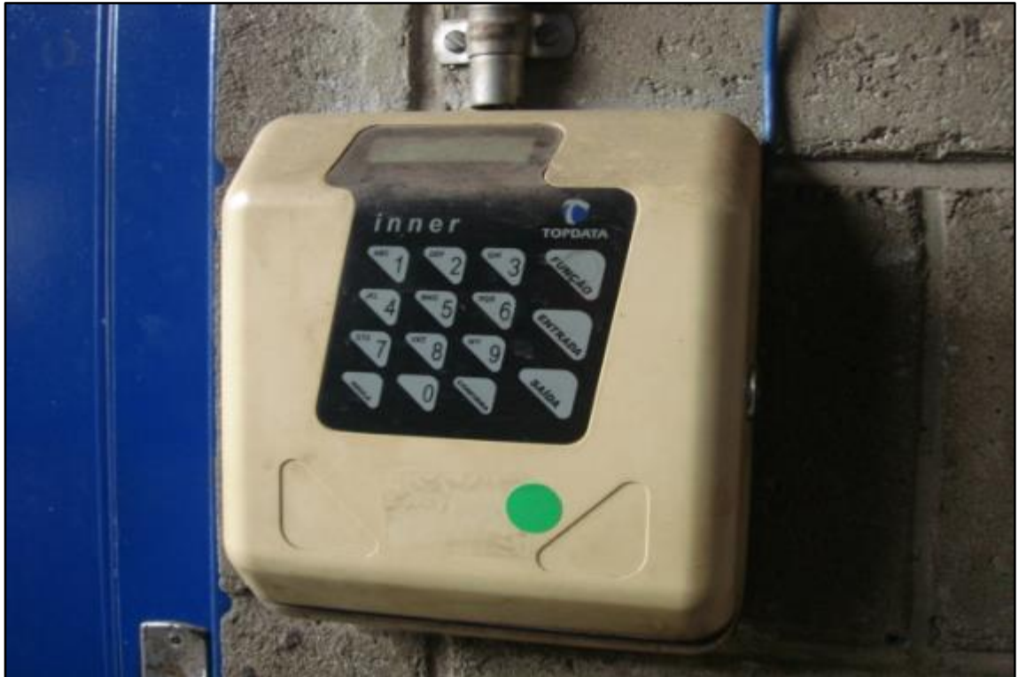
ITEM 5,005 - VISTA DO RELÓGIO DE PONTO MARCA: TOP DATA MODELO: INNER REP BARRAS 21
