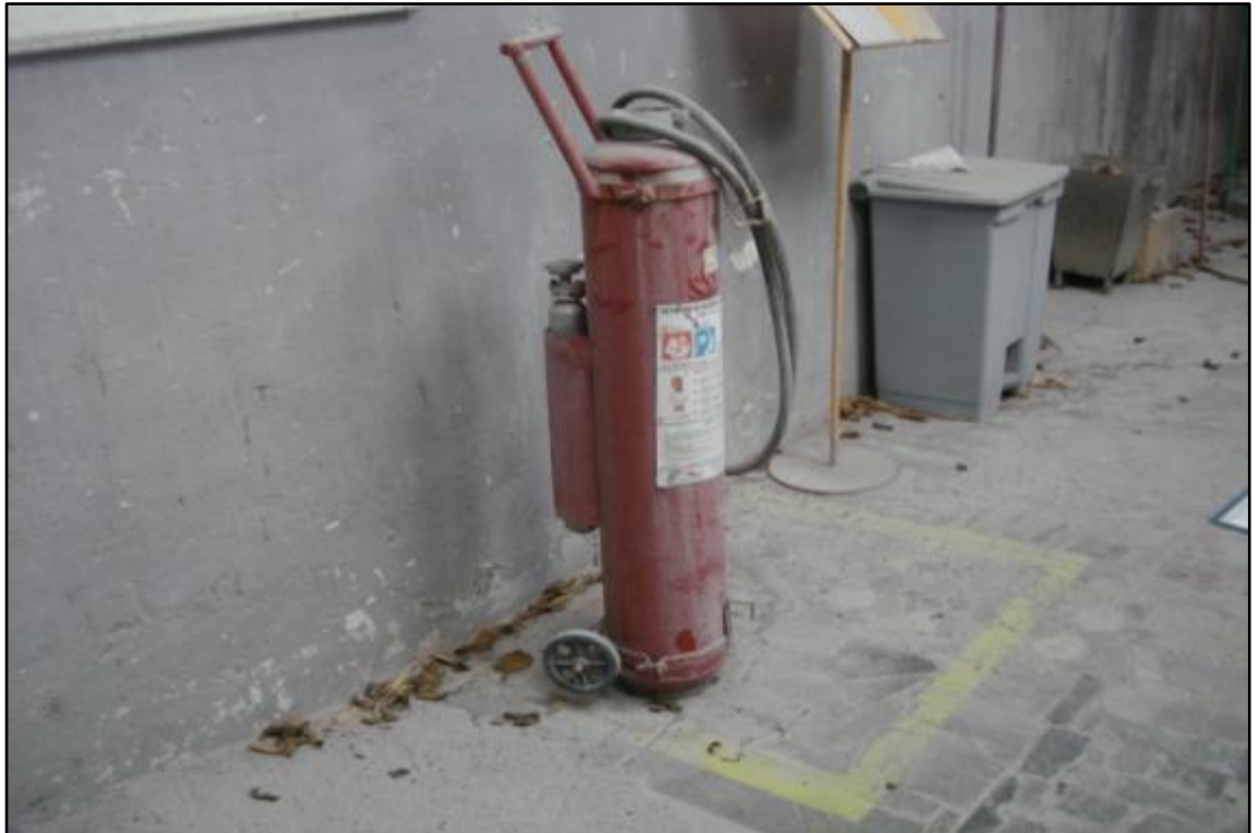
ITEM 5,009 - VISTA DO EXTINTOR
