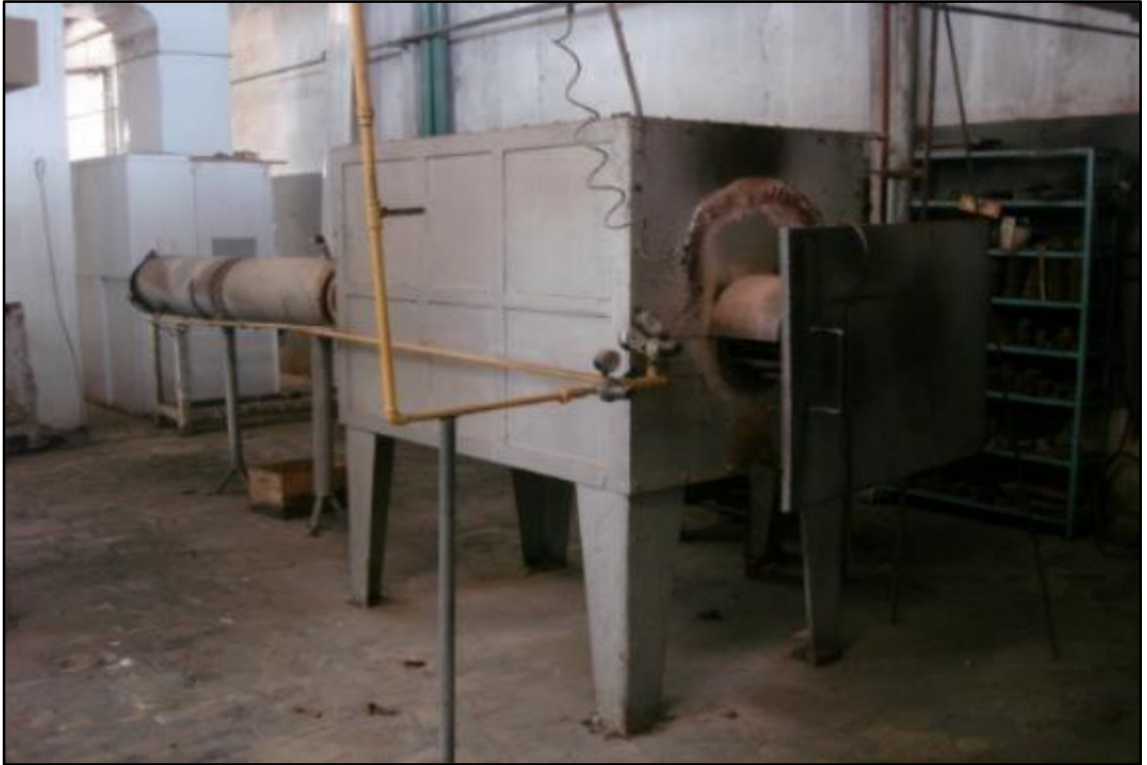
ITEM 1,002 - VISTA DO FORNO PARA SINTERIZAÇÃO
