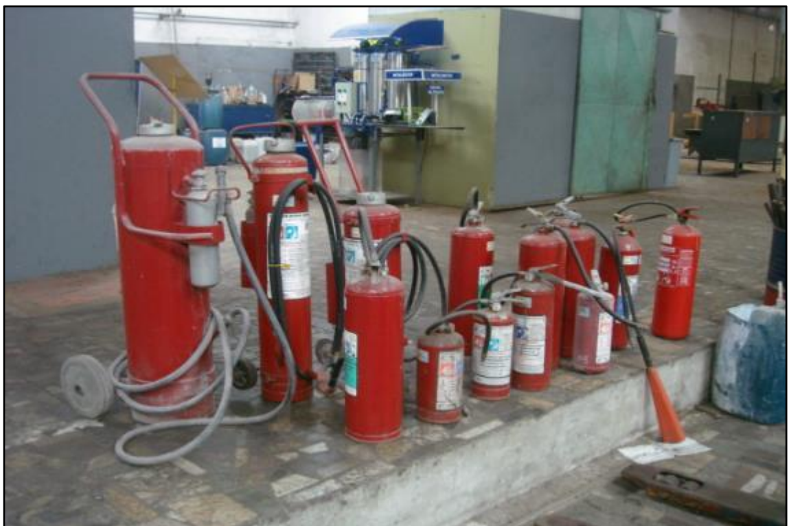
ITEM 5,008 - VISTA DOS EXTINTORES
