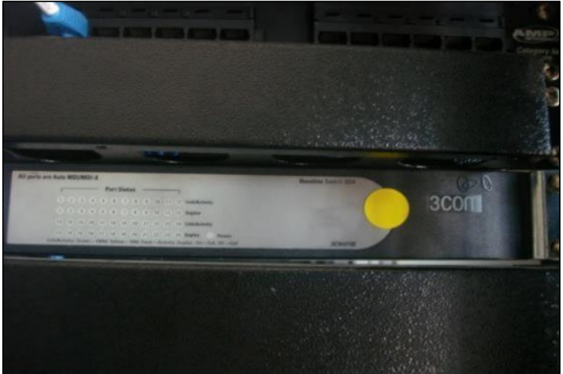
ITEM 3,069 - VISTA DO SWITCH MARCA: 3COM MODELO: BASELINE SWITCH 2024
