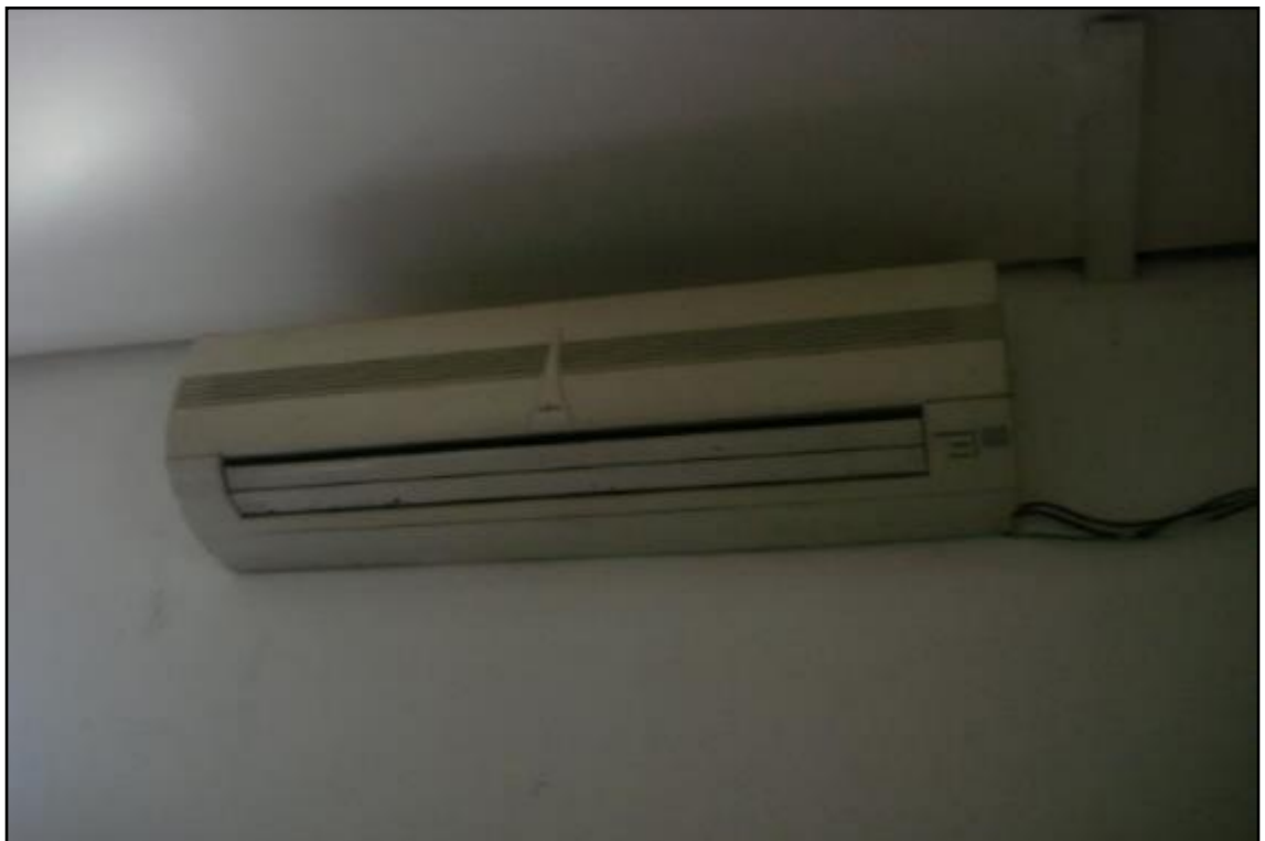
ITEM 2,101 - VISTA DO AR CONDICIONADO MARCA: FUJITSU
