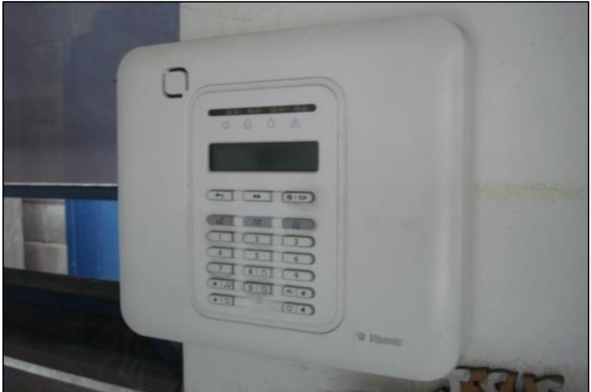
ITEM 5,335 - VISTA DO SISTEMA DE SEGURANÇA MARCA: VISIONIC
