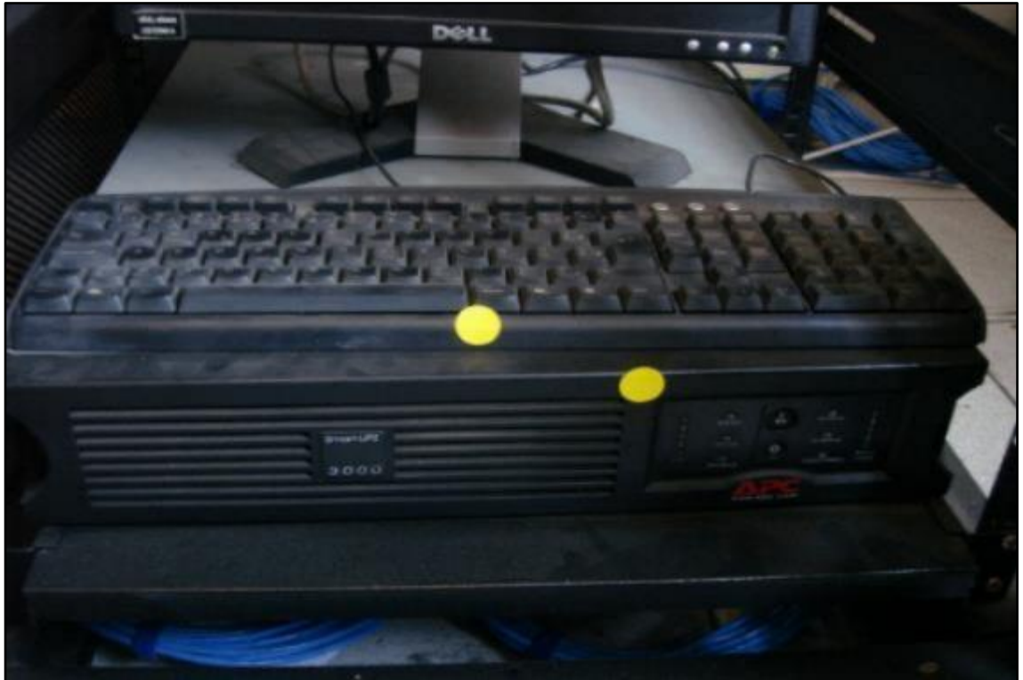
ITEM 3,062 - VISTA DO NO BREAK MARCA: APC MODELO: UPS3000
