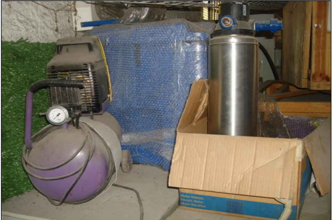
ITEM 1,096 - VISTA DO COMPRESSOR PORTÁTIL DE AR
