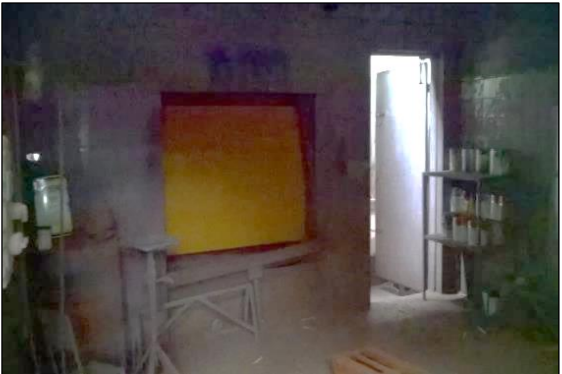
ITEM 1,071 - VISTA DA CABINE DE PINTURA CORTINA D'AGUA
