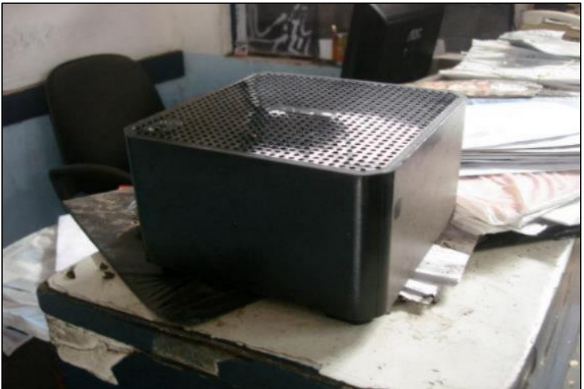
ITEM 3,052 - VISTA DO NOBREAK MARCA: APC
