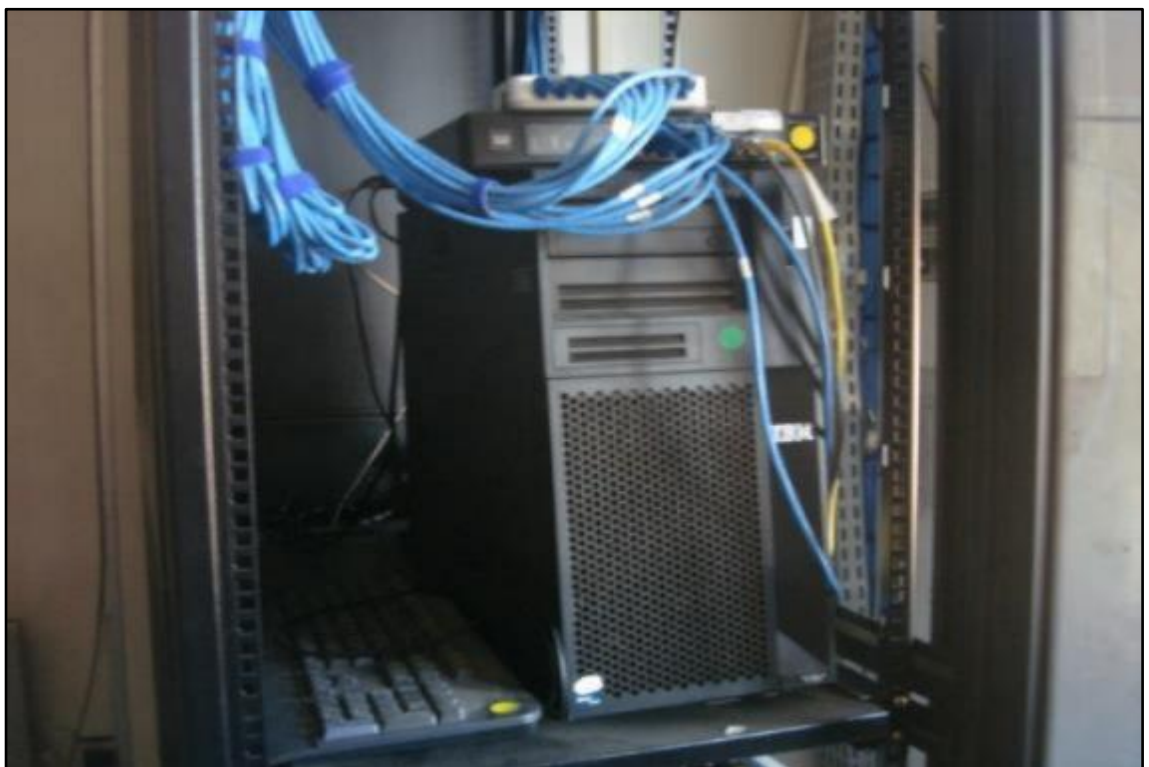
ITEM 3,011 - VISTA DO SERVIDOR MARCA: IBM MODELO: SYSTEM X3200M2
