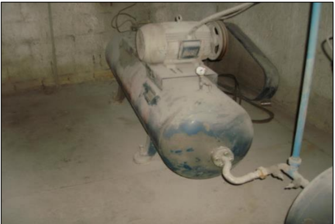
ITEM 1,056 - VISTA DO COMPRESSOR DE AR COMPRIMIDO CAP: 250L MARCA: WAYNE
