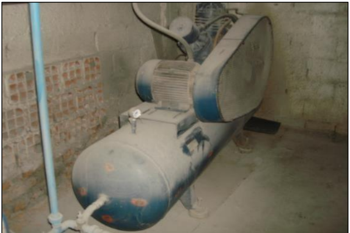
ITEM 1,055 - VISTA DO COMPRESSOR DE AR COMPRIMIDO CAP: 250L MARCA: WAYNE
