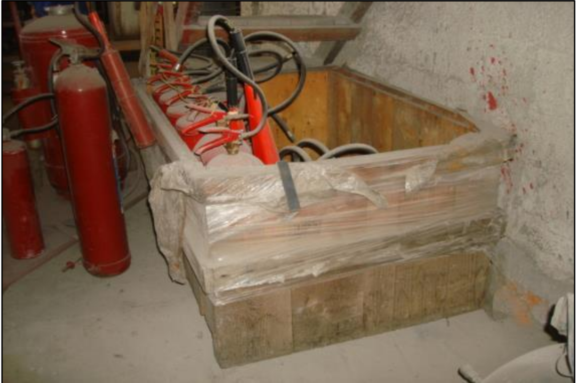
ITEM 5,011 AO 5,013 - VISTA DO EXTINTOR CLASSE 2A, DO EXTINTOR PÓ QUÍMICO E DO EXTINTOR CO2
