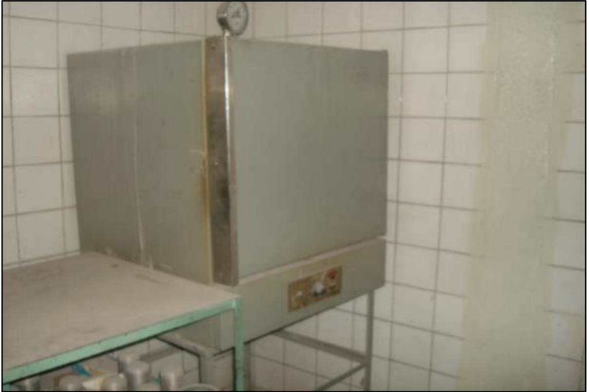
ITEM 1,023 - VISTA DA ESTUFA INDUSTRIAL MARCA: FABBE
