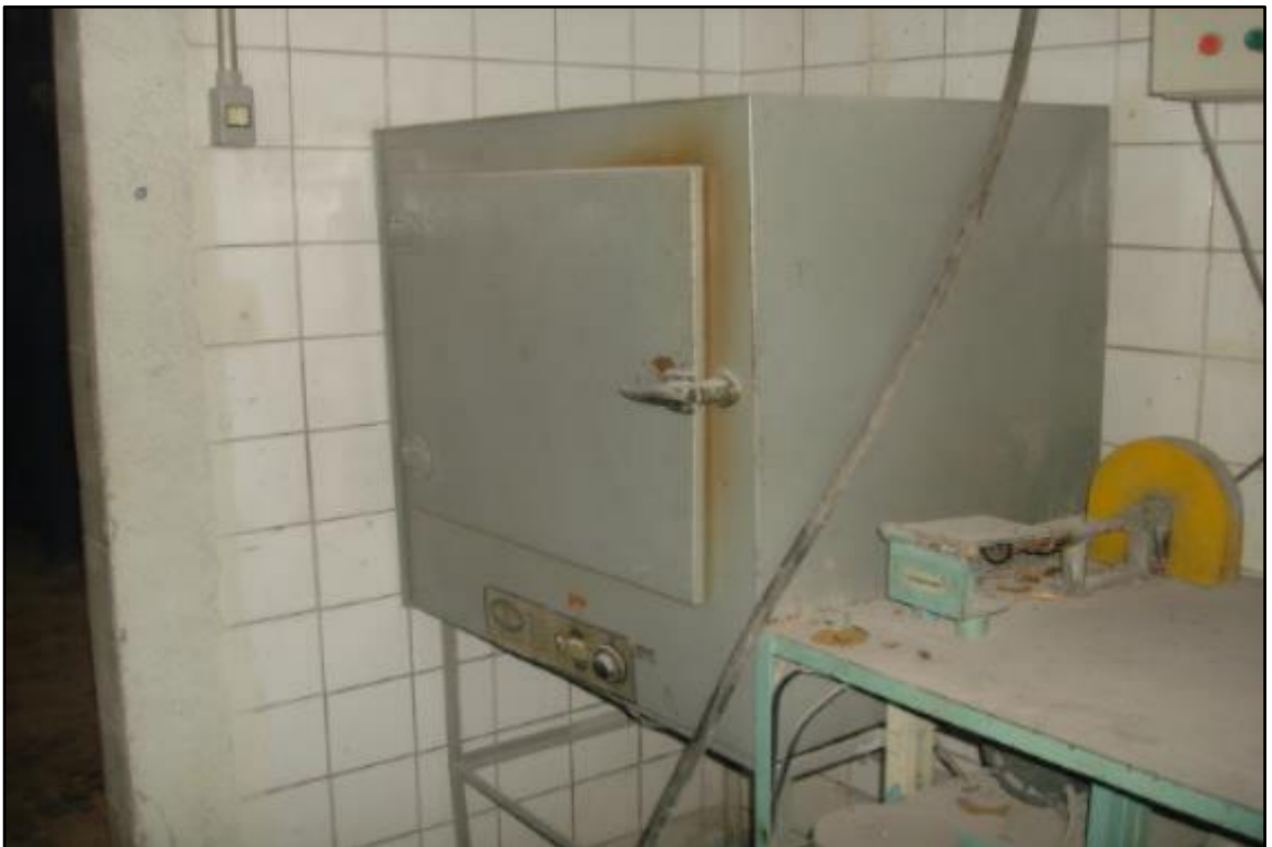
ITEM 1,024 - VISTA DA ESTUFA INDUSTRIAL MARCA: LUTZ FERRANDO
