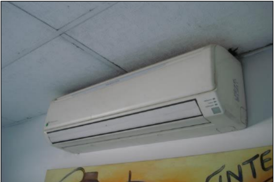
ITEM 2,114 - VISTA DO AR CONDICIONADO MARCA: FUJITSU
