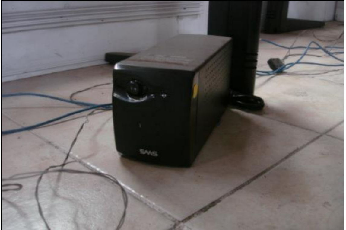
ITEM 3,080 - VISTA DO ESTABILIZADOR MARCA: SMS
