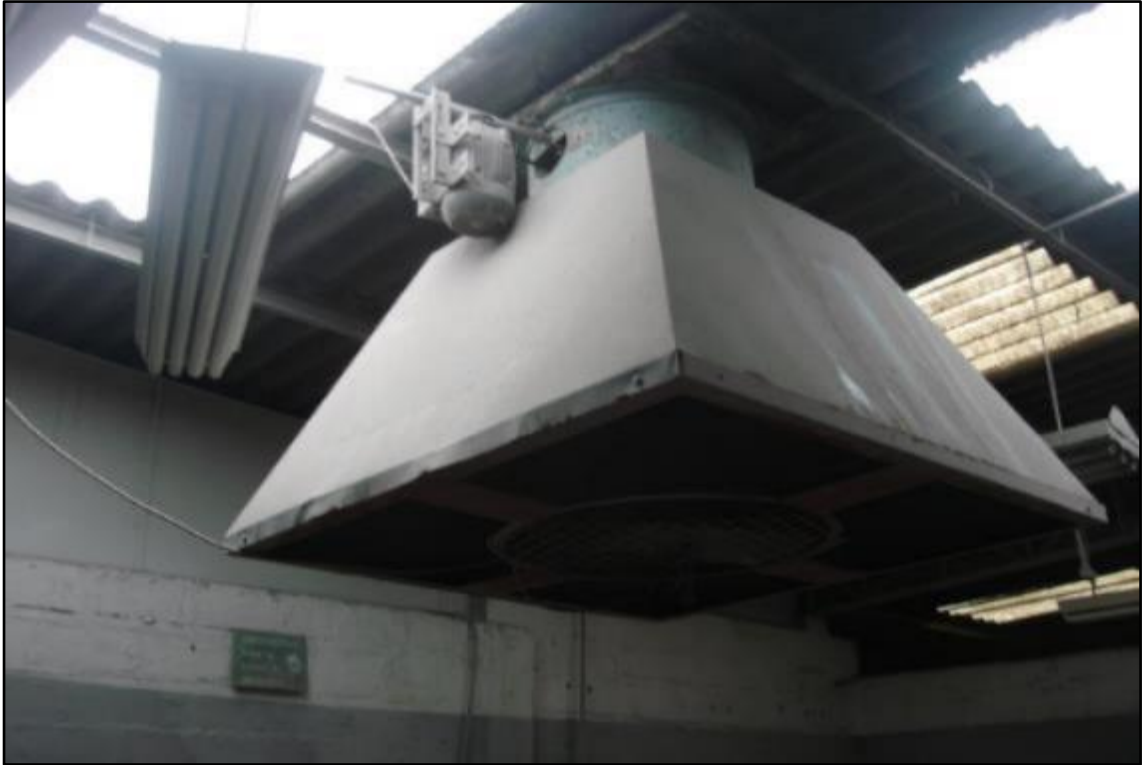
ITEM 1,095 - VISTA DO EXAUSTOR
