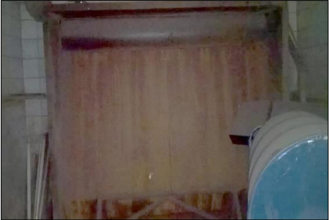
ITEM 1,072 - VISTA DA CABINE DE PINTURA CORTINA D'AGUA COM TORRE DE EXAUSTÃO
