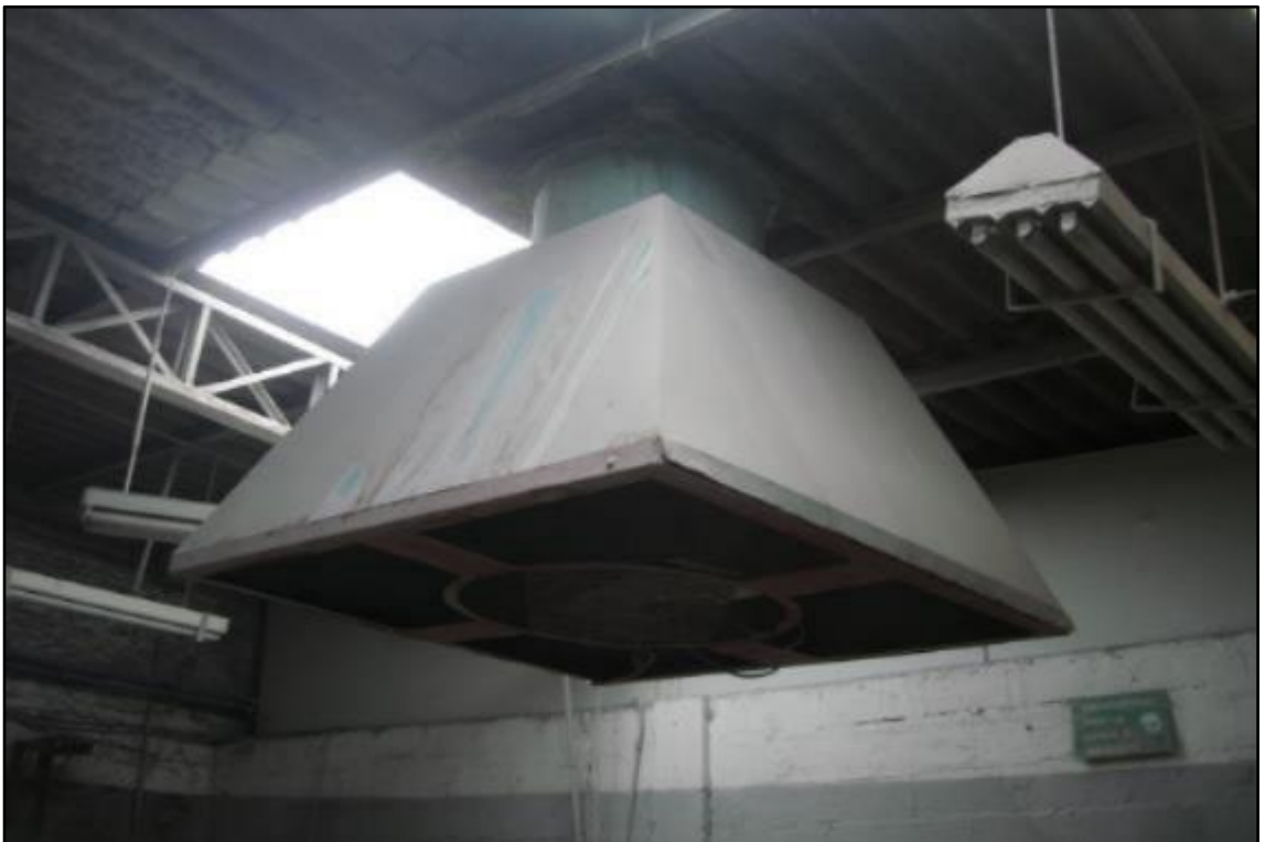
ITEM 1,095 - VISTA DO EXAUSTOR
