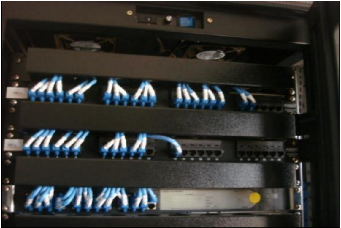
ITEM 3,070 - VISTA DO PATCH PAINEL 24 PORTAS MARCA: NETCONNECT MODELO: CATEGORY 5E
