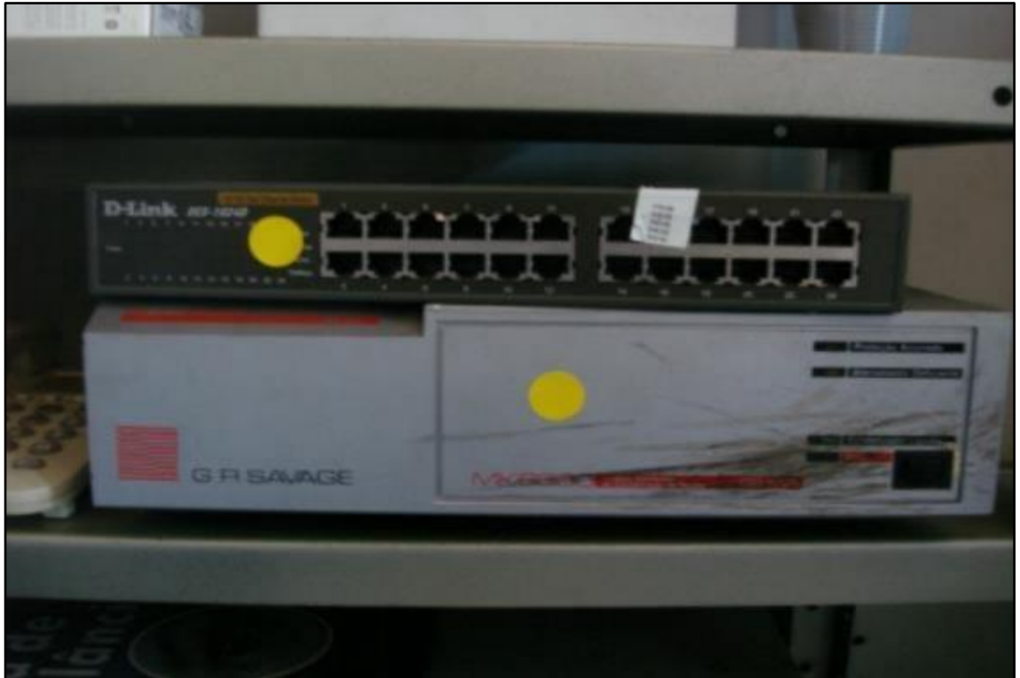
ITEM 3,072 E 3,073 - VISTA DO SWITCH 24 PORTAS MARCA: DLINK MODELO: DES1024P E DO ESTABILIZADOR DE TENSÃO MARCA: GR SAVAGE MODELO: MK600
