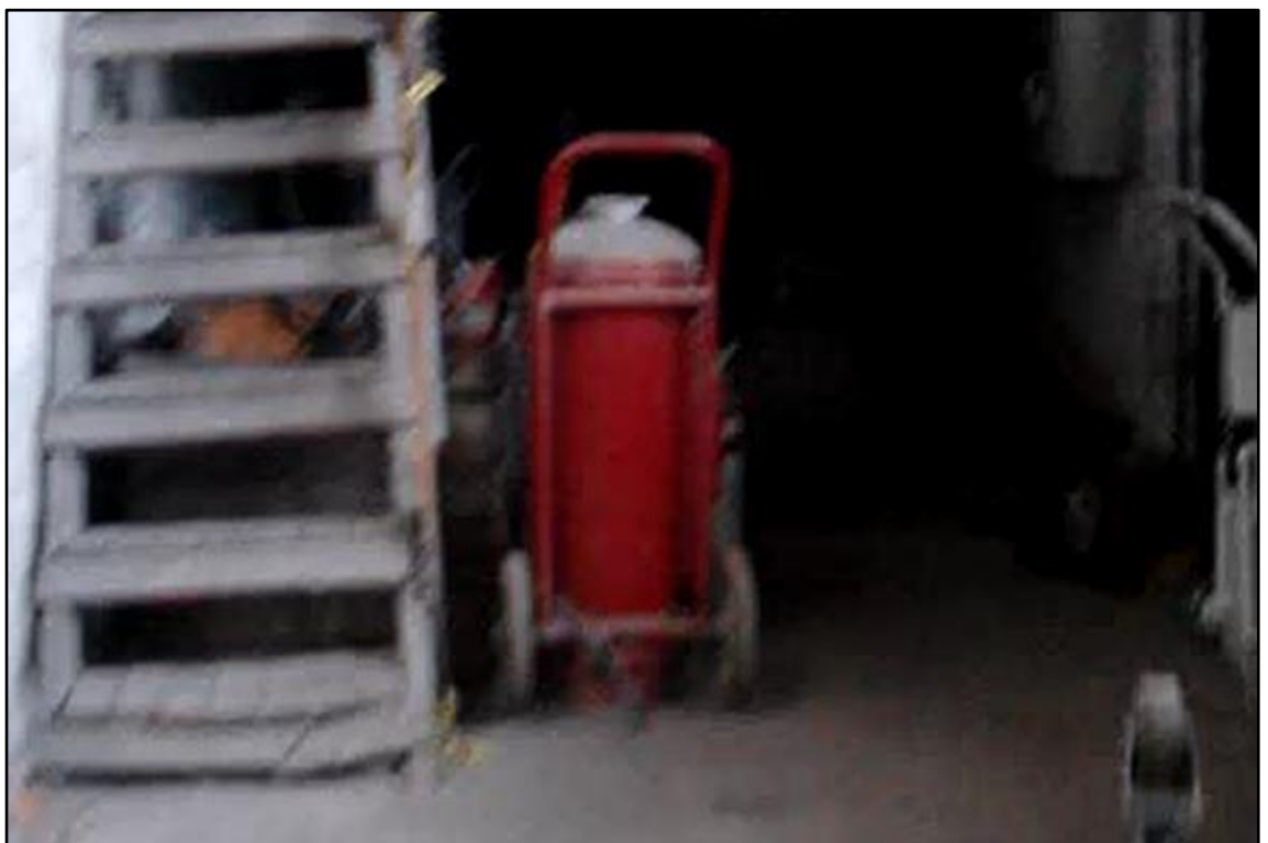
ITEM 5,010 - VISTA DO EXTINTOR AGUA 75 L
