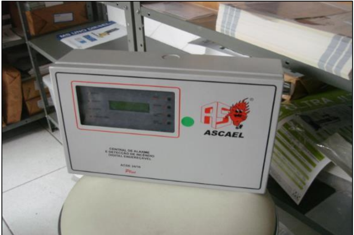
ITEM 5,001 - VISTA DA CENTRAL DE ALARME DIGITAL ENDEREÇÁVEL MARCA: ASCAEL MODELO: ACDE 24/16 PLUS
