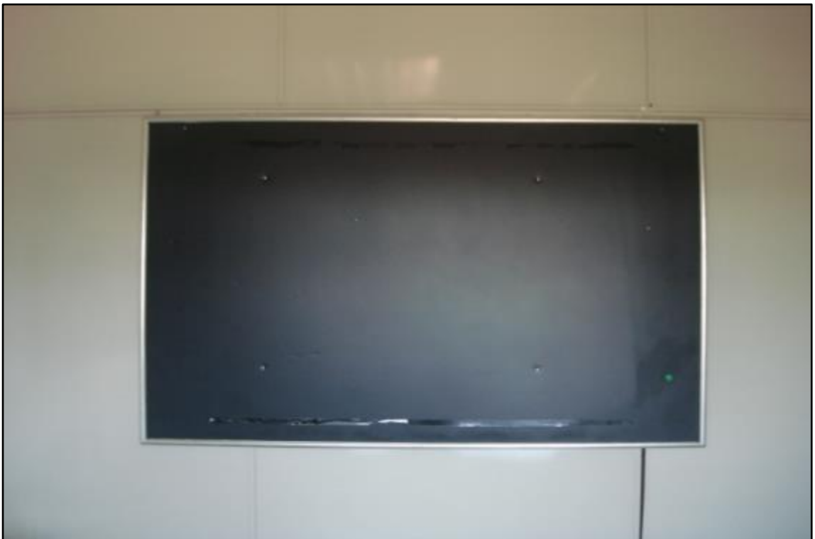
ITEM 5,017 - VISTA DO QUADRO DE AVISO DIM: 145X95 CM
