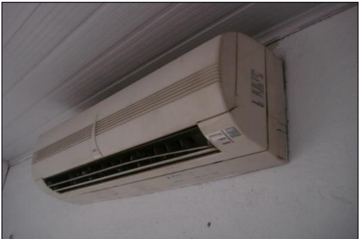
ITEM 2,239 - VISTA DO AR CONDICIONADO MARCA: MOMECO
