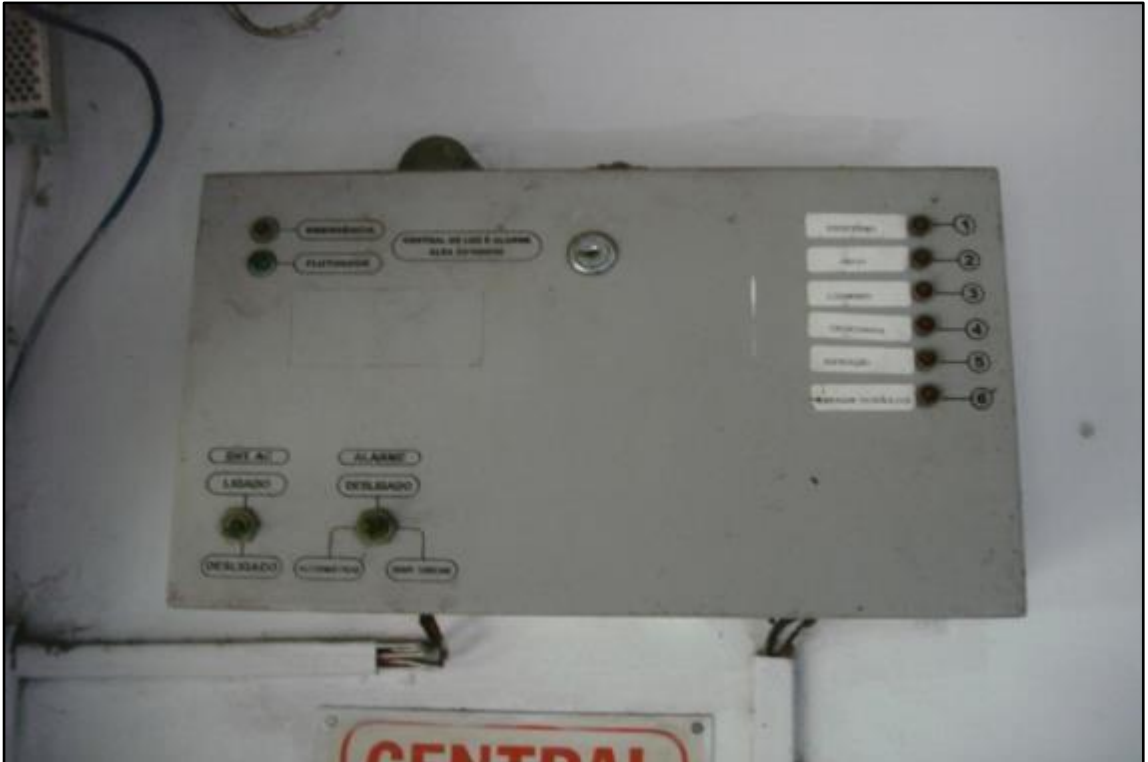
ITEM 5,014 - VISTA DA CENTRAL DE LUZ E ALARME MARCA: ASCAEL MODELO: ALEA 24/1000/06
