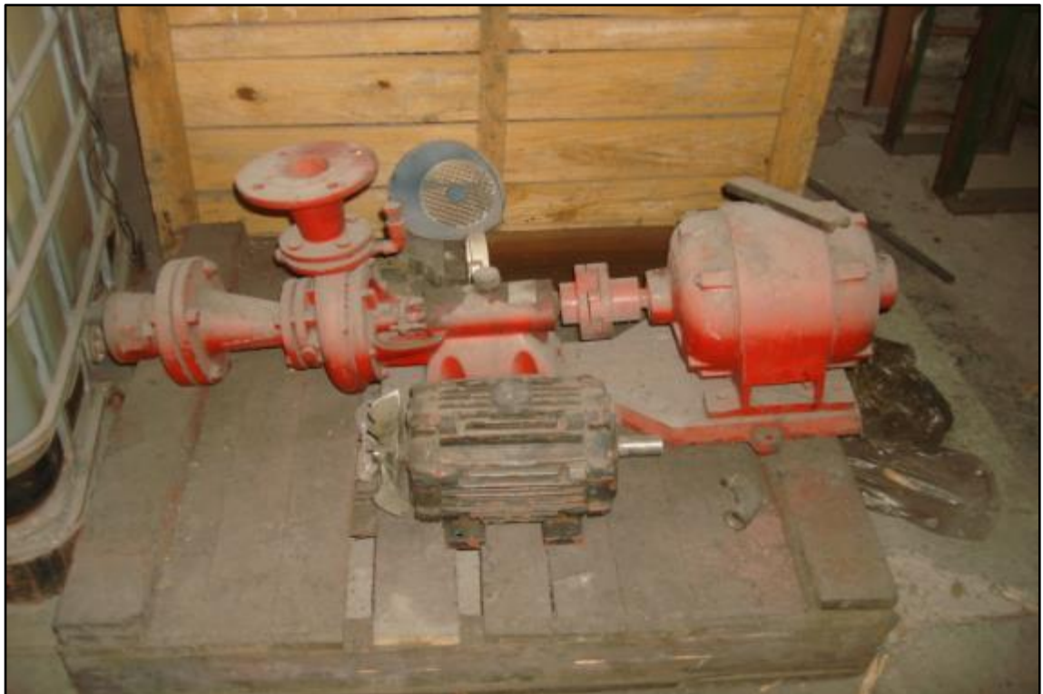
ITEM 5,365 - VISTA DA BOMBA PARA INCÊNDIO 40X80 MARCA: MANZOLI
