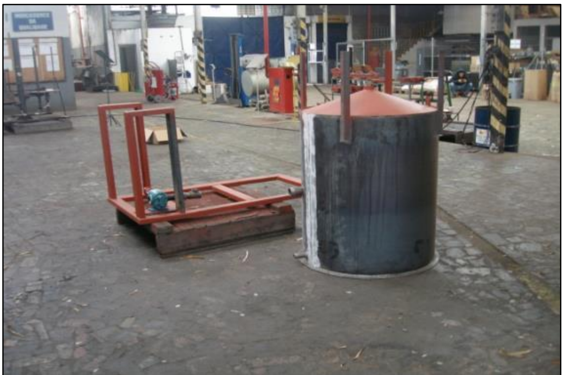
ITEM 5,356 - VISTA DO TANQUE E ESTRUTURA INACABADOS
