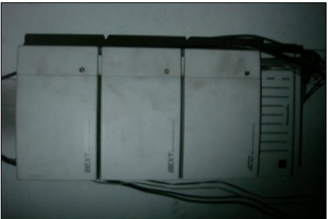
ITEM 3,043 - VISTA DA CENTRAL PABX MARCA: PANASONIC MODELO: KX COM 1 4CO E 2 BEXT
