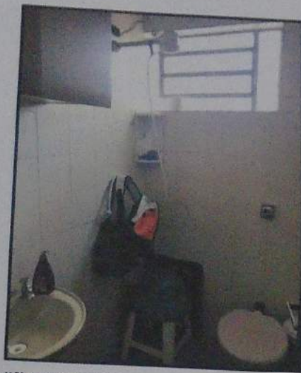
Foto 11 – “Edifício Carlos” – Apartamento 1 – W.C. de empregada
