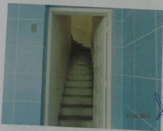
Vistas, frontal e da escada de acesso ao imóvel avaliando – nº 236 – A.
