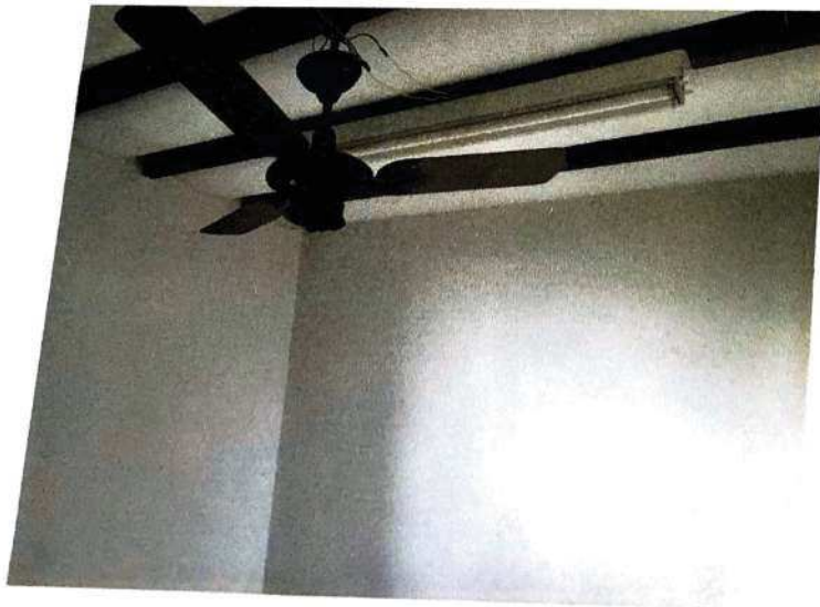
Foto 18 - Quarto da edícula - Ausência de laje
