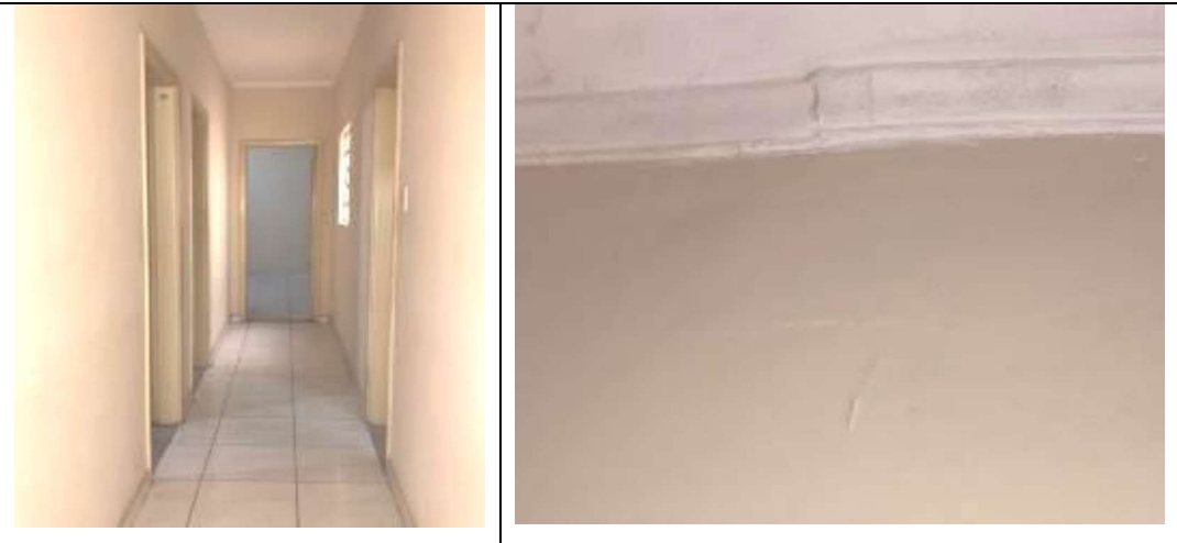
SÉRIE-FOTOGRAFICA 08 - VISTA GERAL DO HALL DE DISTRIBUIÇÃO INTERNA, COM DANOS LOCALIZADOS NO REVESTIMENTO E PINTURA.
