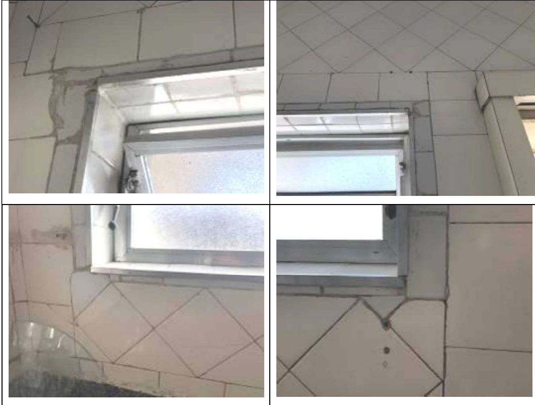
SÉRIE-FOTOGRAFICA 03 - REGISTROS DO REVESTIMENTO DE PAREDES DA COZINHA, ONDE HAVIA "REMENDOS" DE PEÇAS CERÂMICAS.
