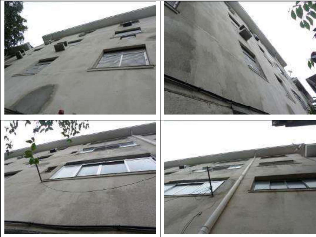
SÉRIE - FOTOGRÁFICA 04 - ENFOQUES DA FACHADA POSTERIOR DESSE EDIFÍCIO, COM ACABAMENTO EM MASSA, FOCALIZANDO AS JANELAS EM FERRO, ALUMÍNIO E PVC DA UNIDADE AVALIANDA, VAGA À DATA DAS DILIGÊNCIAS.
