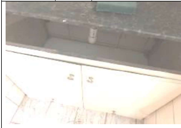
SÉRIE-FOTOGRAFICA 13 – DETALHES DE DANO NO ARMÁRIO (GABINETE) DO BANHEIRO SOCIAL.
