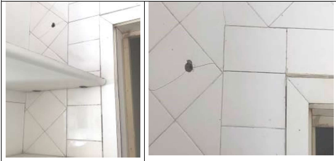
SÉRIE-FOTOGRAFICA 04 - DETALHE DE TRINCAS EM PAREDE DA COZINHA.
