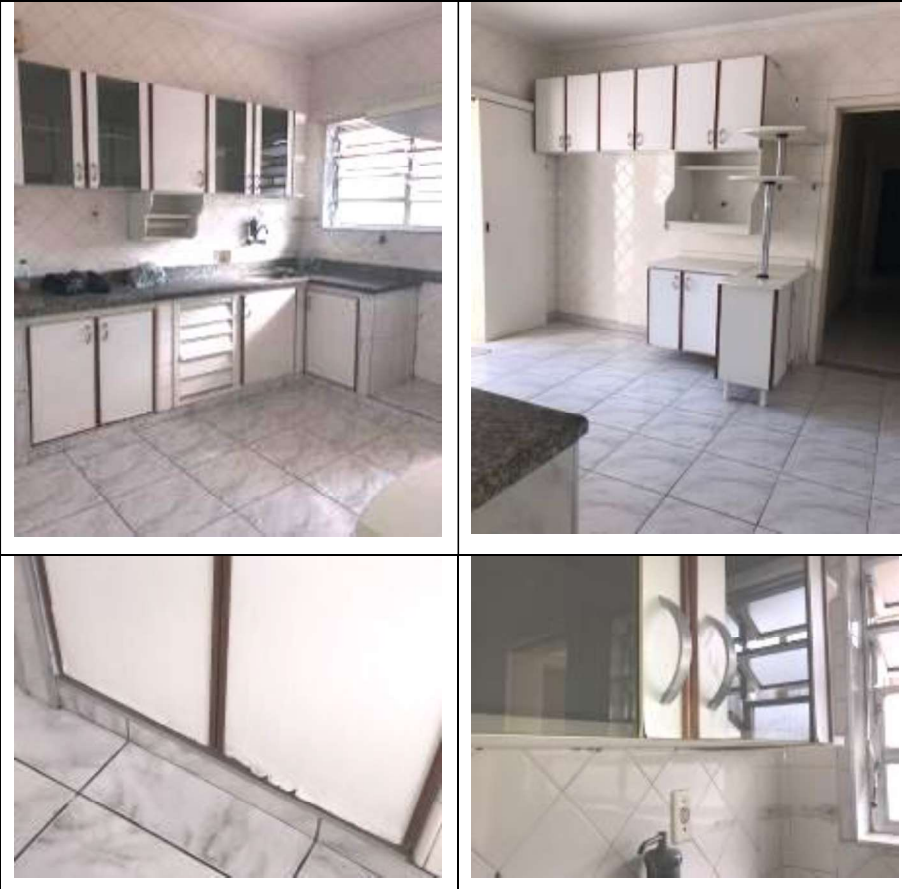
SÉRIE-FOTOGRAFICA 02 – ENFOQUES DA COZINHA, GUARNECIDA POR ARMÁRIOS COM REVESTIMENTO DANIFICADO (VIDE FOTOS INFERIORES).
