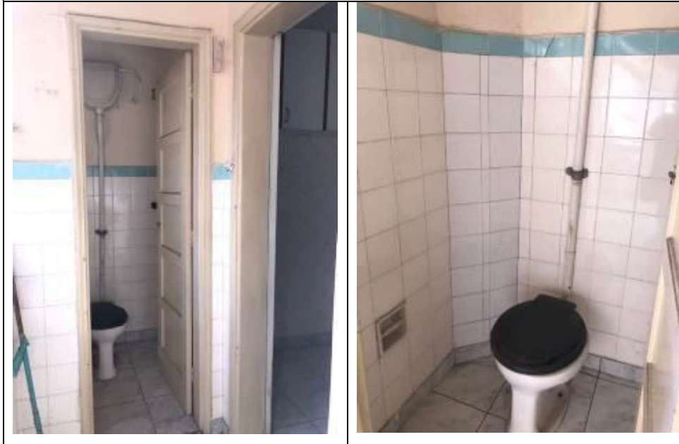
SÉRIE-FOTOGRAFICA 06 – ASPECTO GERAL DO BANHEIRO DE SERVIÇO, DOTADO DE BARRA DE AZULEJOS, POSSIVELMENTE ORIGINAL NAS PAREDES.
