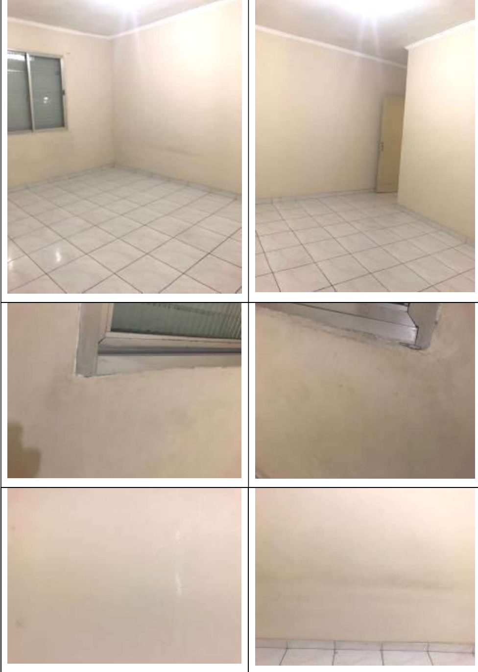
SÉRIE-FOTOGRAFICA 11 – ASPECTO GERAL DO DORMITÓRIO MAIOR, COM DANOS DECORRENTES DE UMIDADE NO REVESTIMENTO E PINTURA DAS PAREDES EXTERNAS, SOBRETUDO SOB O CAIXILHO NÃO ORIGINAL.
