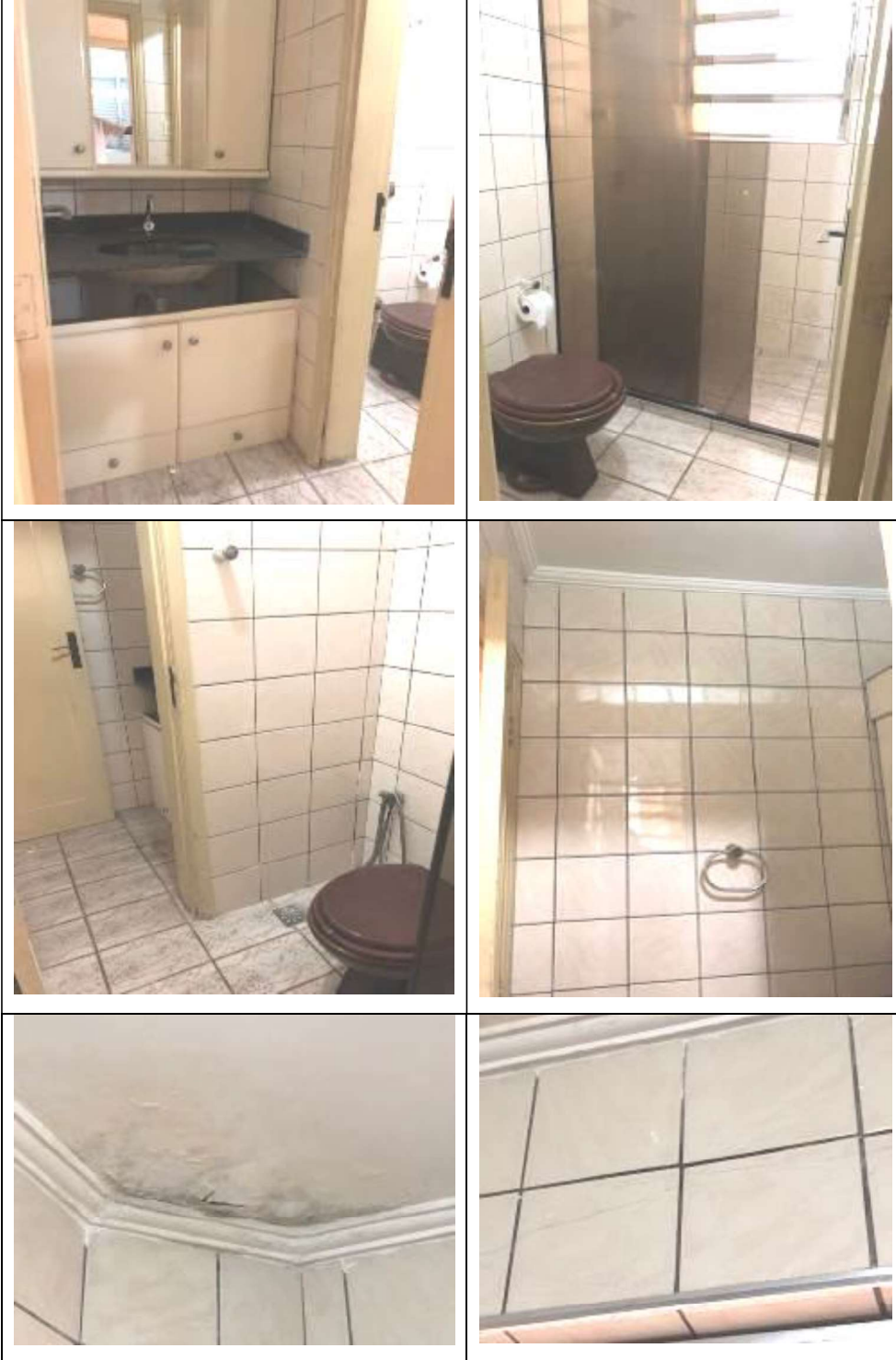
SÉRIE-FOTOGRAFICA 12 - ENFOQUES DO BANHEIRO SOCIAL REFORMADO, COM O REGISTRO DE DANOS LOCALIZADOS DECORRENTES DE UMIDADE E/OU INFILTRAÇÃO NO TETO, ASSIM COMO DE TRINCA EM PAREDE EXTERNA.
