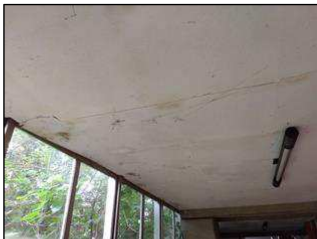
Foto 47 – Forro de gesso da passarela.
