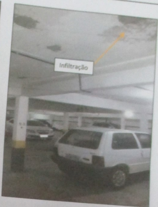
Foto 05- Garagem com infiltração
