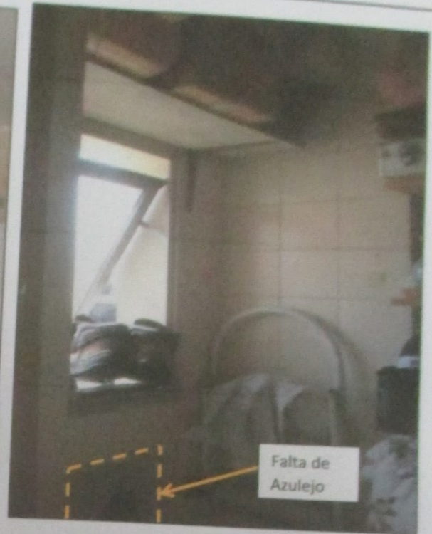
Foto 12 - Banheiro de empregada c/ falta de azulejo
