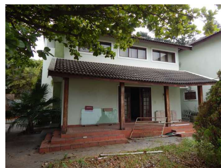
06 - DSCN4010.JPG Área externa - Fachada lateral com varanda da sala. Observa-se que a estrutura da cobertura está deteriorada e apresenta problemas.
