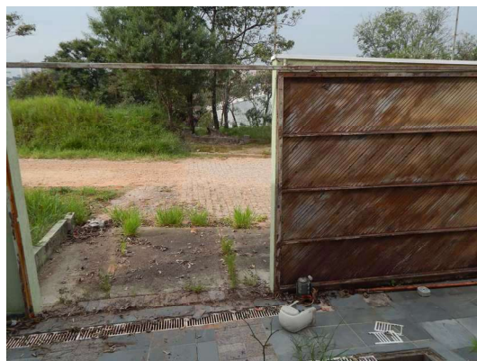
14 - DSCN4021.JPG Área externa - Portão da garagem deteriorado.
