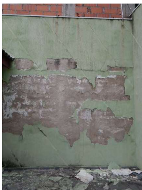
13 - DSCN4020.JPG Área externa - Muro lateral com deterioração do revestimento de massa e da pintura.
