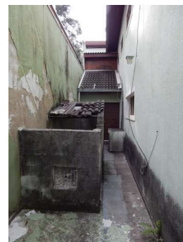
16 - DSCN4091.JPG Área externa - Fachada lateral com umidade no revestimento. Muro lateral com deterioração do revestimento de massa e da pintura.
