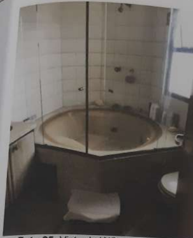
Foto 25: Vista do WC da suite da unidade 101 do bloco 2 do Edifício Panorama.
