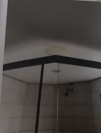
Foto 26: Vista do WC da suite da unidade 101 do bloco 2 do Edifício Panorama.
