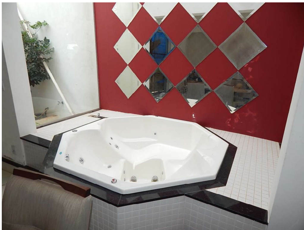
FOTO 21 – BANHEIRA DE HIDROMASSAGEM INSTALADA NAS SALAS
