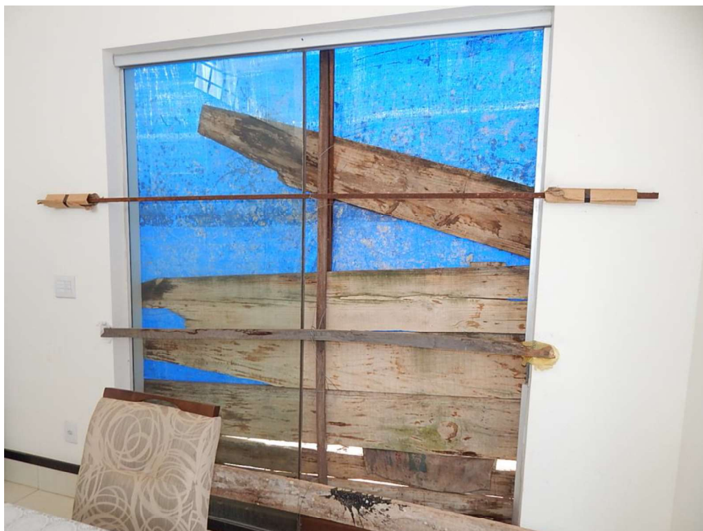
FOTO 24 – JANELA DE VIDRO TEMPERADO QUEBRADA SALA
