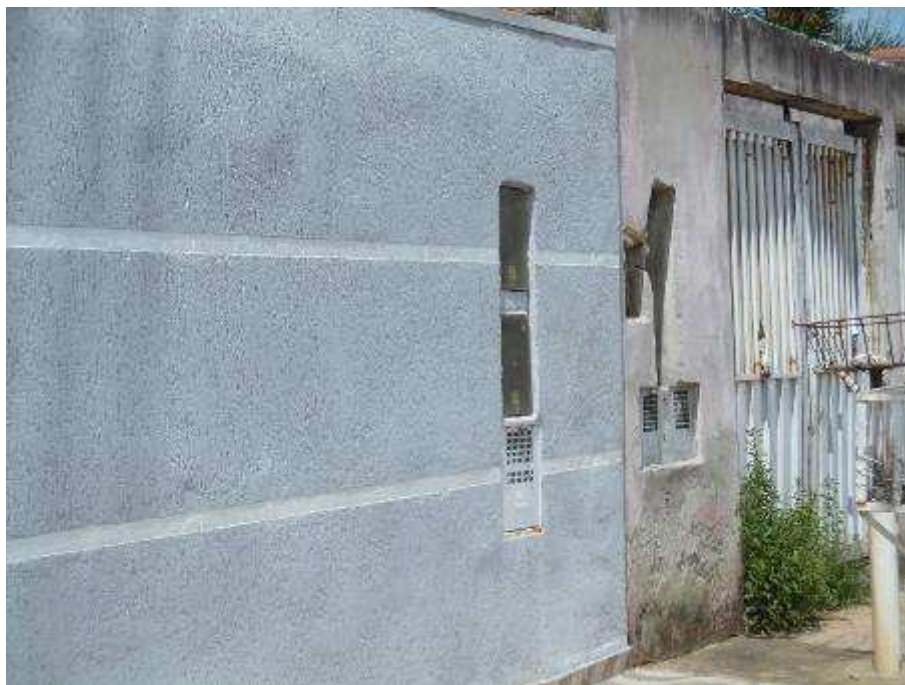
Esta foto mostra que existem dois medidores de energia no imóvel.
