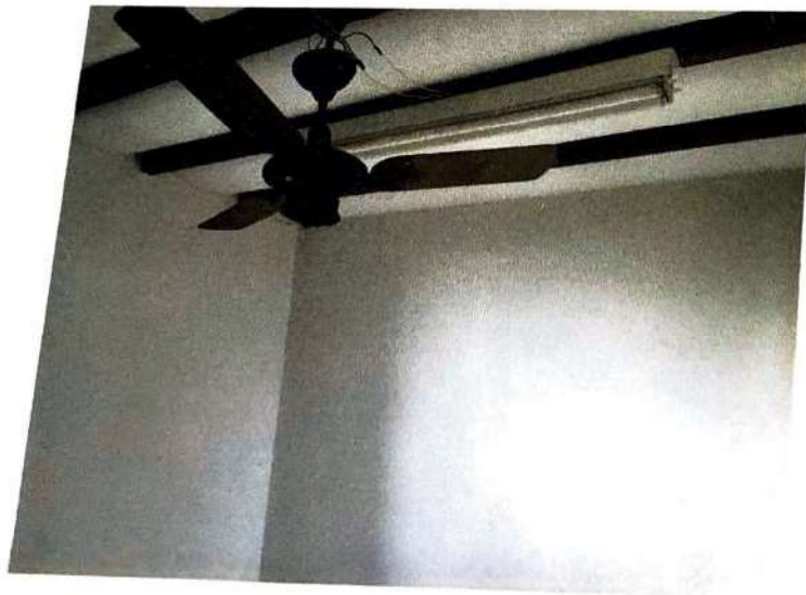
Foto 18 - Quarto da edícula - Ausência de laje
