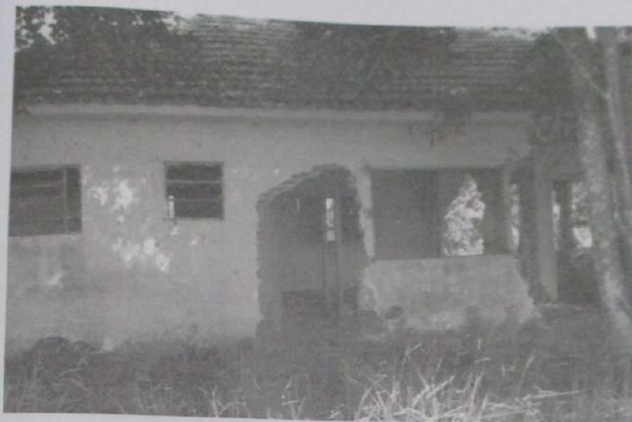
Foto 16: outra vista da construção residencial existente no interior do imóvel avaliando. Conforme se observa nesta foto, tal construção foi depredada e não tem valor comercial. Tal casa fica ao lado da estrada de terra que se interliga à Estrada Municipal Missao Kinoshita (antiga Estrada de Furnas).
