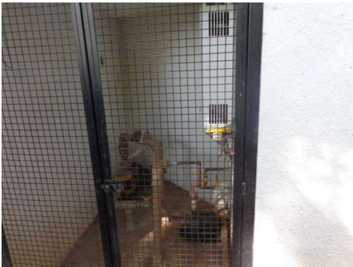
Aspectos do aquecedor da piscina
