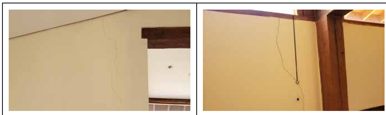
Vista de rachaduras nas paredes da sala e mezanino
