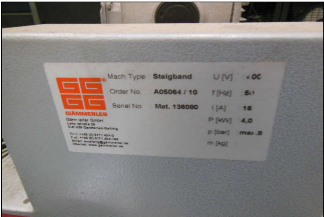
ITEM 1,033 - VISTA DA PLACA DE IDENTIFICAÇÃO DA ESTEIRA (SAÍDA NA LATERAL DA GOSS) MARCA: TRANSNORM
