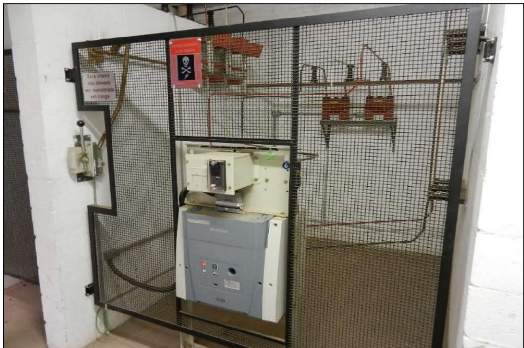
ITEM 1,153 - VISTA DA CABINE SECUNDARIA COMPREENDENDO: 1 DISJUNTOR MARCA: SIEMENS SION TIPO: 3AE1282.2 17,5 KV, 1250 A, 1 CHAVE SECCIONADORA, 2 TRANSFORMADORES DE POTENCIAL
