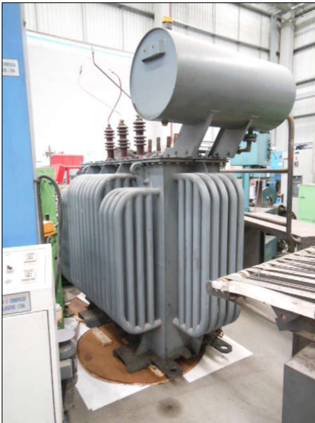
ITEM 1,064 - VISTA DO TRANSFORMADOR TRIFÁSICO A ÓLEO
