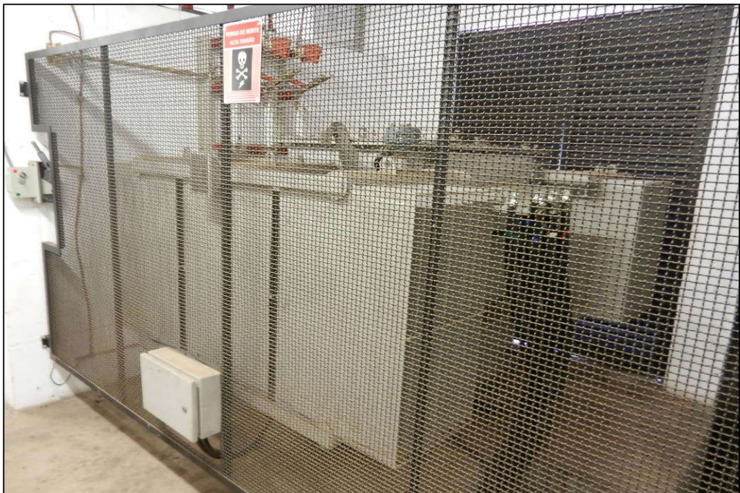
ITEM 1,153 - VISTA DA CABINE SECUNDARIA COMPREENDENDO: 1 CHAVE SECCIONADORA, 1 TRANSFORMADOR MARCA: TRAF0 TIPO: TEC-1500/1.5/1.2 CAP: 1.500 KVA, 13,8/460/265,6 KV
