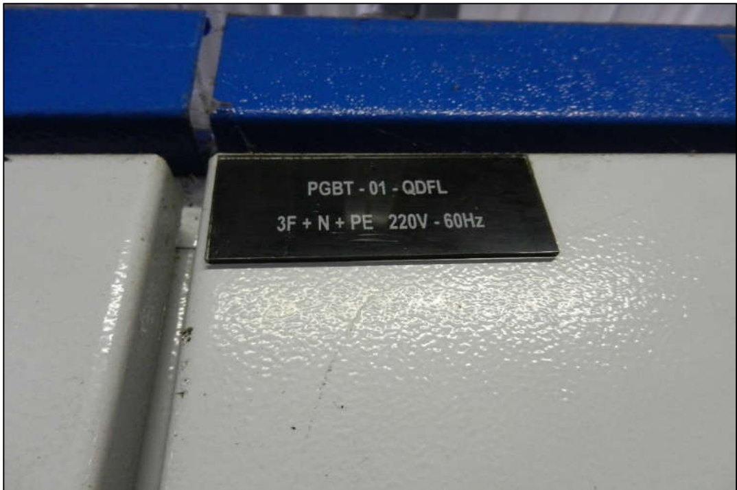
ITEM 1,127 - VISTA DO QUADRO DE COMANDO MARCA: CSW ENERGY (PGBT-01) FABRICA COM 5 MODULOS, E DEMAIS COMPPONENTES
