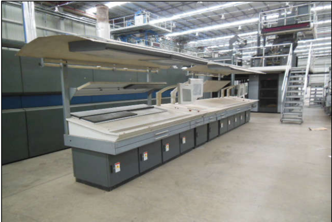
ITEM 1,032 - VISTA DO PAINEL DE CONTROLE E COMANDO
