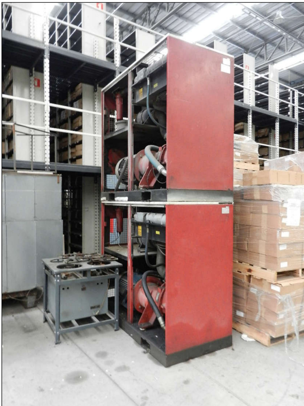
ITEM 1,161 / 1,162 - VISTA DOS 2 COMPRESSORES DE AR MARCA: CHICAGO PNEUMATIC MODELO: 14-SOMA SERIE: 4380 E 4379
