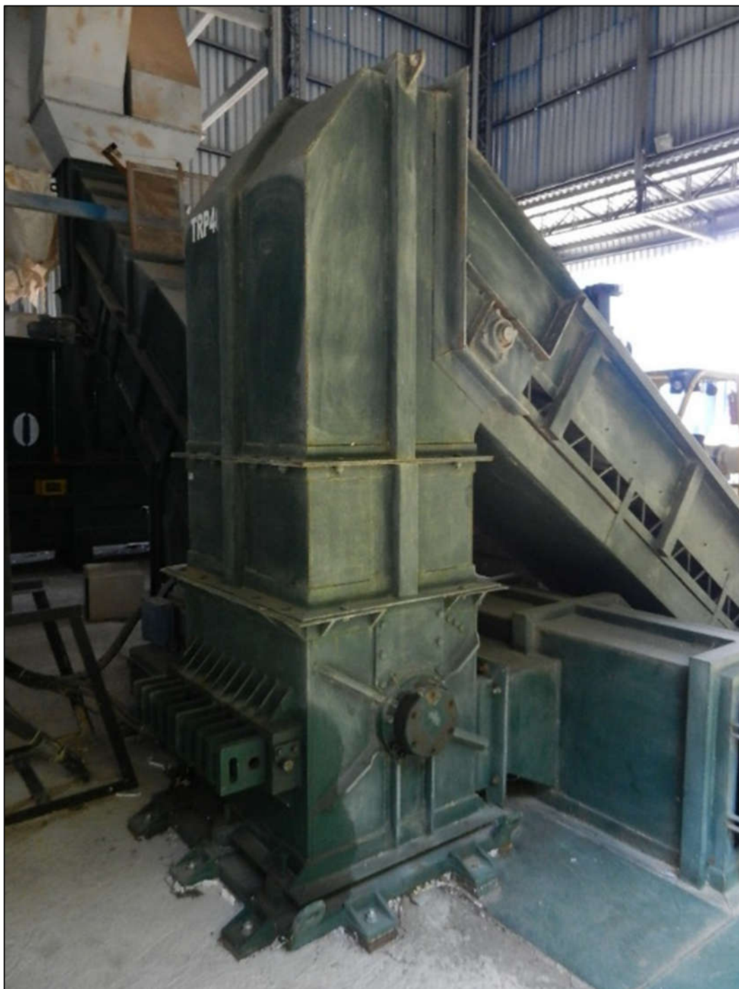
ITEM 1,146 - VISTA DA LINHA DE Prensagem de Aparas de Papel compreendendo os itens (TRITURADOR (TRP-40) COM MOTOR ELETRICO DE 40 CV
