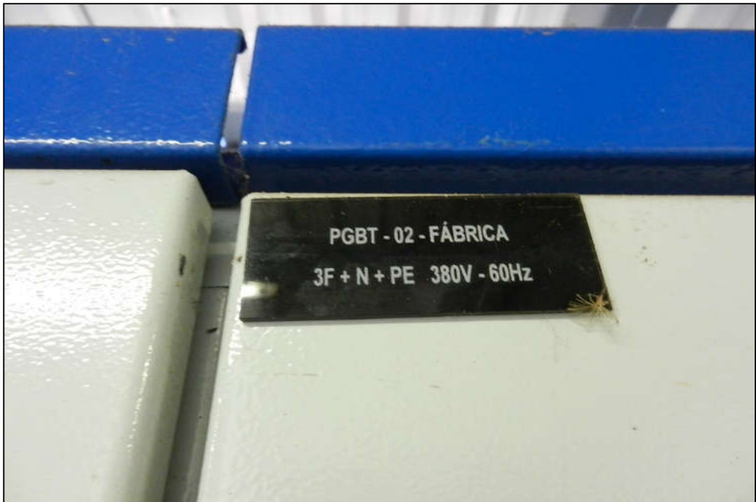
ITEM 1,126 - VISTA DO QUADRO DE COMANDO MARCA: CSW ENERGY (PGBT-02) FABRICA COM 6 MODULOS, 1 DISJUNTOR GERAL, CHAVES E DEMAIS COMPONENTES
