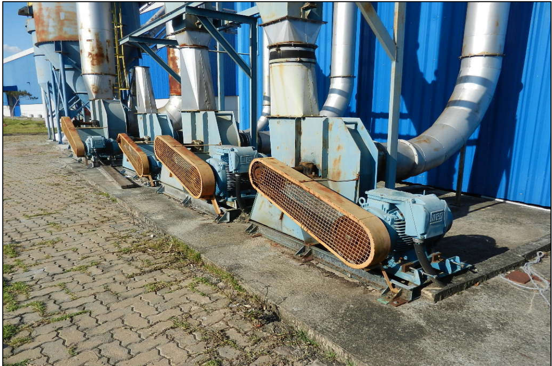
ITEM 1,146 - VISTA DA LINHA DE PENSAGEM DE APARAS DE PAPEL COMPREENDENDO OS ITENS (4 VENTILADORES CENTRIFUGOS)
