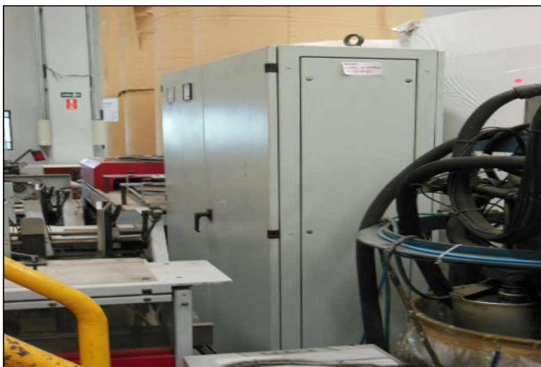
ITEM 1,041 - VISTA DO PAINEL ELÉTRICO
