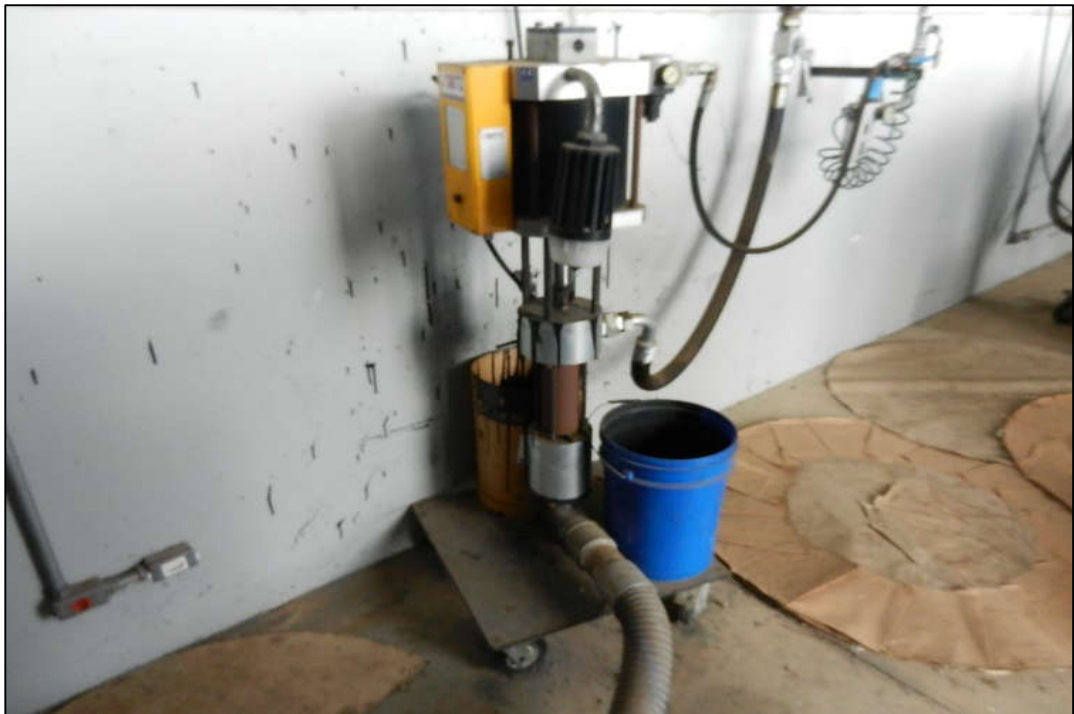
ITEM 1,122 - VISTA DAS 4 (QUATRO) BOMBAS PARA TINTA MARCA: BETZ TECHNOLOGIES TIPO: P-250-1 PLC SERIES: 71210-520, 71210-518, 71210-519 E 71210-521
