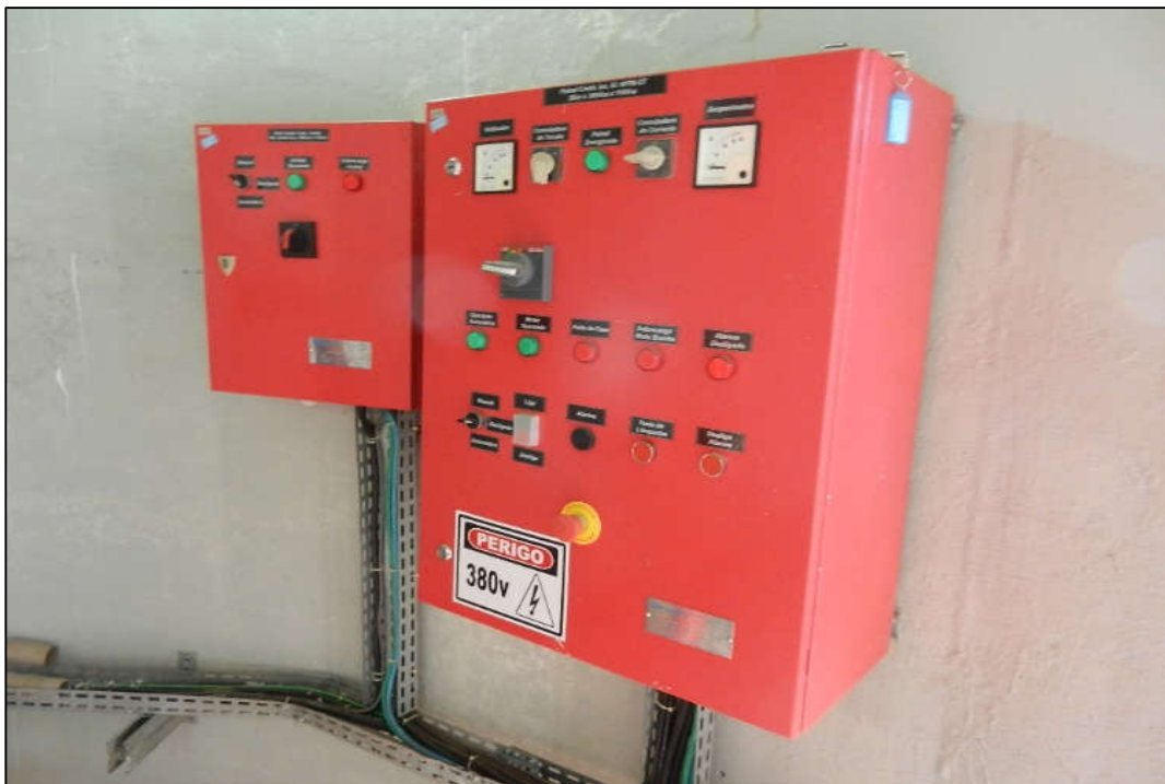
ITEM 1,132 - VISTA DO SISTEMA DE INCENDIO MARCA: GERMEK COMPREENDENDO: BOMBA CENTRIFUGA PARA INCENDIO MARCA: THEBE MODELO: RL20B(F) SERIE: 22.188 COM MOTOR ELETRICO DE 25 CV, BOMBA JOCKEY MARCA: THEBE MODELO: P-11/4 COM MOTOR ELETRICO DE 3 CV (PAINEL DE COMANDO)
