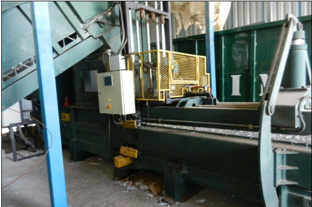
ITEM 1,146 - VISTA DA LINHA DE PENSAGEM DE APARAS DE PAPEL COMPREENDENDO OS ITENS (Prensa enfardadeira horizontal hidraulica (PP-40) com alimentador de arame
