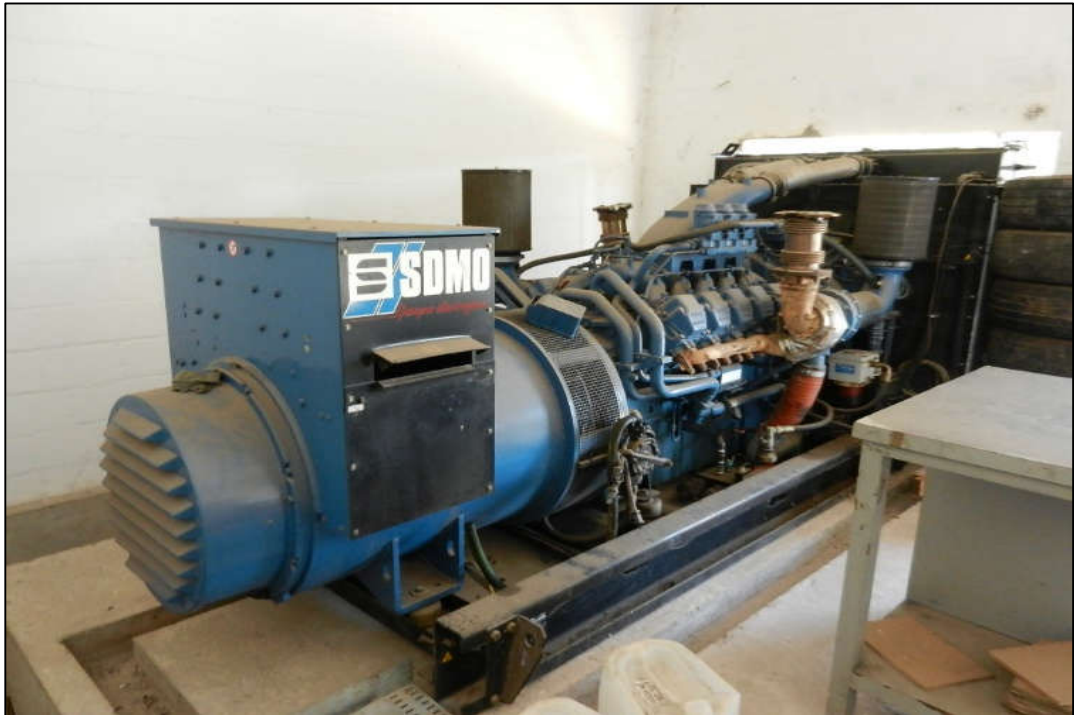
ITEM 1,109 - VISTA DO GRUPO GERADOR A DIESEL MARCA: SDMO TIPO: LSA-50.1 S4-4P CAP: 1.025 KVA 400 V COM MOTOR DIESEL MARCA: MTU
