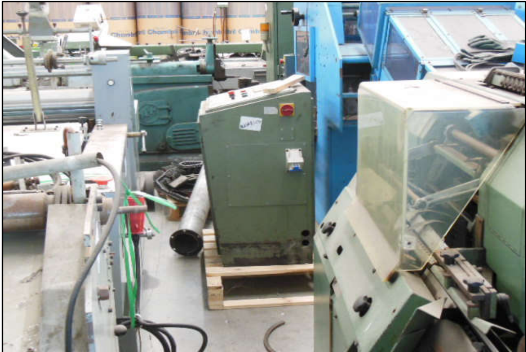
ITEM 1,082 - VISTA DO PAINEL DE COMANDO MARCA: KOLBUS
