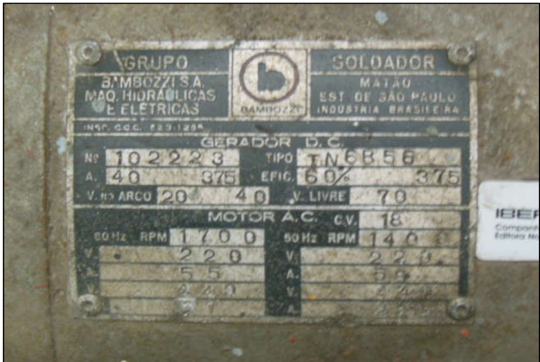
ITEM 1,079 - VISTA DA PLACA DE IDENTIFICAÇÃO DO GERADOR DE SOLDA MARCA: BAMBOZZI MODELO: TN-6B-56 CAP: 375 A Nº 102223
