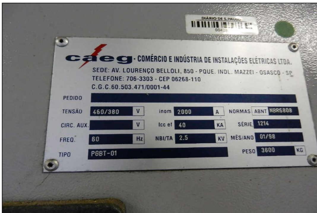
ITEM 1,123 - VISTA DO QUADRO DE COMANDO MARCA: CEAG TENSÃO: 460/380V TIPO: PGBT-01 SERIE: 1214 COM 4 DISJUNTORES MARCA: ABB TIPO: SACE F1 2000 A, 4 VOLTÍMETROS, 4 AMPERÍMETROS E DEMAIS COMPONENTES
