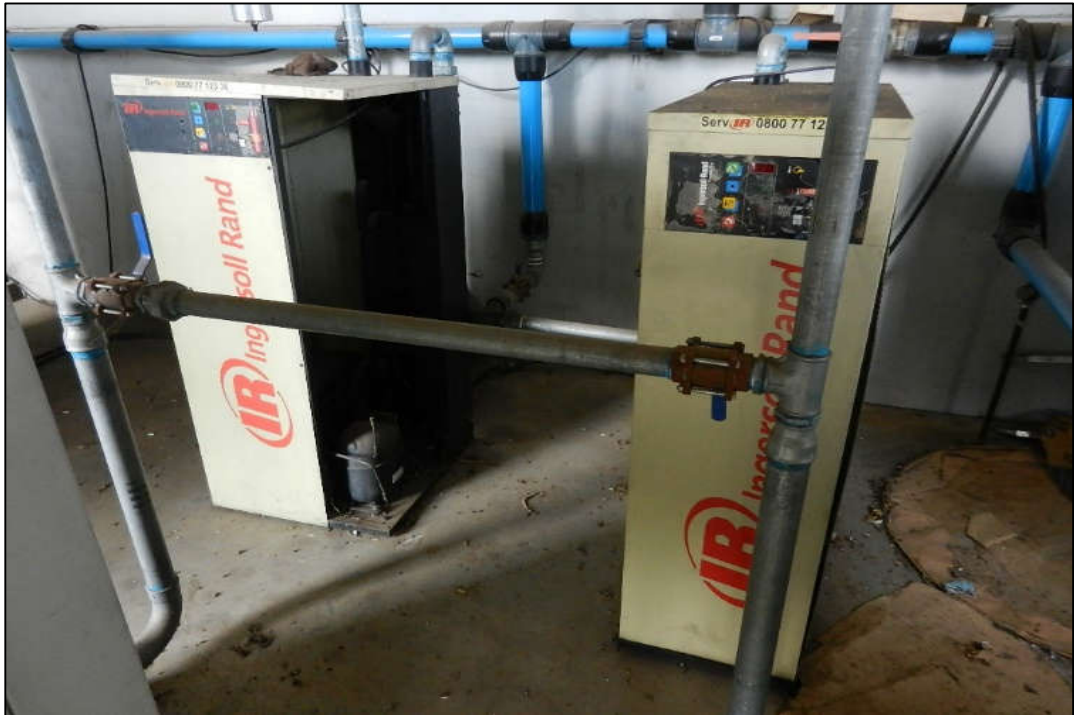
ITEM 1,115 / 1,116 - VISTA DOS SECADORES DE AR MARCA: INGERSOLL RAND MODELO: TD-210 SERIE: 23.215/07
