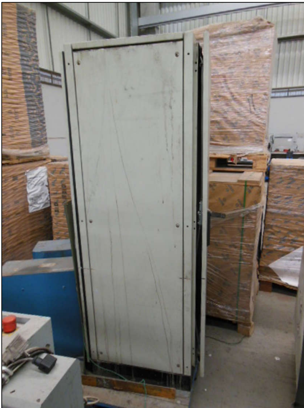
ITEM 1,077 - VISTA DO PAINEL DE CONTROLE E COMANDO DOS EXAUSTORES MARCA: VALE MAQUINA
