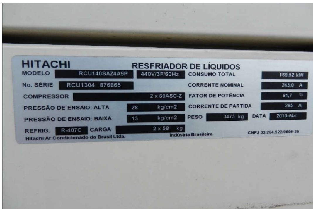
ITEM 1,128 - VISTA DO RESFRIADOR DE LIQUIDOS MARCA: HITACHI MODELO: RCU-140SAZ4A9P SERIE: RCU1304-876865 (PLACA DE IDENTIFICAÇÃO)
