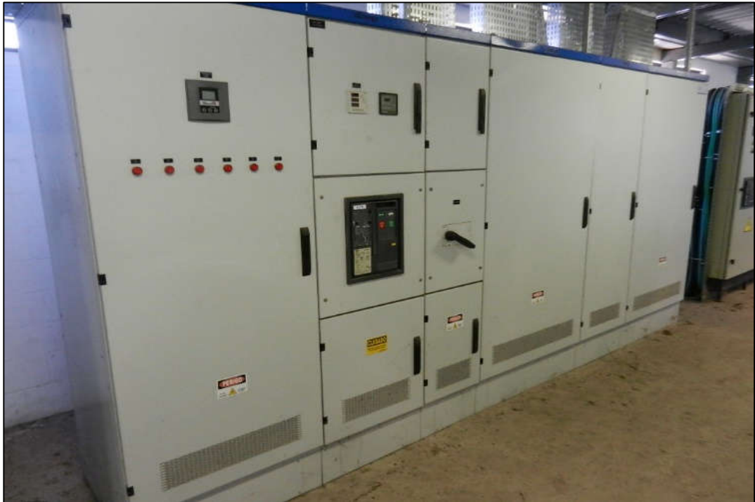
ITEM 1,126 - VISTA DO QUADRO DE COMANDO MARCA: CSW ENERGY (PGBT-02) FABRICA COM 6 MODULOS, 1 DISJUNTOR GERAL, CHAVES E DEMAIS COMPONENTES
