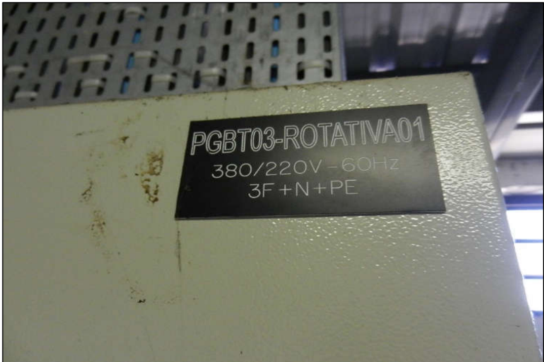
ITEM 1,125 - VISTA DO QUADRO DE COMANDO MARCA: MAK DIM: 2000 X 1400 X 850 MM TIPO: PGBT-03 - ROTATIVA 01 TENSAO: 380/220V COM 1 DISJUNTOR GERAL MARCA: SCHNEIDER NW32H1 65 KA, MULTIMEDIDOR DE GRANDEZAS ELETRICAS, CONTROLADOR DE FATOR POTENCIA E DEMAIS COMPONENTES
