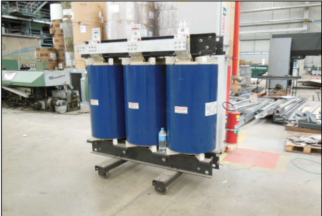
ITEM 1,035 - VISTA DO TRANSFORMADOR MARCA: COMTRAFO MONTADO SOBRE CARRINHO N° 088554
