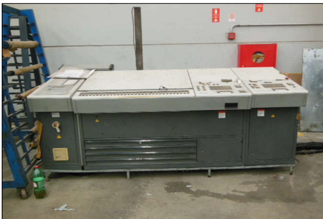
ITEM 1,023 - VISTA DO PAINEL DE COMANDO
