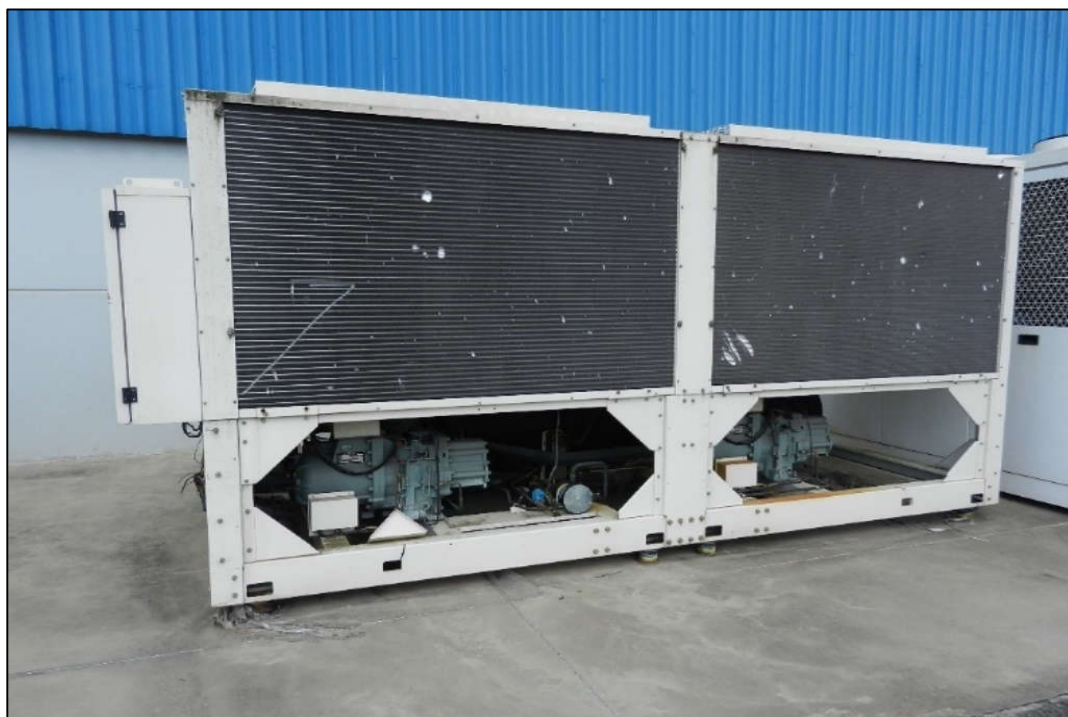
ITEM 1,128 - VISTA DO RESFRIADOR DE LIQUIDOS MARCA: HITACHI MODELO: RCU-140SAZ4A9P SERIE: RCU1304-876865
