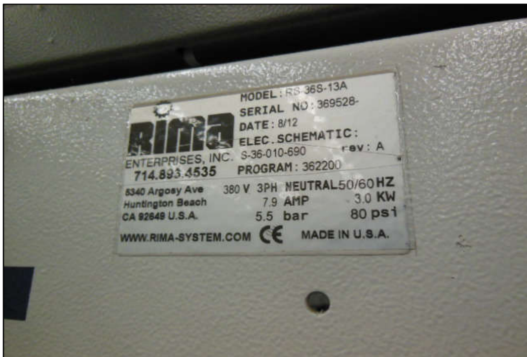
ITEM 1,028 - VISTA DA PLACA DE IDENTIFICAÇÃO DO STACKER DE ALTA VELOCIDADE MARCA: RIMA-SYSTEM MODELO: RS-36S 13A N° 369528
