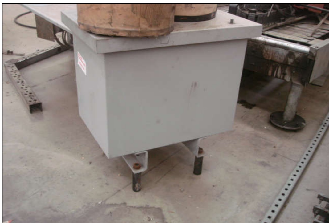
ITEM 1,042 - VISTA DO TRANSFORMADOR
