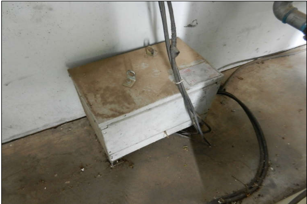
ITEM 1,117 - VISTA DO TRANSFORMADOR REG CONTINUO A SECO MARCA: GHR Nº 65.584 CAP: 30 KVA
