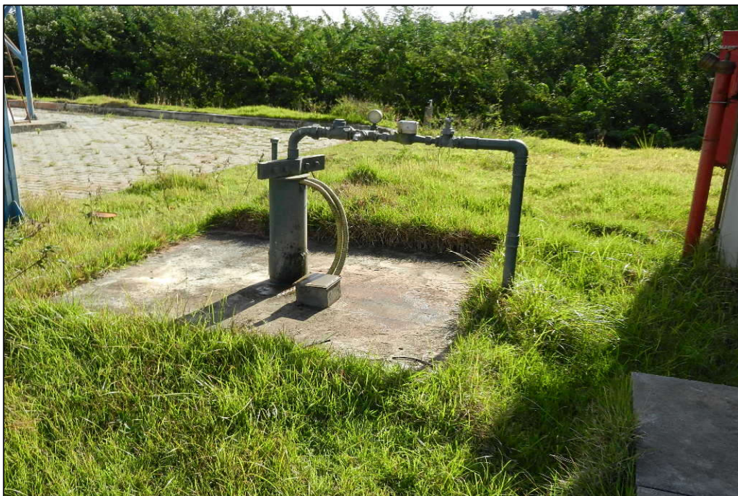
ITEM 1,133 - VISTA DA BOMBA SUBMERSA
