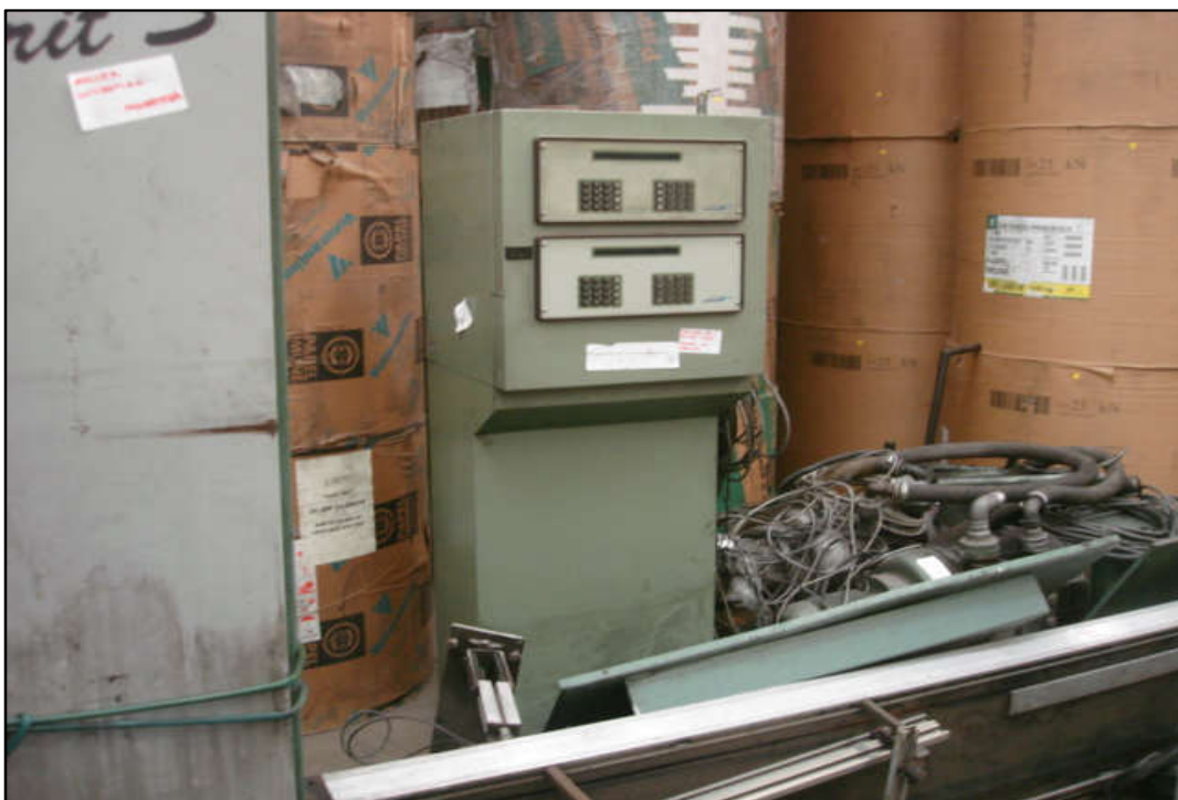
ITEM 1,040 - VISTA DOS PAINÉIS DE COMANDO
