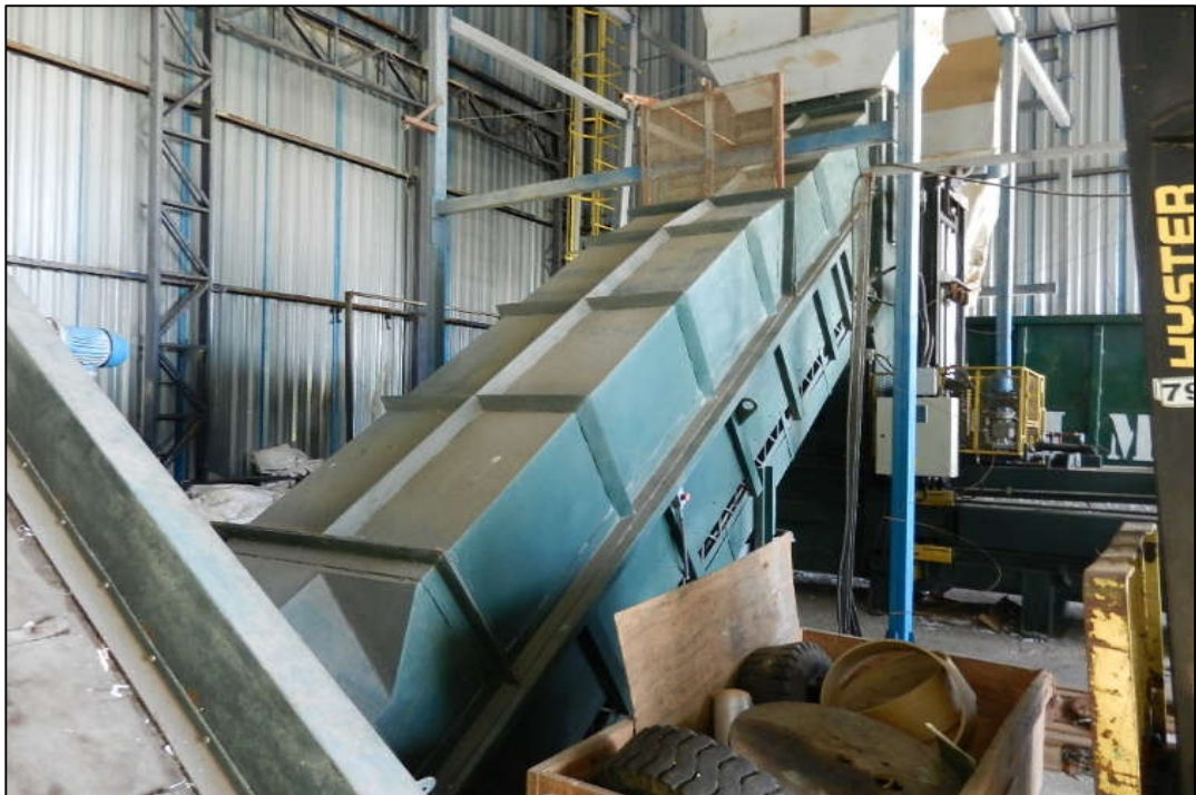
ITEM 1,146 - VISTA DA LINHA DE Prensagem de APARAS DE PAPEL COMPREENDENDO OS ITENS (ESTEIRA INCLINADA PARA ALIMENTAÇÃO DA PRENSA)
