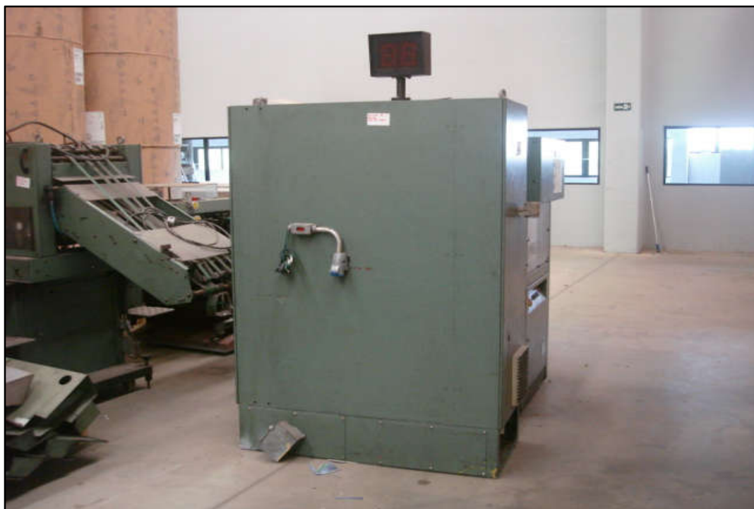
ITEM 1,040 - VISTA DOS PAINÉIS DE COMANDO
