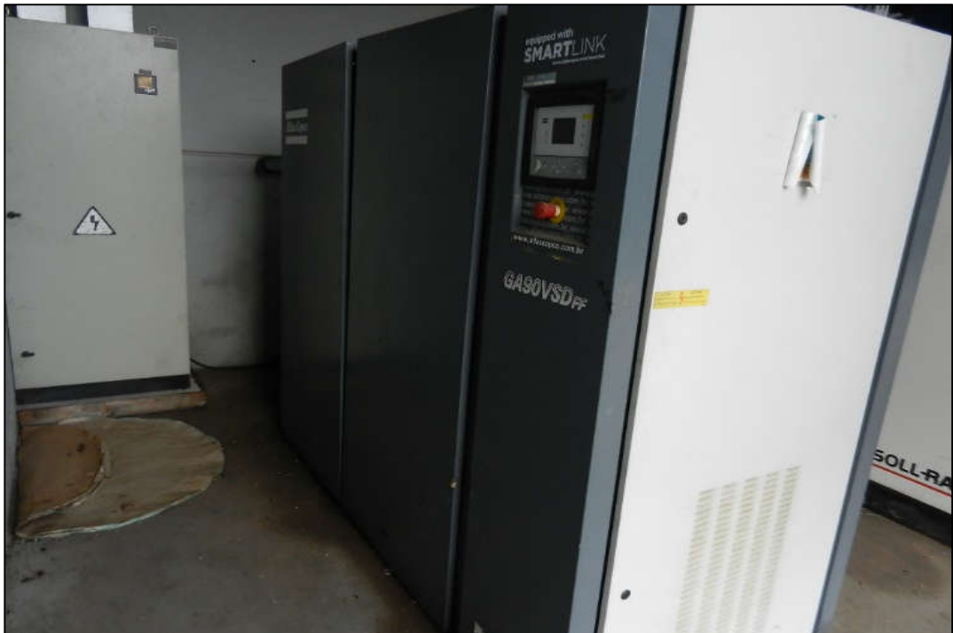
ITEM 1,111 - VISTA DO COMPRESSOR DE AR MARCA: ATLAS COPCO MODELO: GA90VSDFF 380/220 V SERIE: BRP082146
