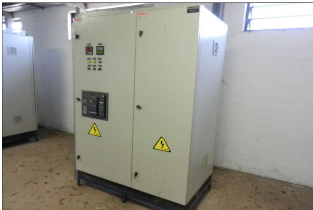
ITEM 1,124 - VISTA DO QUADRO DE COMANDO MARCA: MAK DIM: 2000 X 1400 X 850 MM TIPO: PGBT-04 - ROTATIVA 02 COM 1 DISJUNTOR GERAL MARCA: SCHNEIDER NW32H1 65 KA, MULTIMEDIDOR DE GRANDEZAS ELETRICAS, CONTROLADOR DE FATOR POTENCIA E DEMAIS COMPONENTES
