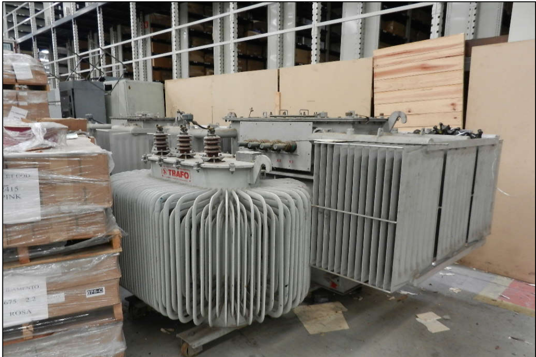
ITEM 1,159 / 1,160 - VISTA DOS 2 TRANSFORMADORES TRIFASICO CAP: 1.500 KVA E 1 DE 300 KVA
