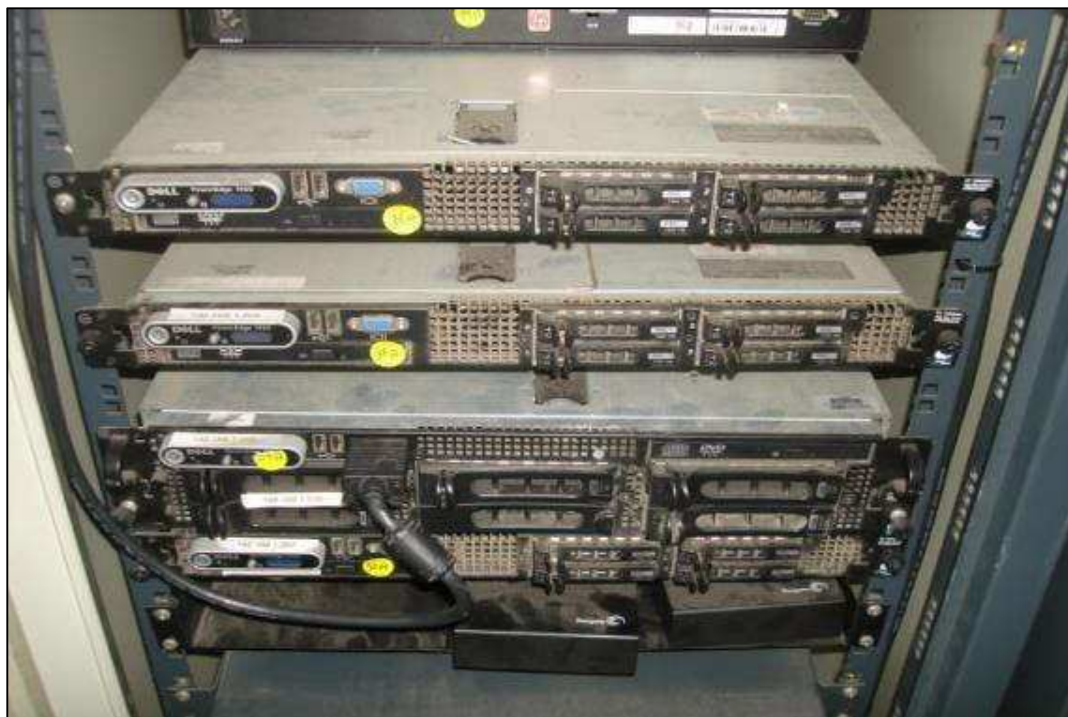
ITEM 0084 - VISTA DOS SERVIDORES MARCA: DELL MOD: POWER EDGE 1950 COM 4 HD SAS 73GB E UMA UNIDADE DVD ROM
