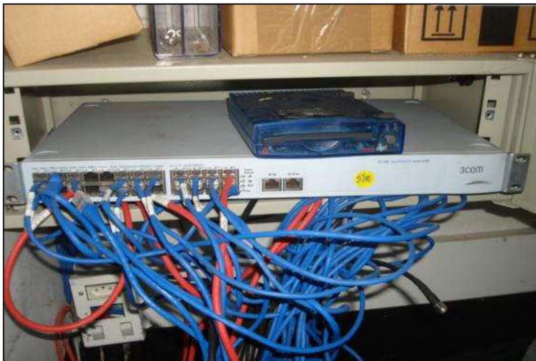
ITEM 0177 - VISTA DO SWITCH 24 PORTAS MARCA: 3COM MOD: SUPERSTACK 3 SWITCH 4226
