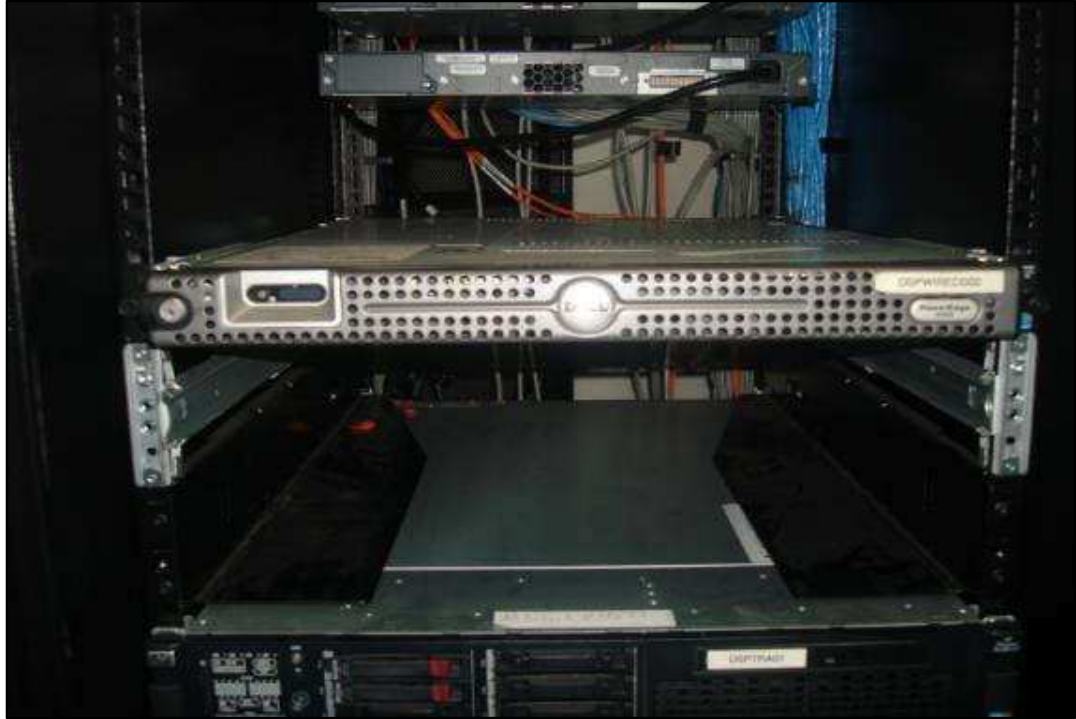
ITEM 1,350 - VISTA DO SERVIDOR DELL POWER EDGE R300
