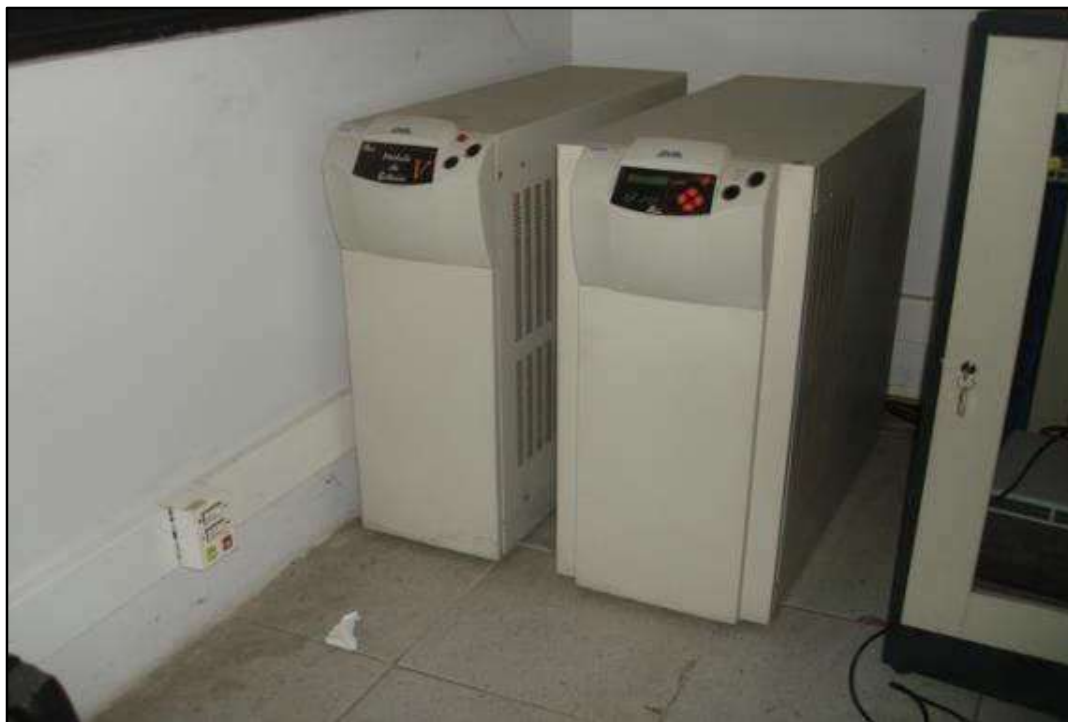
ITEM 0135 E ITEM 0136 - VISTA DO NO-BREAK 20KVA 60HZ MARCA: S.M.S. MOD: SINUS DOUBLE E DO MODULO DE BATERIA DO NO-BREAK MARCA: S.M.S. MOD: SINUS DOUBLE
