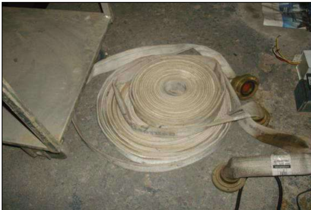
ITEM 1,849 - VISTA DA MANGUEIRA PARA HIDRANTE
