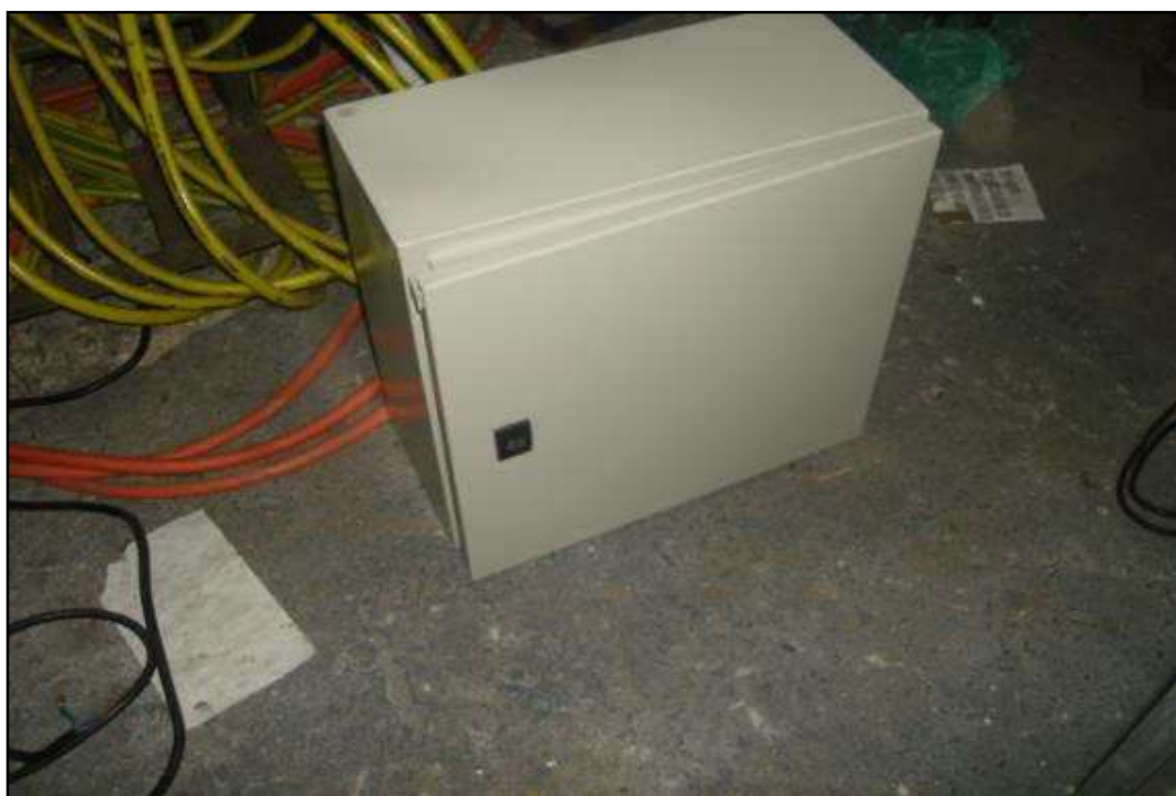
ITEM 1,850 - VISTA DO QUADRO DE COMANDO COM FLANGE CEMAR
