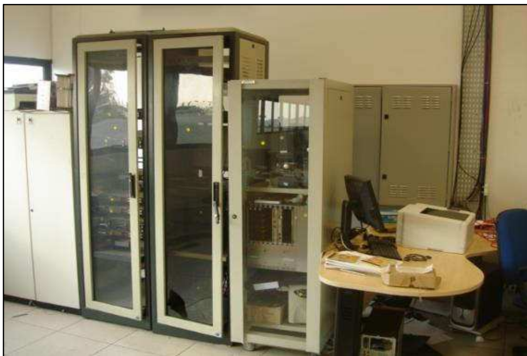
ITEM 0056 E ITEM 0057 - VISTA DO RACK SERVIDOR MARCA: GKC DIM: 800X1000X1800MM COM PORTA DE VIDRO E DO RACK SERVIDOR MARCA: TELIS DIM: 800X1000X2100MM COM PORTA DE VIDRO
