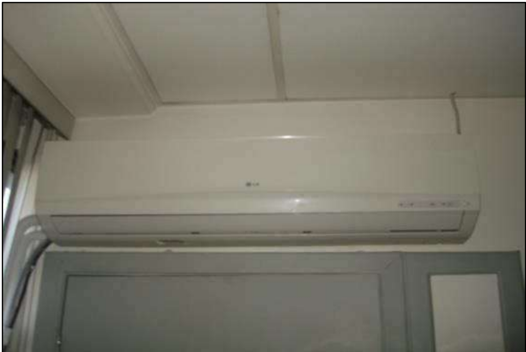
ITEM 1,264 - VISTA DO AR CONDICIONADO (SPLIT LG 24000 BTU)
