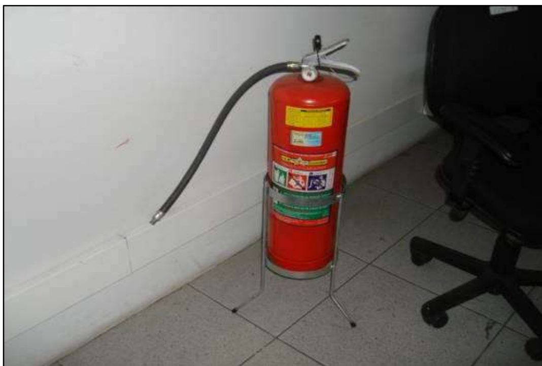
ITEM 0116 - VISTA DO EXTINTOR TIPO A 10 L
