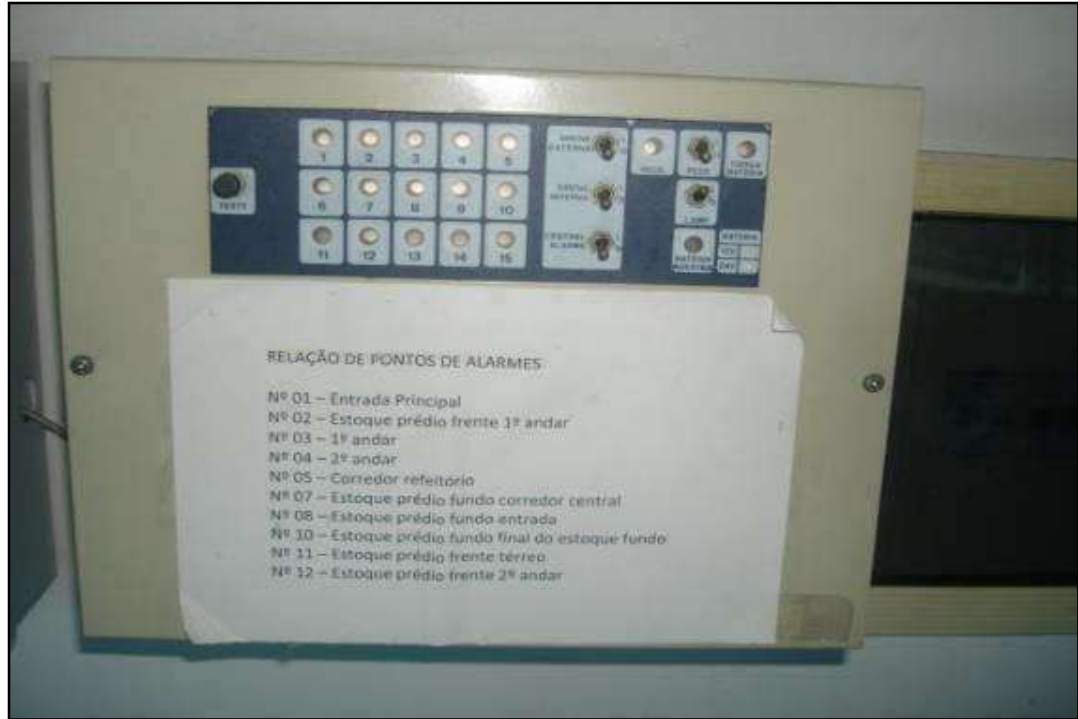
ITEM 1,803 - VISTA DO ADEMCO CONTROL
