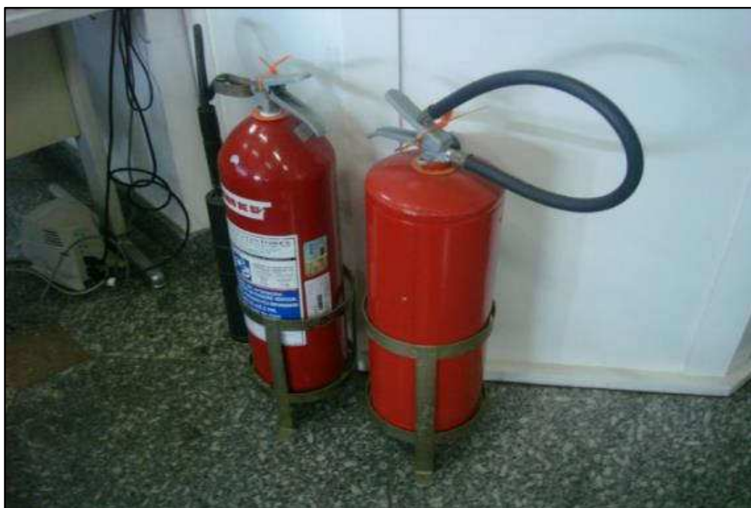
ITEM 1,109 - VISTA DO EXTINTOR
