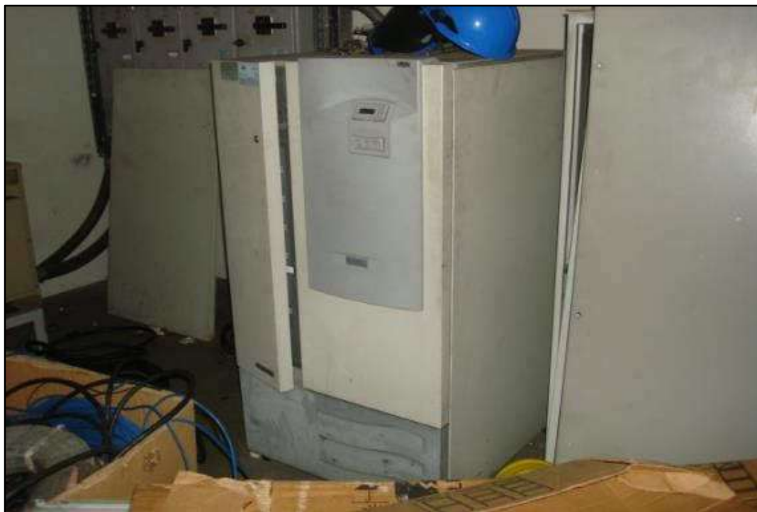
ITEM 2951 - VISTA DO NOBREAK MARCA: CHLORIDE POWER MOD: PROTECTION
