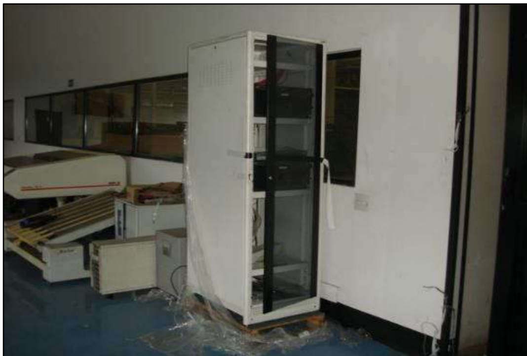
ITEM 0168 - VISTA DO RACK PARA SERVIDOR DIM: 70X50X200 CM
