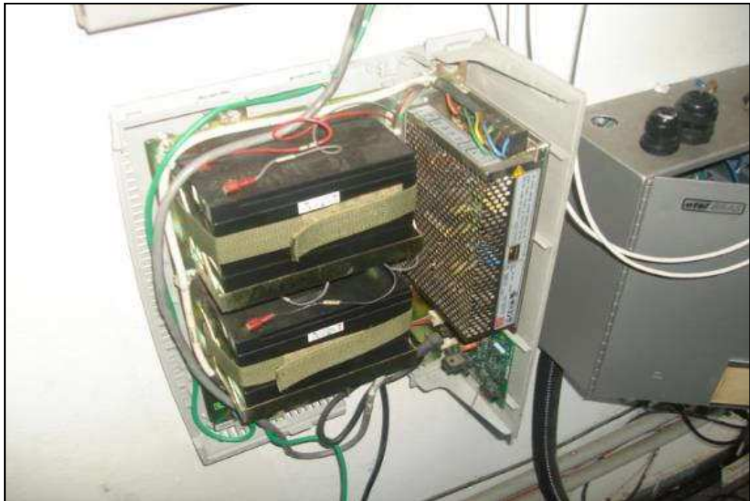
ITEM 1,811 - VISTA DO BANCO DE BATERIA MW 5150-24 COM 2 BATERIAS
