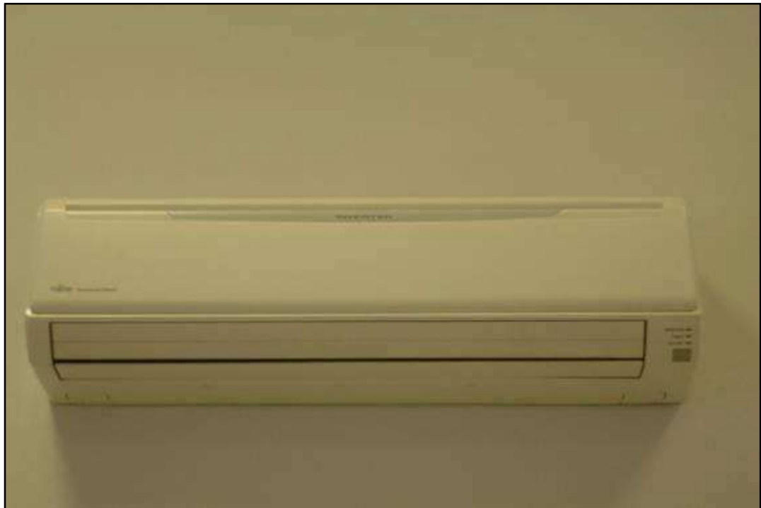
ITEM 0083 - VISTA DO AR CONDICIONADO DE PAREDE MARCA: FUJITSU MOD: INVERTER POWER FULL AND EFICIENT
