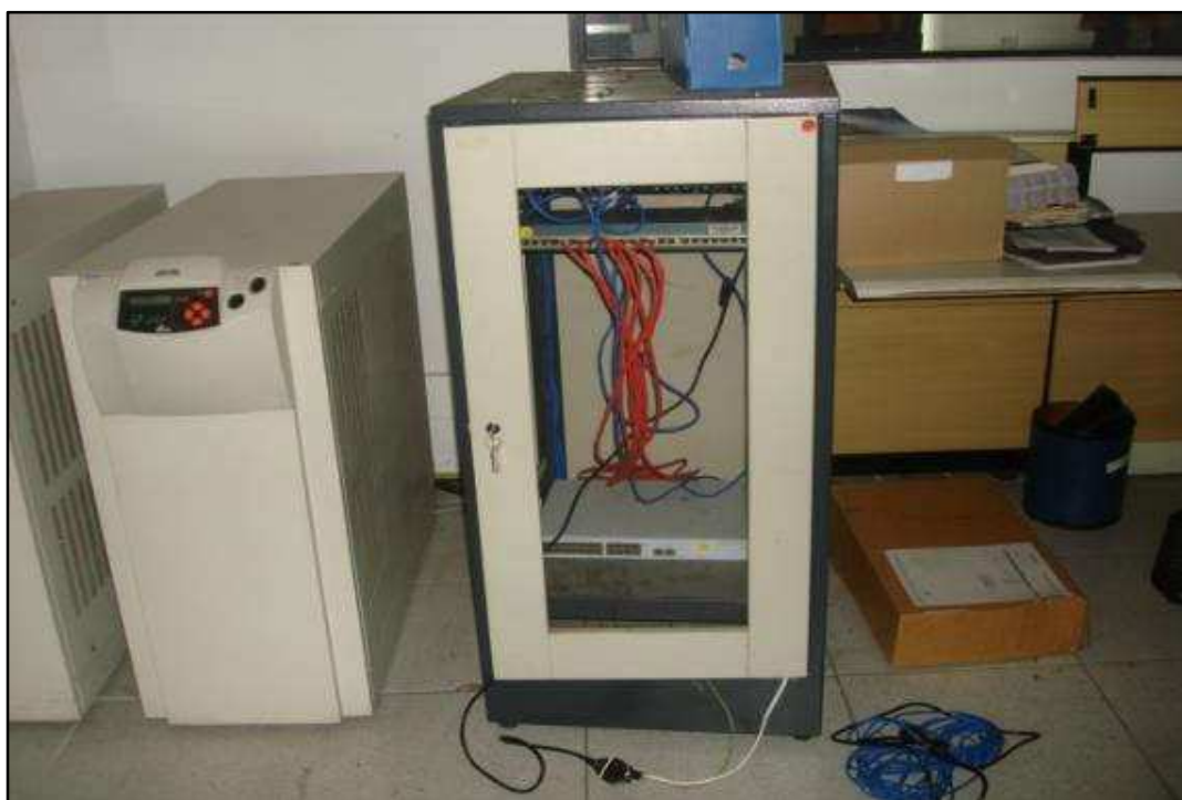
ITEM 0118 - VISTA DO RACK PARA SERVIDOR COM PORTA DE VIDRO DIM: 80X50X100 CM
