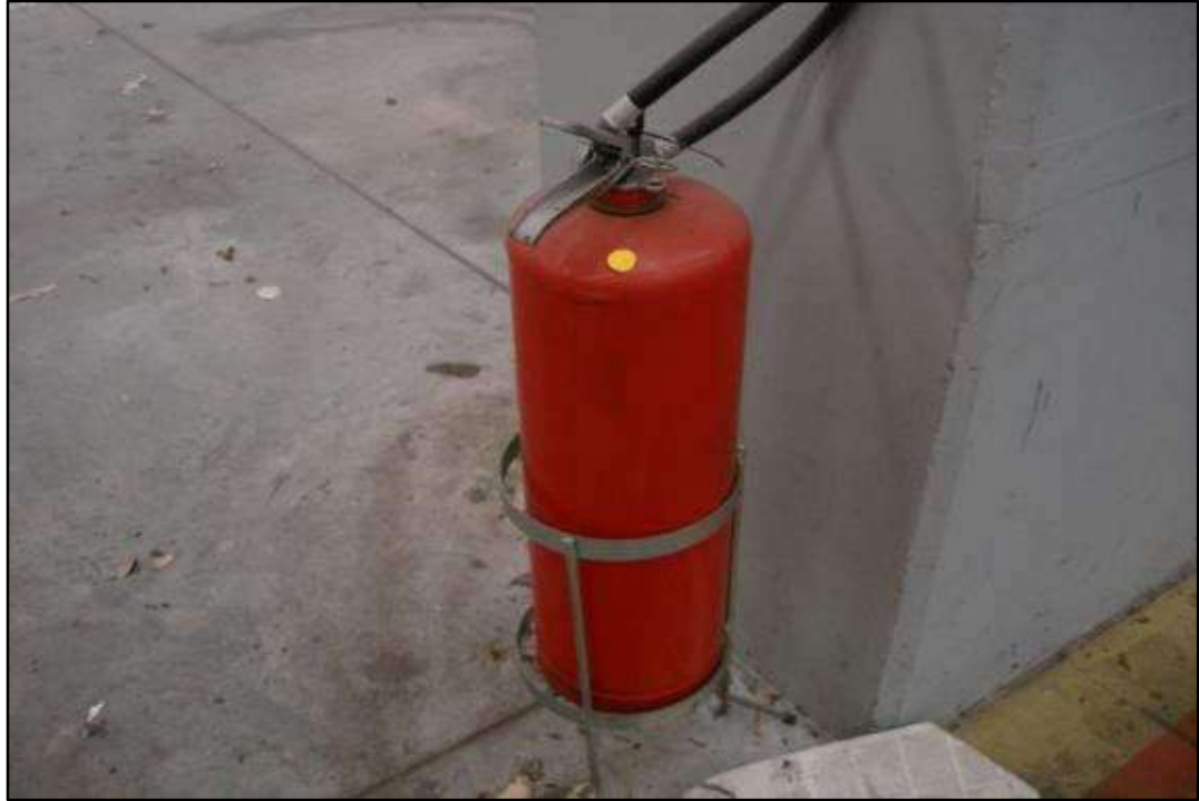
ITEM 2943 - VISTA DO EXTINTOR PÓ QUÍMICO
