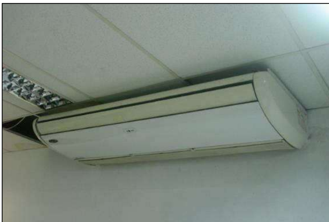
ITEM 1,140 - VISTA DO AR CONDICIONADO - CARRIER
