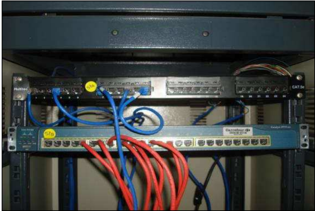
ITEM 0144 - VISTA DO PATCH PANEL MARCA: MULTITOC MOD: CAT 5E
