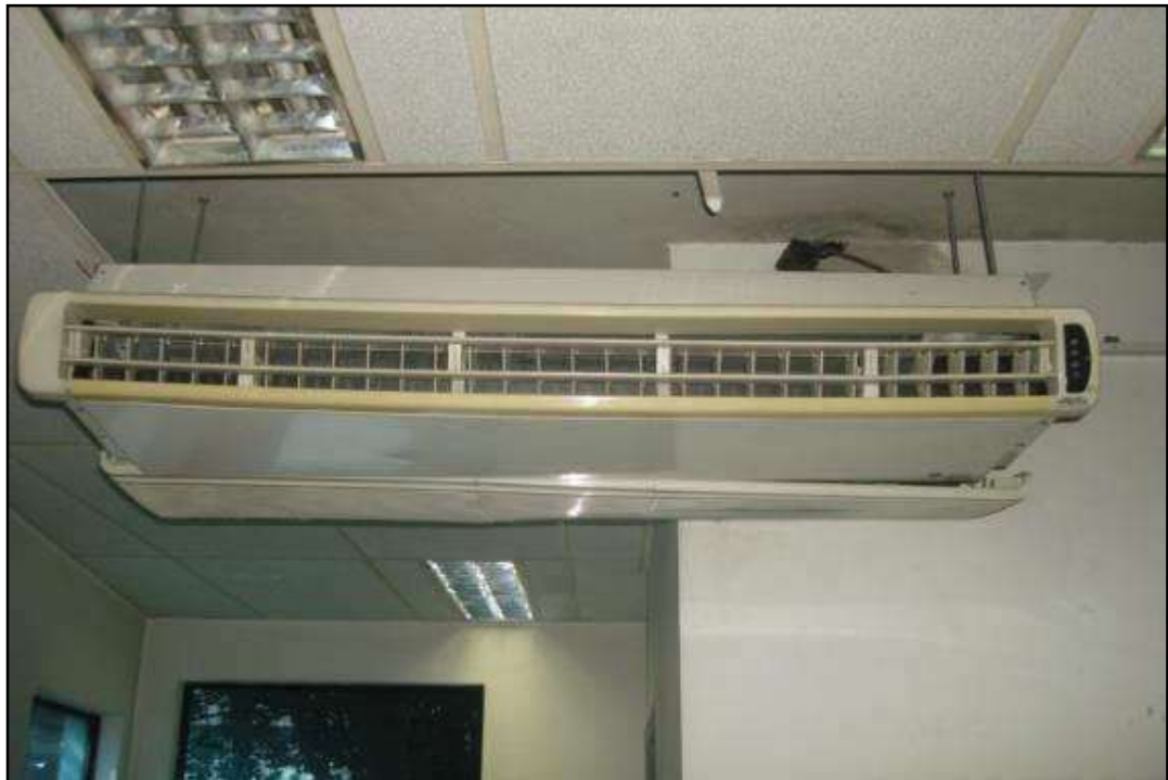
ITEM 1,804 - VISTA DO AR CONDICIONADO TRANE
