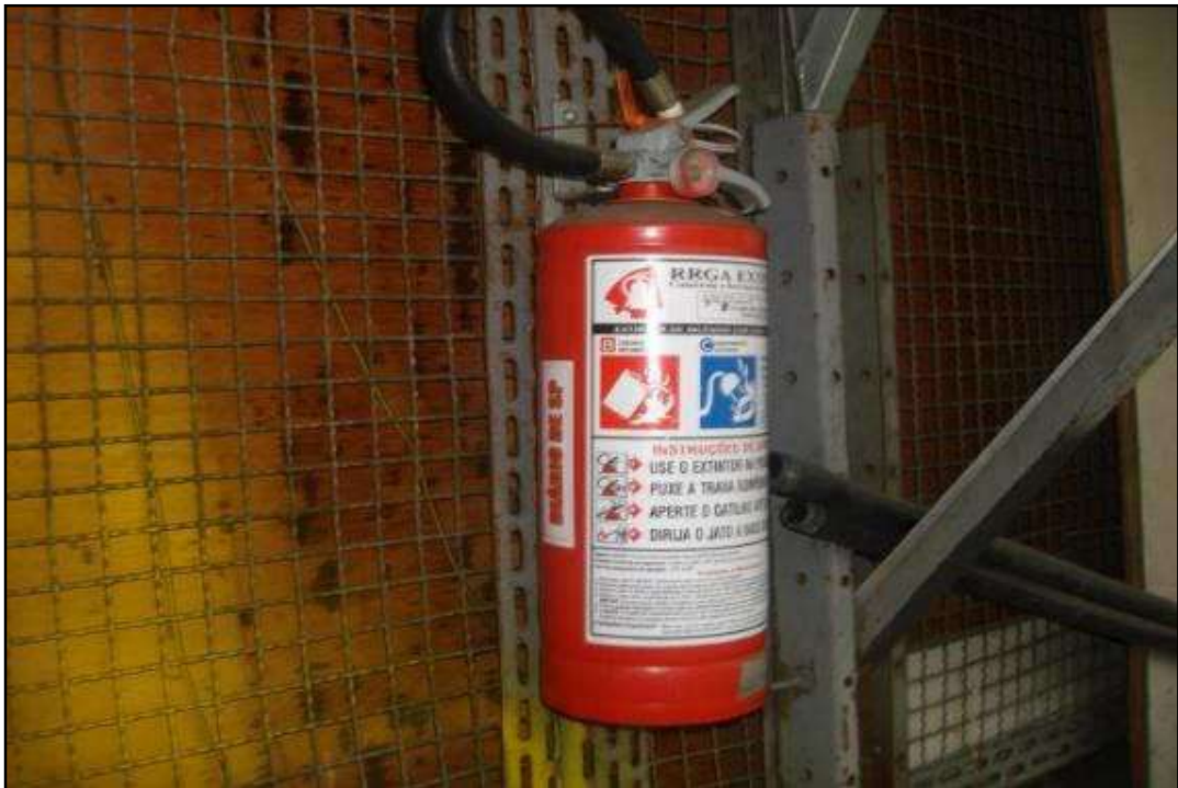
ITEM 1,865 - VISTA DO EXTINTOR
