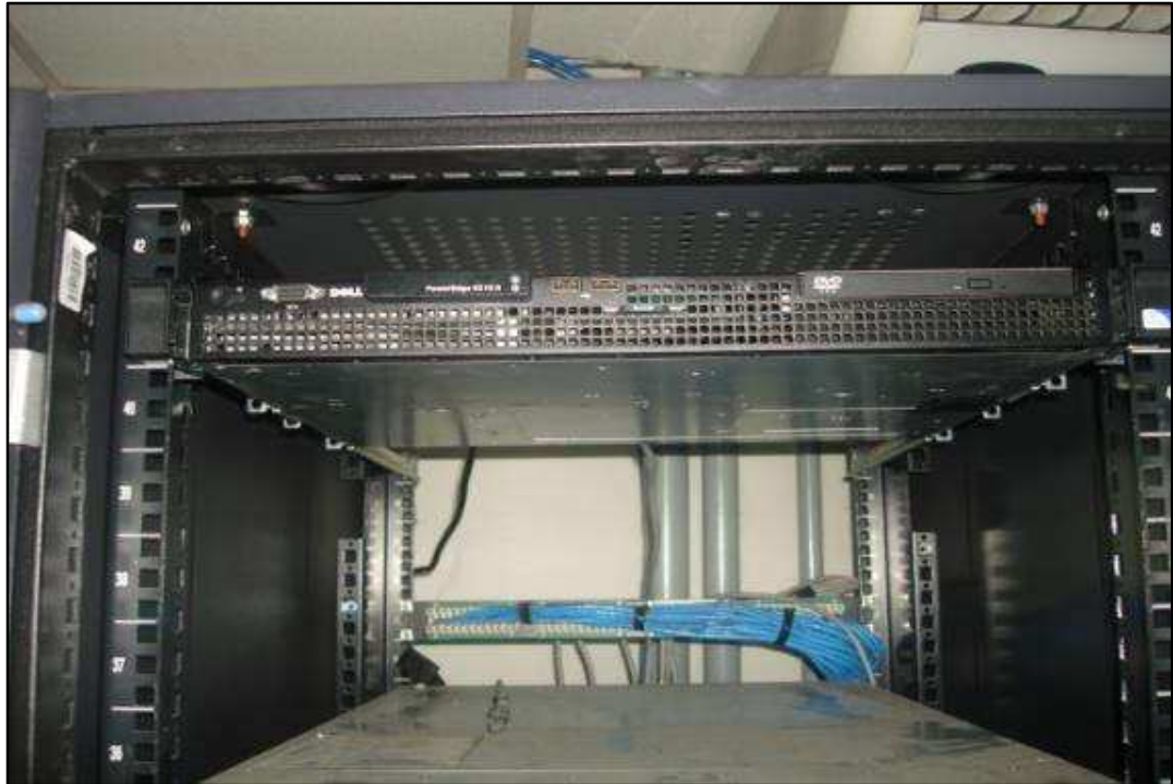
ITEM 1,362 - VISTA DO SERVIDOR DELL POWER EDGE R210
