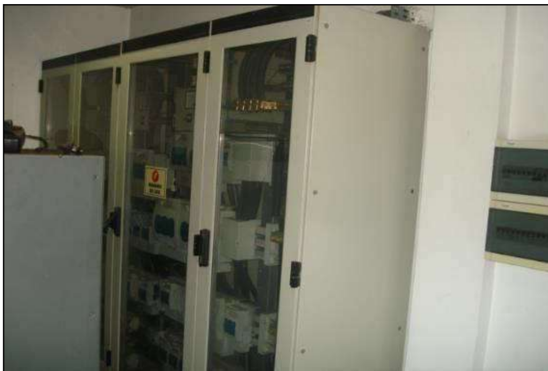
ITEM 1,801 - VISTA DO PAINEL ELETRÔNICO COM 4 PORTAS DE VIDRO COM BARRAMENTOS E DISJUNTORES
