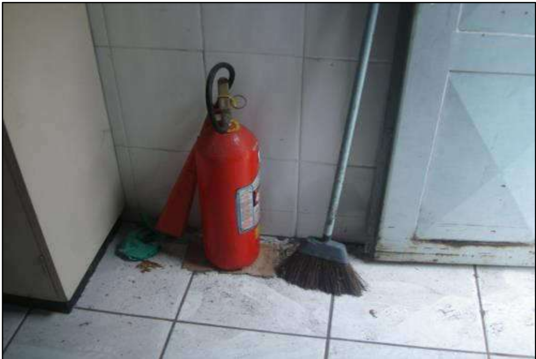
ITEM 1,622 - VISTA DO EXTINTOR
