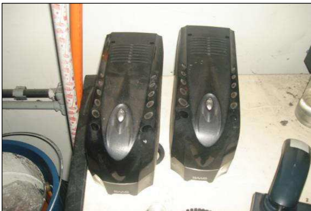
ITEM 1,347 - VISTA DO NO BREAK - MARCA SMS
