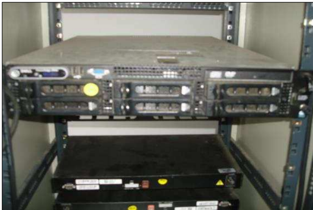
ITEM 0085 - VISTA DOS SERVIDORES MARCA: DELL MOD: POWER EDGE 2950 COM 6 HD SAS 164GB E UMA UNIDADE DVD ROM
