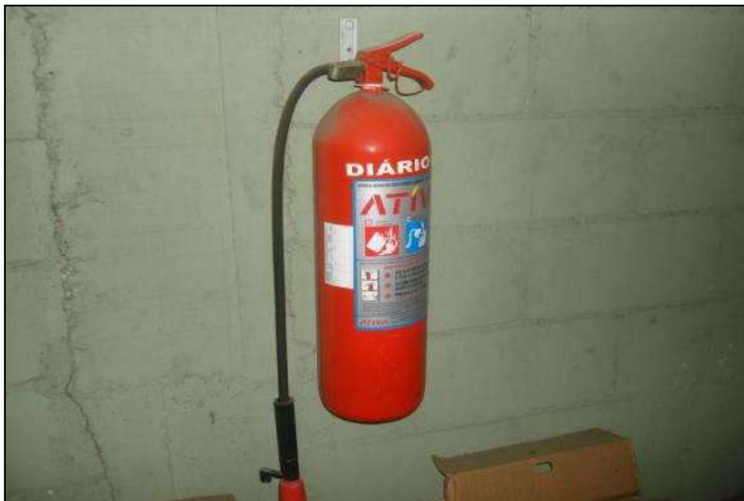
ITEM 1,675 - VISTA DO EXTINTOR
