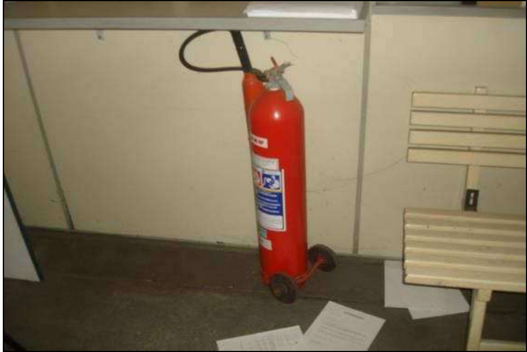
ITEM 1,501 - VISTA DO EXTINTOR DE INCÊNDIO
