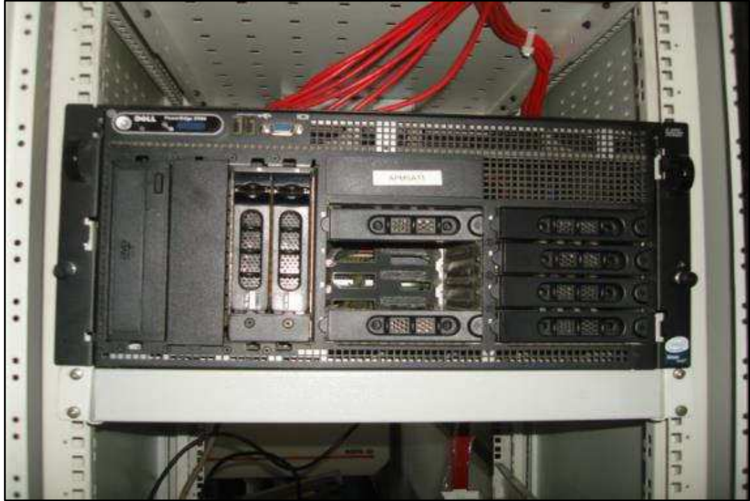
ITEM 0173 - VISTA DO SERVIDOR MARCA: DELL MOD: POWER EDGE 2900
