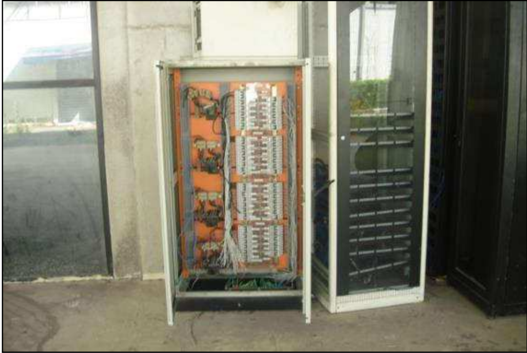
ITEM 1,821 - VISTA DO QUADRO DE FORÇA
