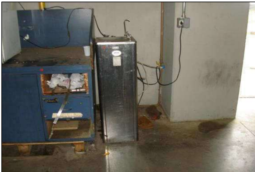
ITEM 2880 - VISTA DO BEBEDOURO DE AÇO MARCA: IBBL MOD: BAG40
