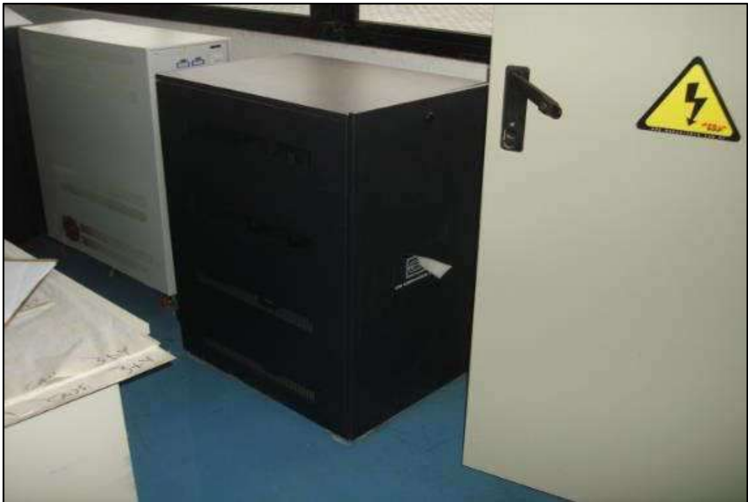
ITEM 0182 - VISTA DO MÓDULO DE BATERIA EXTERNO COM 16 BATERIAS
