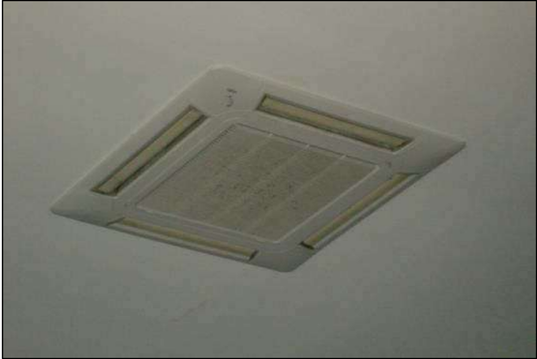
ITEM 0179 - VISTA DO AR CONDICIONADO MARCA: FUJITSU MOD: SPLIT INVERTER
