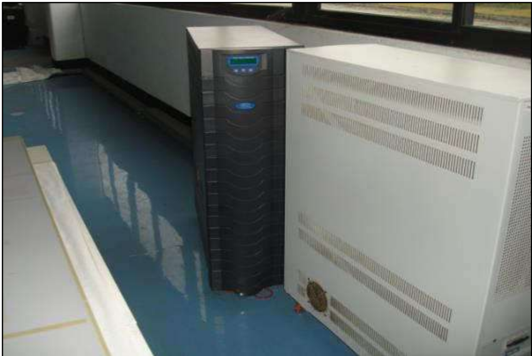
ITEM 0180 - VISTA DO NO BREAK MARCA: COMANDO LINEAR MOD: DOMINION SP 18000
