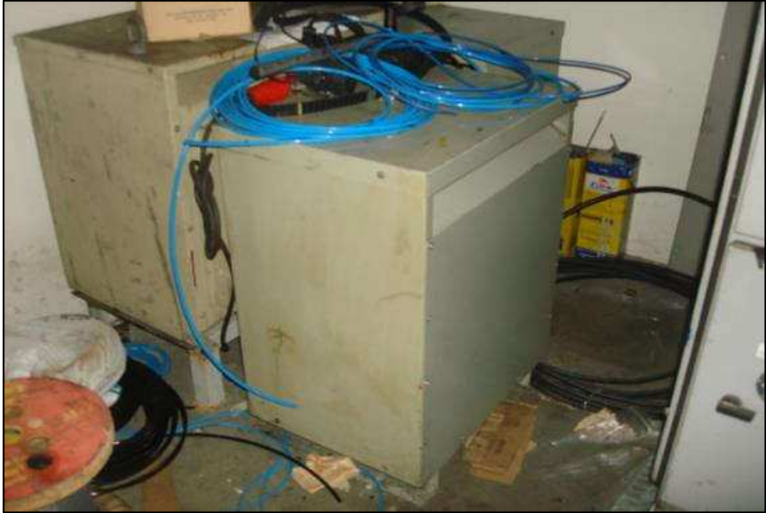
ITEM 2970 - VISTA DO TRANSFORMADOR MARCA: GE MOD: 20 KVA
