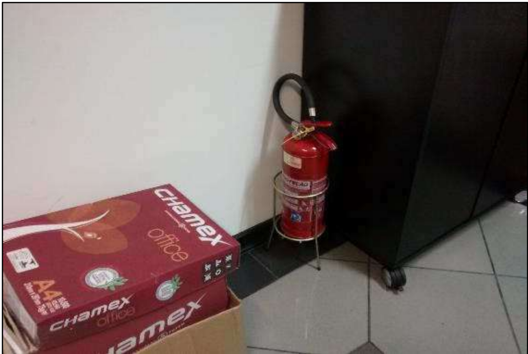
ITEM 1,209 - VISTA DO EXTINTOR DE INCÊNDIO
