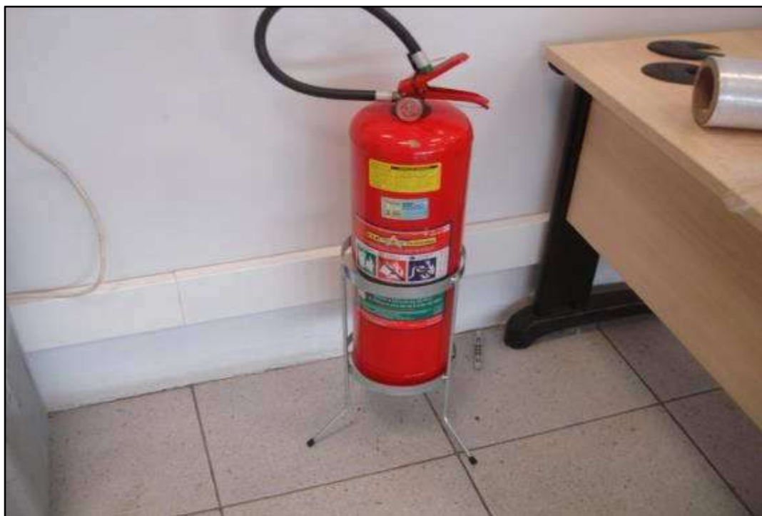
ITEM 0035 - VISTA DO EXTINTOR COM SUPORTE MARCA: CLP MOD: ÁGUA DIM: 10L
