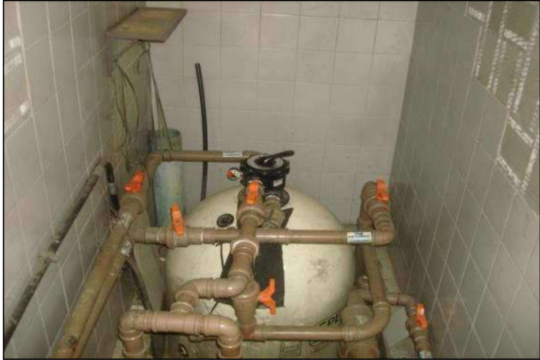
ITEM 1,879 - VISTA DA BOMBA DE PISCINA EPEX
