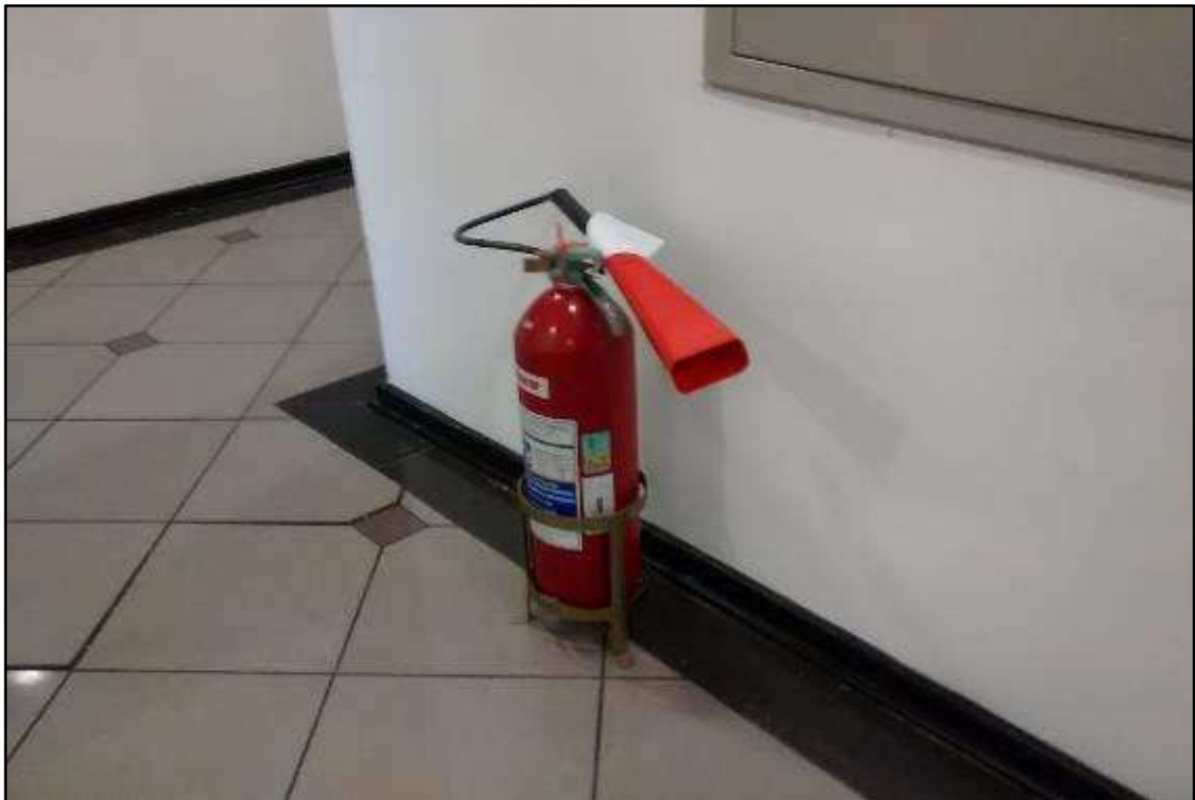
ITEM 1,199 - VISTA DO EXTINTOR DE INCÊNDIO
