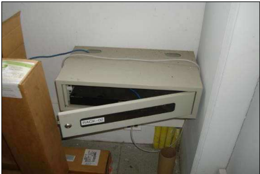
ITEM 0145 - VISTA DO RACK SWITCH DIM: 30X50X15 CM
