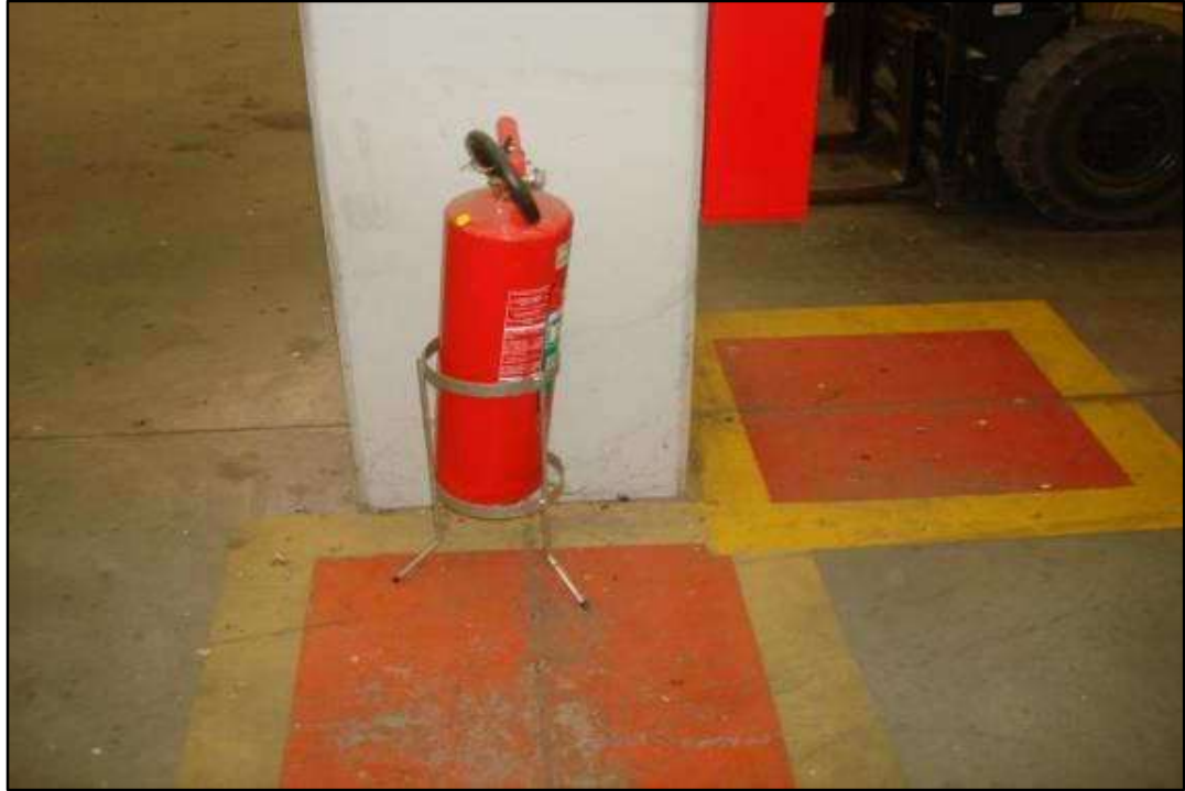
ITEM 2939 - VISTA DOS EXTINTORES (DIVERSOS)
