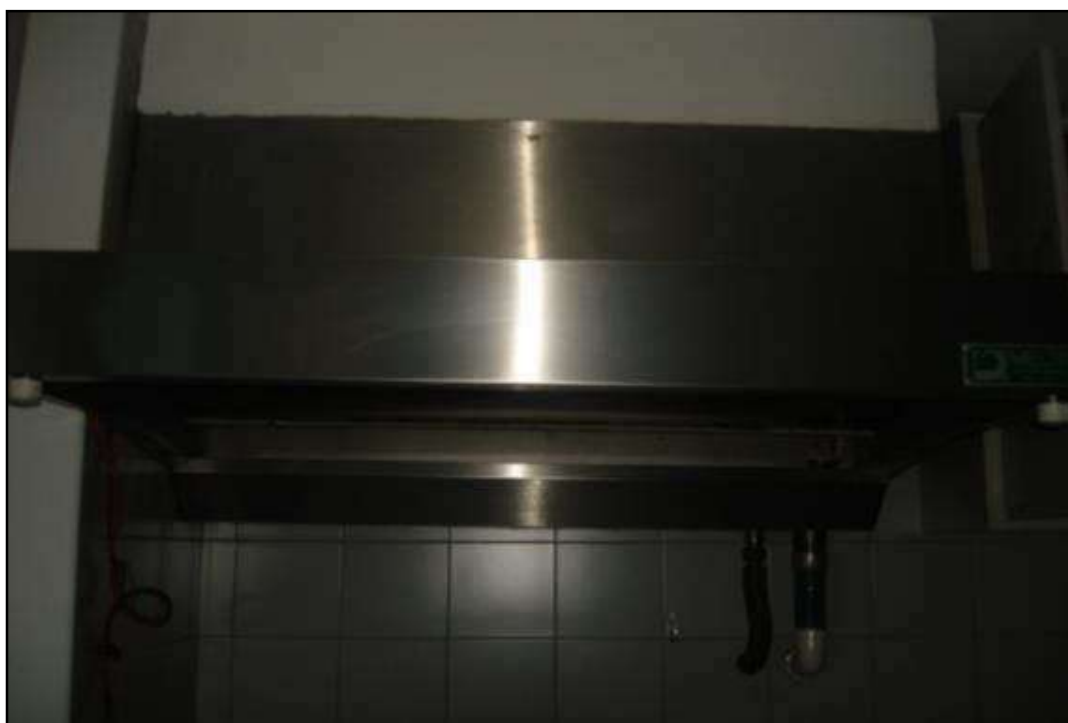
ITEM 1,766 - VISTA DO EXAUSTOR DE ALUMÍNIO MELTING
