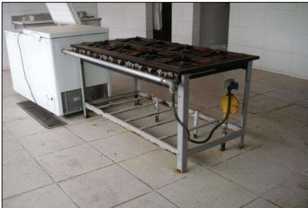
ITEM 0191 - VISTA DO FOGÃO INDUSTRIAL COM 8 BOCAS
