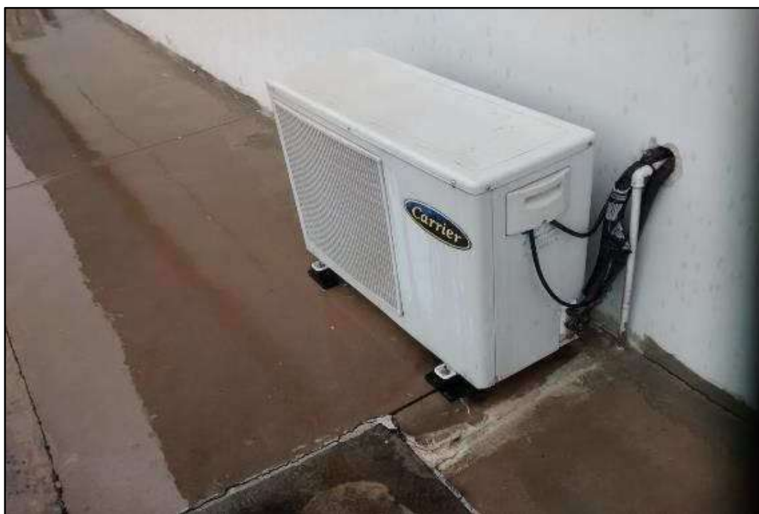
ITEM 2997 - VISTA DO CONDENSADOR DE AR MARCA: CARRIER MOD: 36000 BTU
