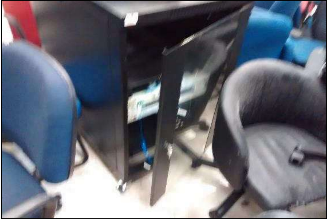
ITEM 1,065 - VISTA DO RACK SERVIDOR BAIXO HEPSO
