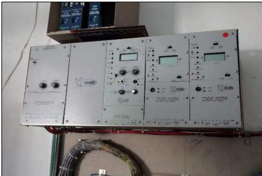
ITEM 1,415 - VISTA DA UNIDADE SUPERVISÃO DISTRIBUIÇÃO PROTECO BMLBM 2650005FMP48
