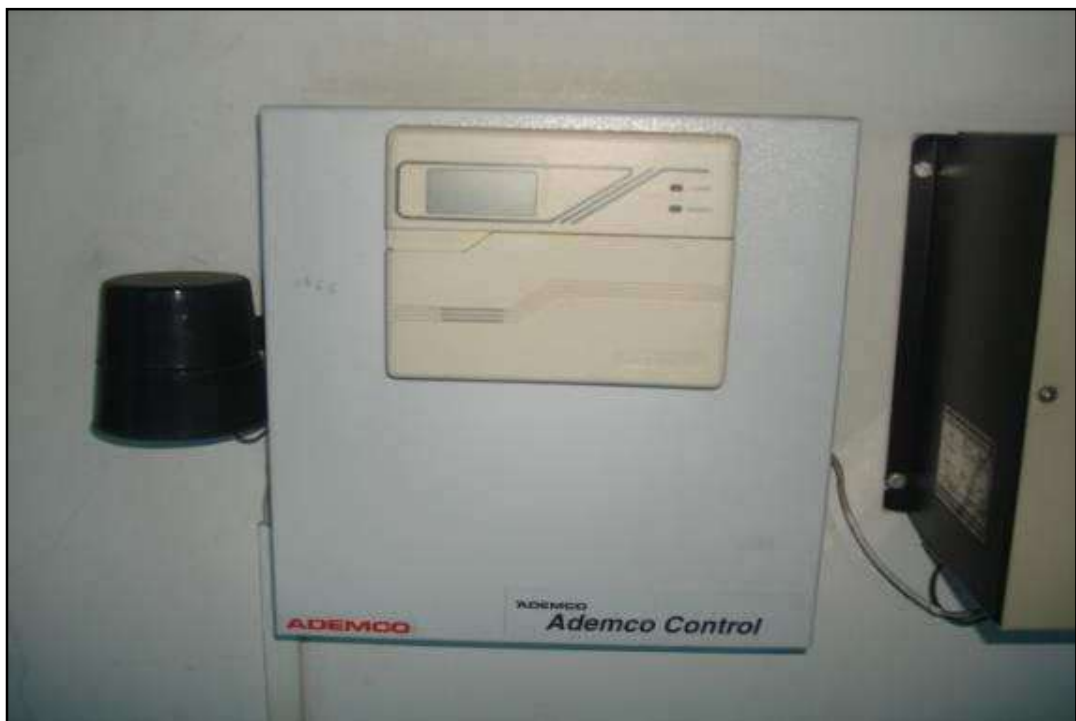
ITEM 1,803 - VISTA DO ADEMCO CONTROL
