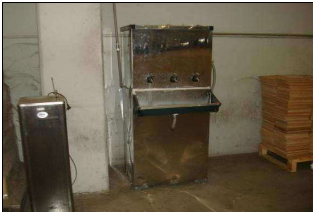
ITEM 2892 - VISTA DO BEBEDOURO DE INOX COM TRES TORNEIRAS
