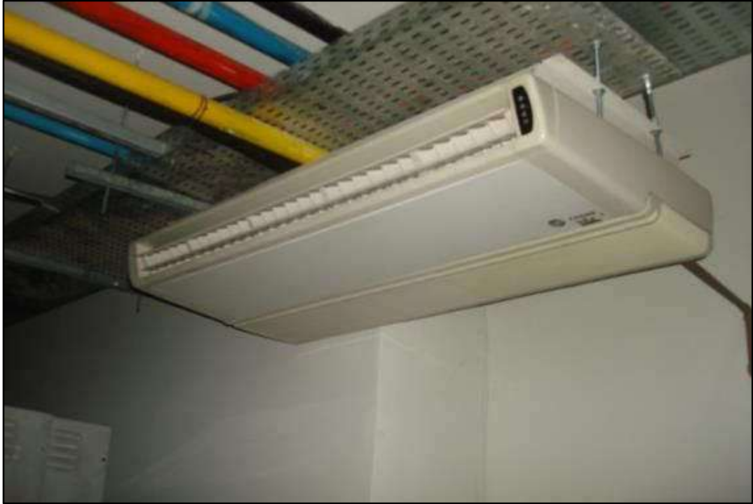
ITEM 2966 - VISTA DO AR CONDICIONADO MARCA: TRANE
