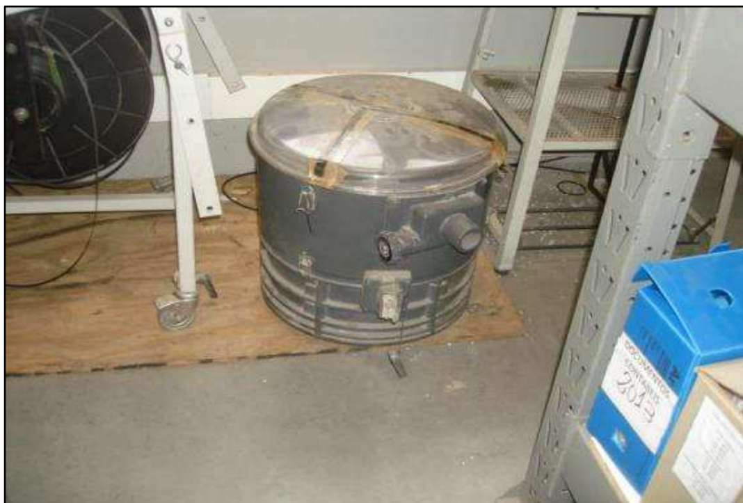
ITEM 0931 - VISTA DO ASPIRADOR MARCA: RIETSCHLE THOMAS CEVF 3718-3
