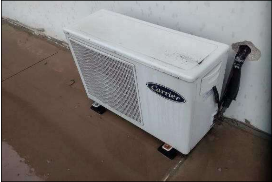
ITEM 2998 - VISTA DO CONDENSADOR DE AR MARCA: CARRIER MOD: 24000 BTU
