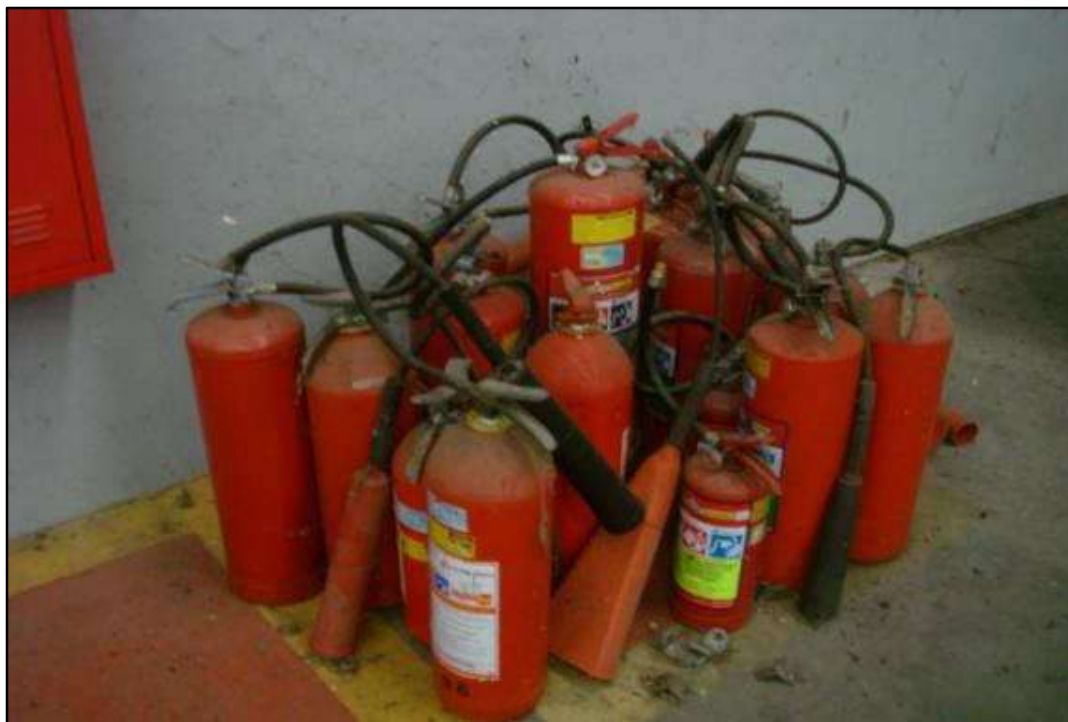
ITEM 2941 - VISTA DOS EXTINTORES MARCA: EXTRA CHAMA
