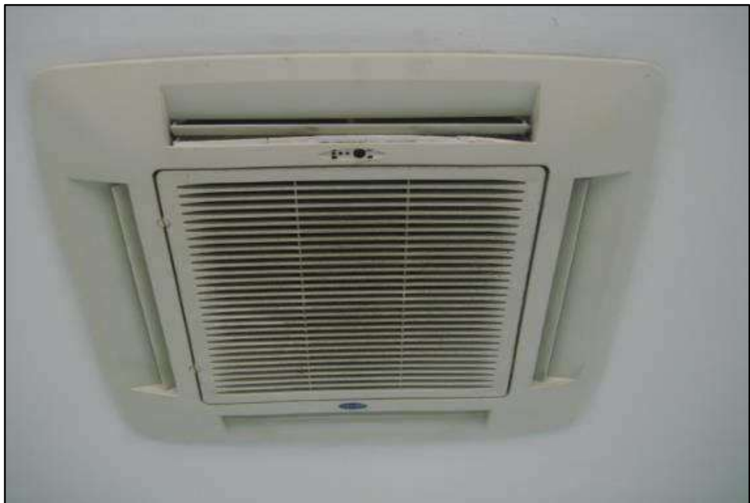
ITEM 1,306 - VISTA DO AR CONDICIONADO
