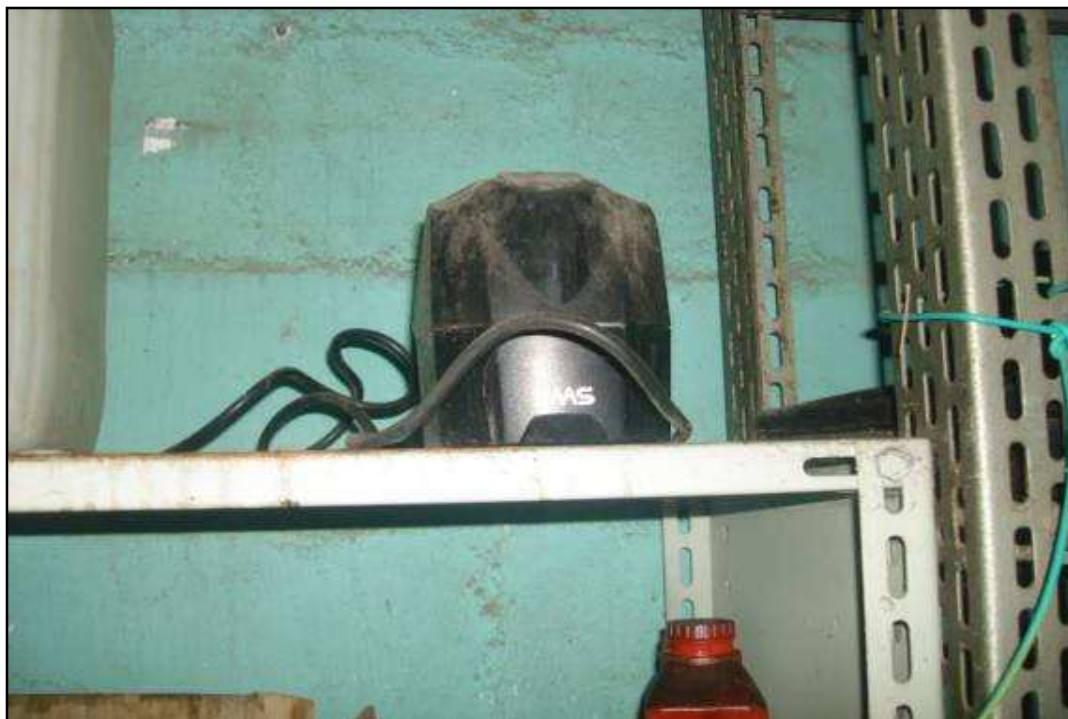
ITEM 1,845 - VISTA DO ESTABILIZADOR SMS
