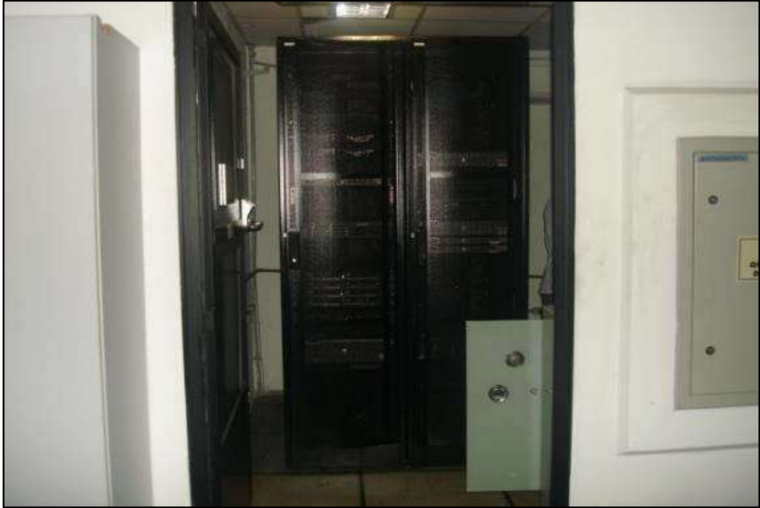
ITEM 1,339 - VISTA DO RACK PARA SERVIDOR
