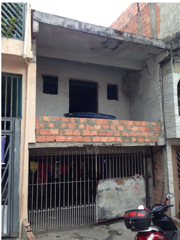
FOTO 01: Fachada do Imóvel sem acabamento e sem cobertura.
