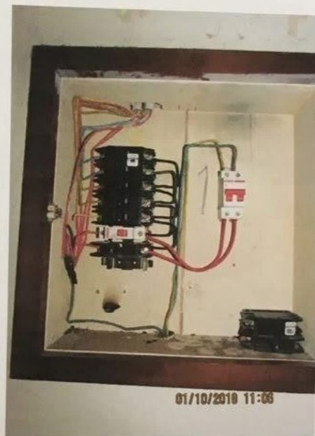
Vista do Quadro Geral de Distribuição de Energia
