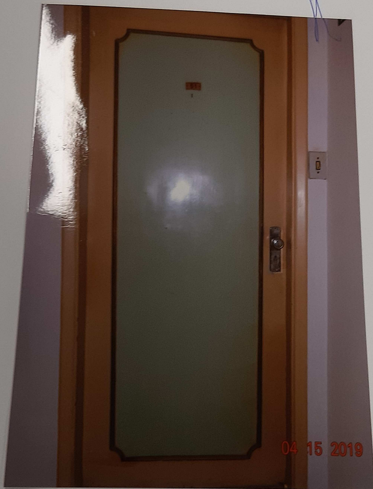
VISTA DA PORTA DE ACESSO SOCIAL DO APARTAMENTO DE Nº 51 DO "EDIFÍCIO GISELE", INTEGRANTE DO "CONDOMÍNIO JARDIM EDELE ZARZUR".
