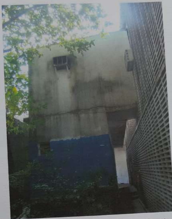
Foto 11: Detalhe da construção da antiga portaria, utilizada atualmente para área administrativa. O acesso ao andar superior é pelo 1º pavimento do prédio administrativo. Observam-se rachaduras e revestimento desagregado.
