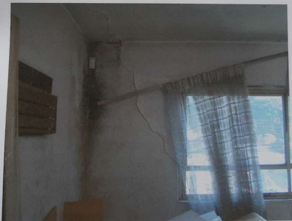
Foto 16: Detalhe da fotografia anterior, destacando rachaduras e manchas de umidade com bolor.
