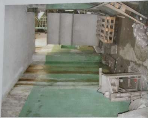
Foto 51: Outra vista parcial da edícula, aos fundos do imóvel, destacando revestimentos desagregados e manchas de umidade.
