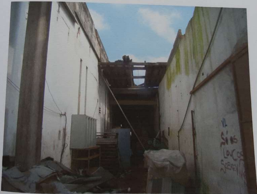
Foto 07: Outra vista do terreno do Embargante, em direção à rua, observando danos na cobertura e ruína de parte da mesma.
