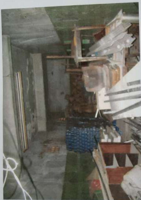
Foto 53: Outra vista parcial da edícula, aos fundos do imóvel, destacando revestimentos desagregados e manchas de umidade.
