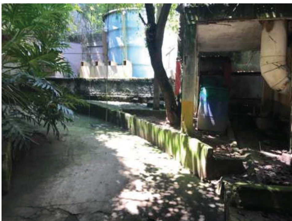
Foto 16 - Calçamento junto aos fundos do galpão principal - acesso aos reservatórios de água, zeladoria e área reservada.
