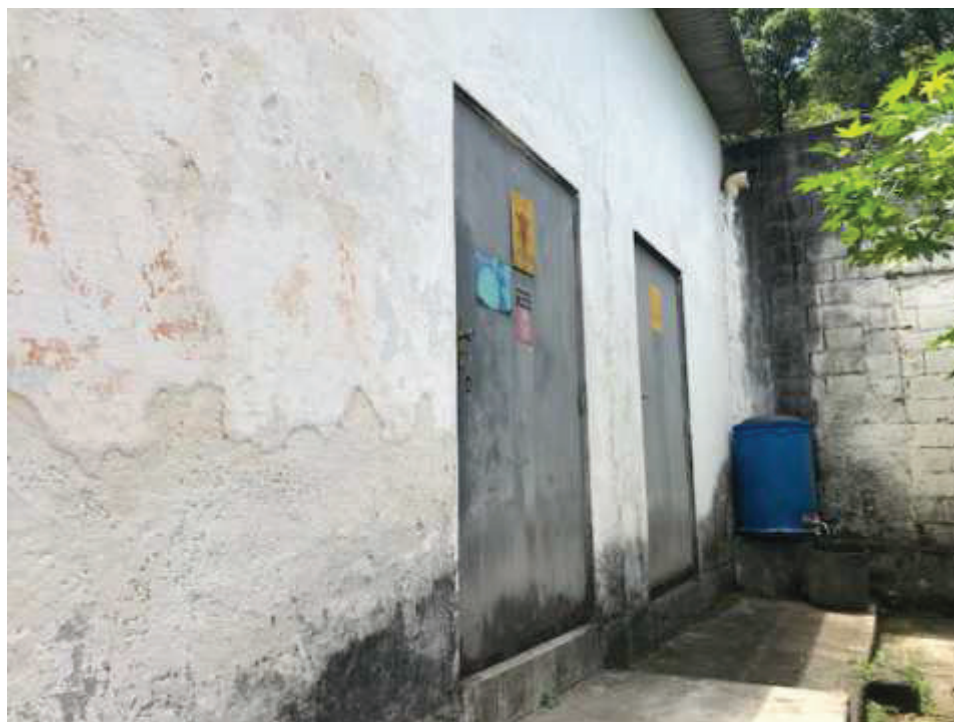
Foto 20 - Cabine Primária, junto ao alinhamento predial, com acesso interno.
