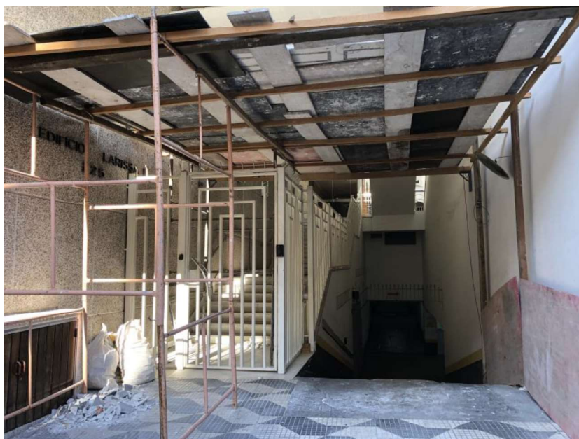
Imagem 3 - Vista da entrada de veículos da Rua das Palmeiras para a garagem dos edifícios Larissa I e Larissa II, onde se localizava o estacionamento da executada AWS Park e as 03 (três) vagas em avaliação.
