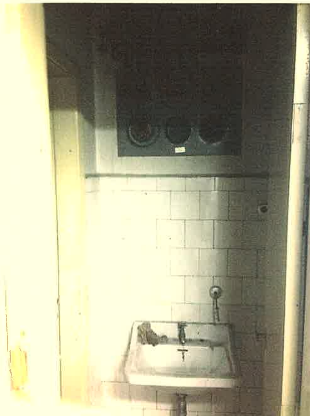
VISTA DO LAVABO (NOTANDO OS CABOS NA PAREDE).
