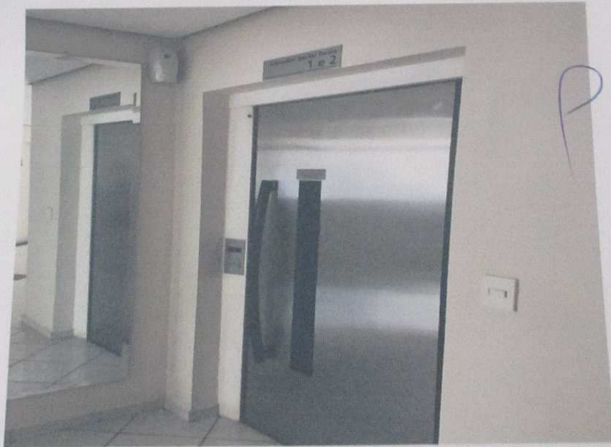
Demonstração geral do elevador de acesso ao apartamento vistoriado no pavimento térreo.
