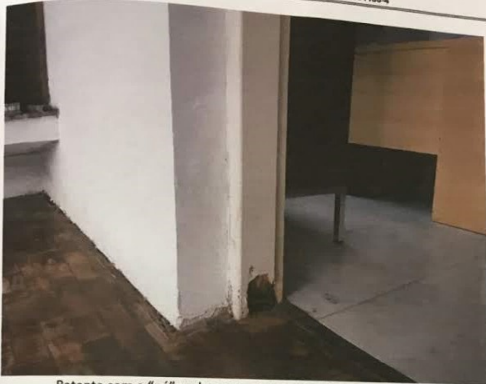
Batente com o "pé" podre na passagem da sala para o escritório.
