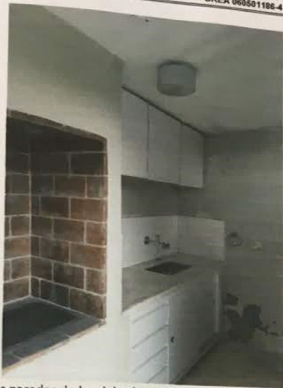
As paredes do local da churrasqueira apresentam-se com sinais de infiltração e descascadas.
