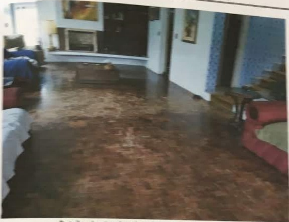
Detalhe do piso da sala. Há necessidade raspagem e aplicação de novo "sinteco" ou produto similar.
