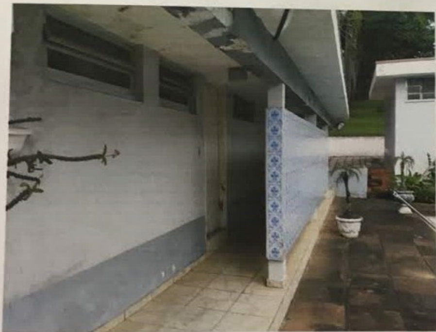
Acesso à sauna e vestiários: paredes e viga com sinais de infiltração de água, pintura descascando.
