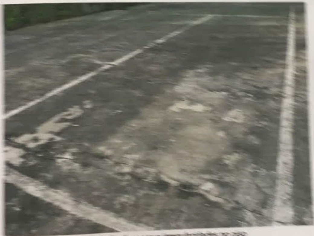
Detalhes das buracos e irregularidades no piso.
