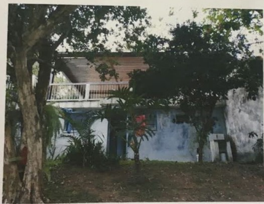
Vista externa da casa do caseiro – necessita pintura.
