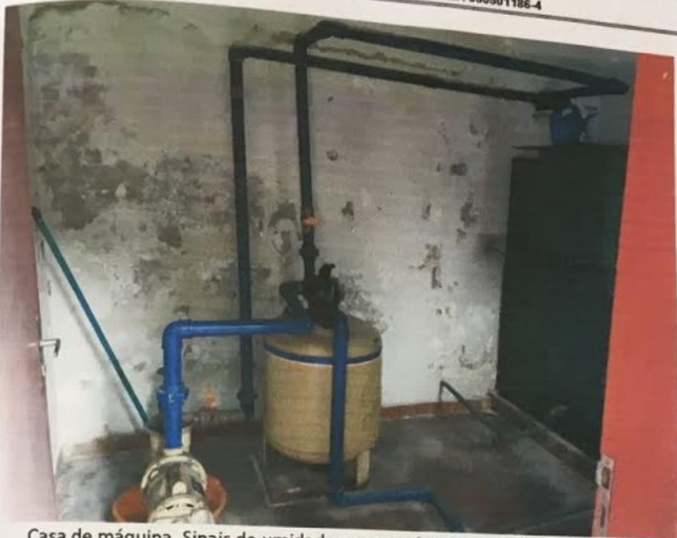
Casa de máquina. Sinais de umidade nas paredes e necessidade de pintura.
