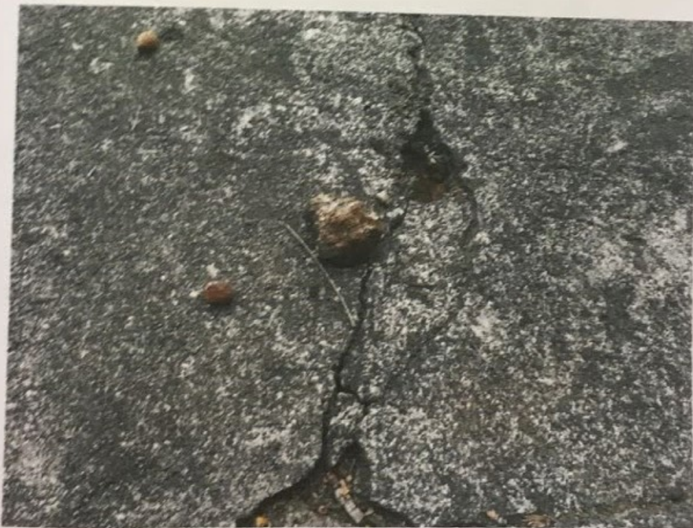
Rachadura no piso da quadra de tênis, o cimentado está quebrado e se soltado.
