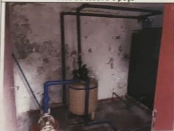
Casa de máquinas
