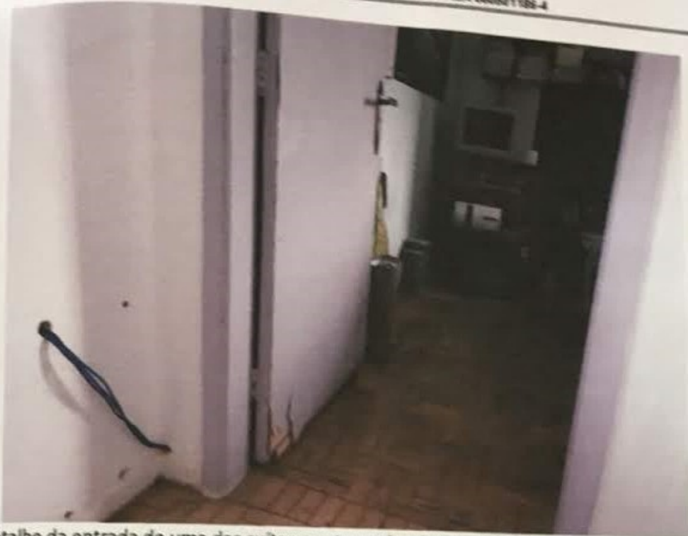
Detalhe da entrada de uma das suítes; porta quebrada e instalação de lógica inadequada.
