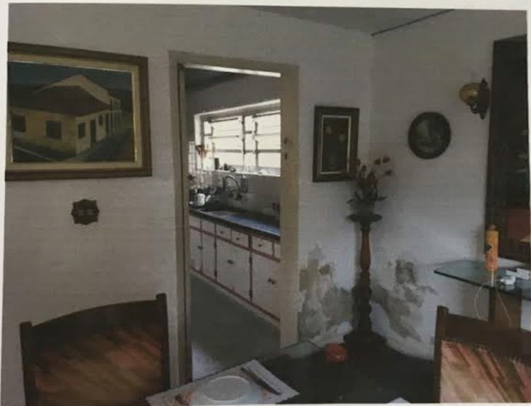
Parede da sala de jantar com sinais de infiltração.
