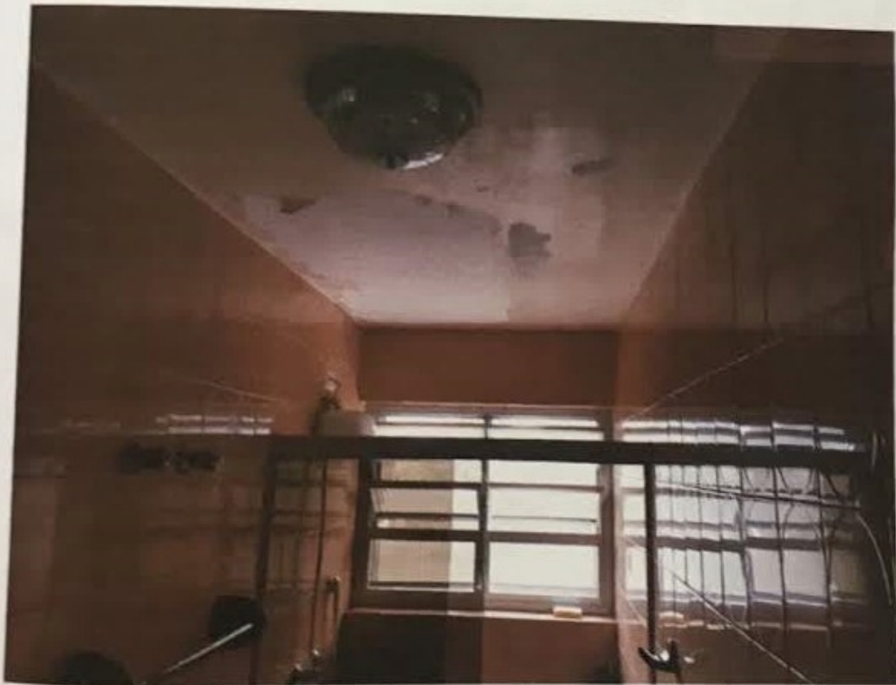
Pintura se soltando no teto de um dos banheiros do pavimento superior
