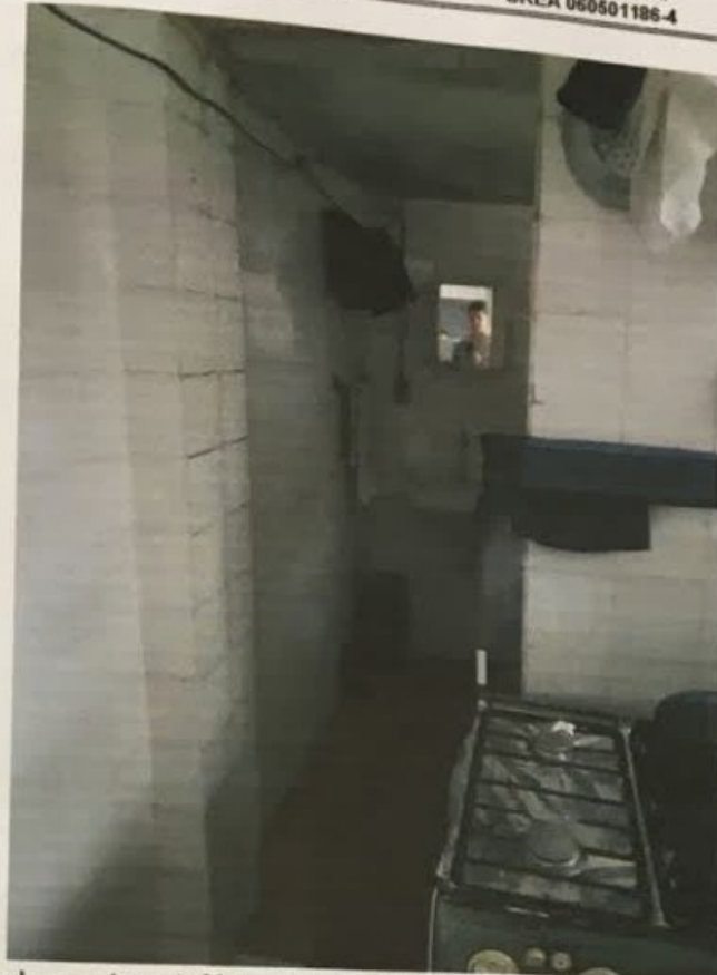
Casa do caseiro – infiltrações no teto e instalação elétrica precária
