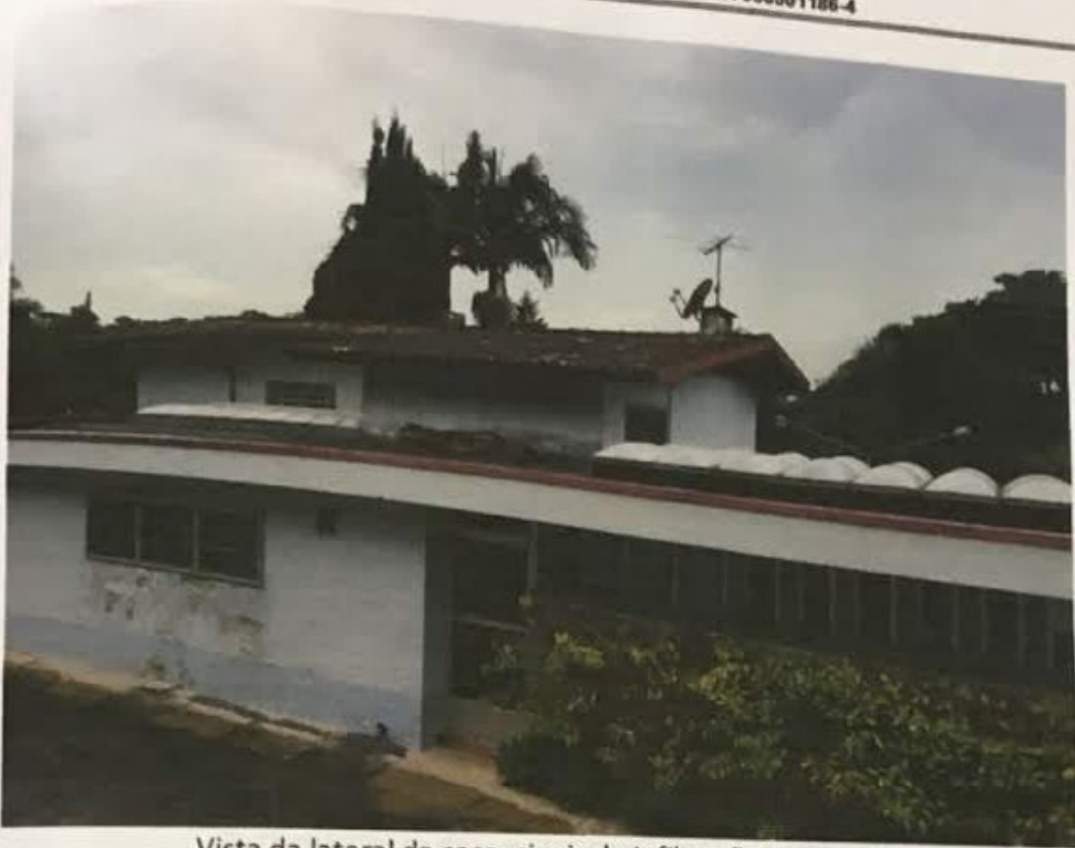
Vista da lateral da casa, sinais de infiltração na parede externa e necessidade de pintura externa visível.
