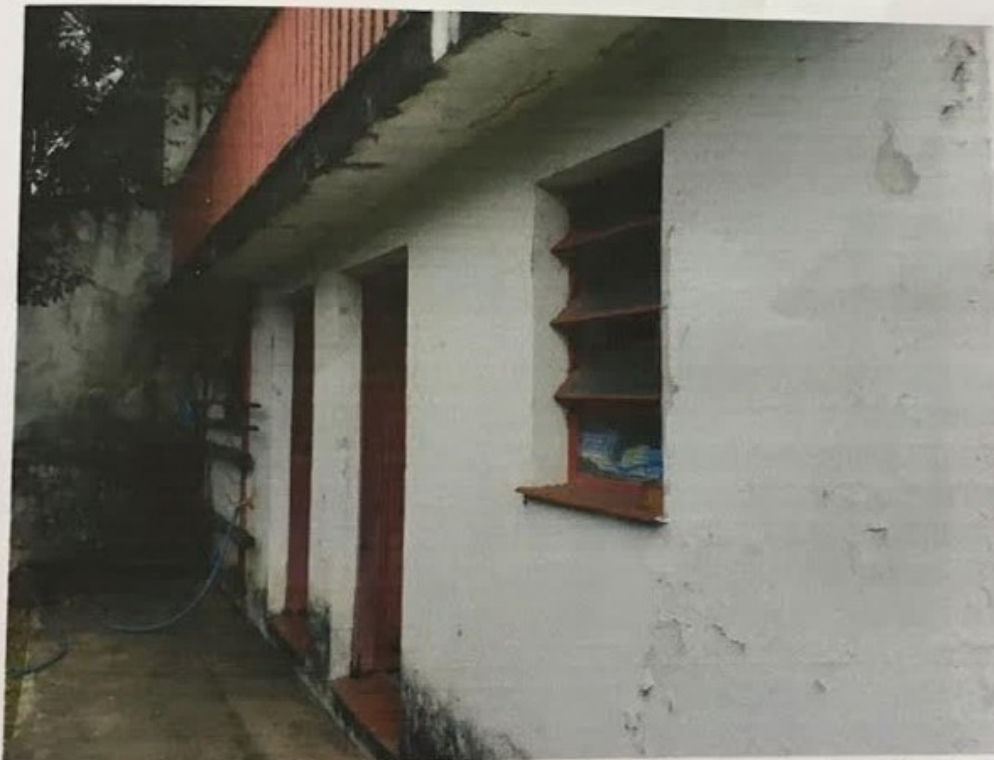
Vista externa da casa de máquinas e quarto de ferramentas. Necessita pintura.
