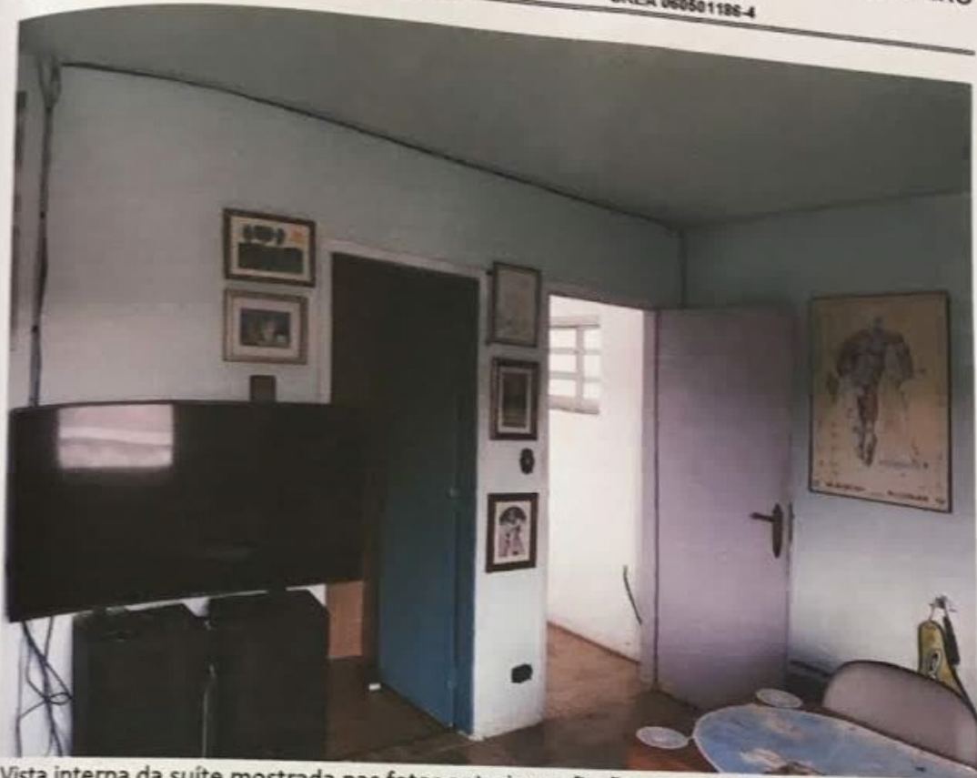
Vista interna da suíte mostrada nas fotos anteriores; fiação exposta de maneira inadequada.
