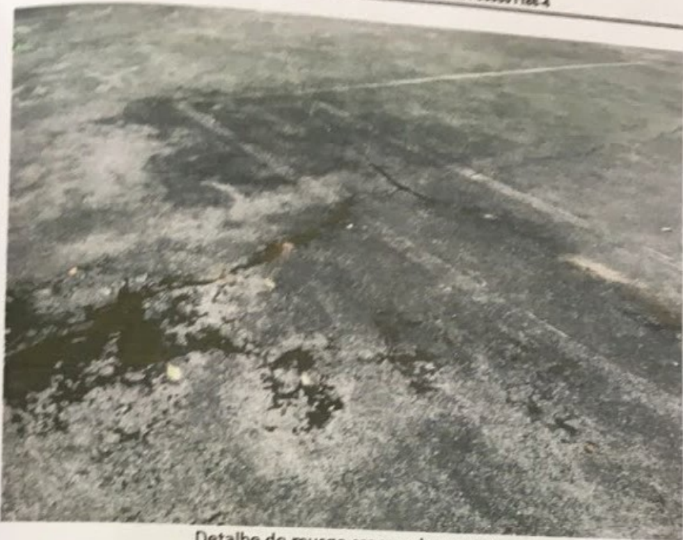
Detalhe do musgo crescendo no piso
